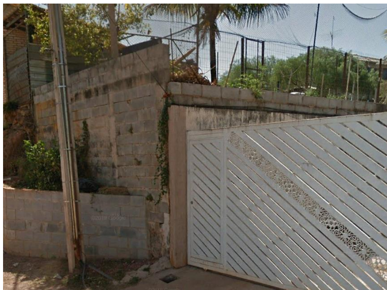
Figura 123 - Muro de divisão de lotes sustentando provável aterro.
