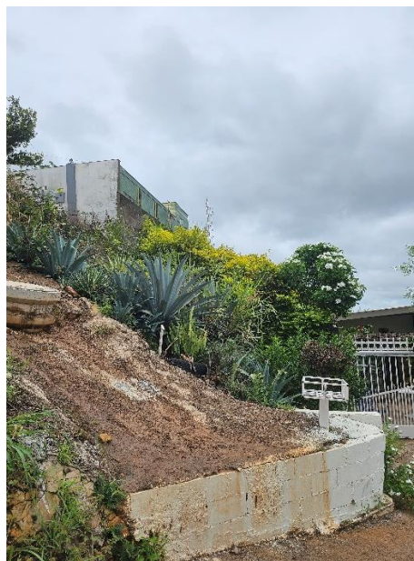
Figura 40 - Aspecto da encosta 04 em área ocupada.
