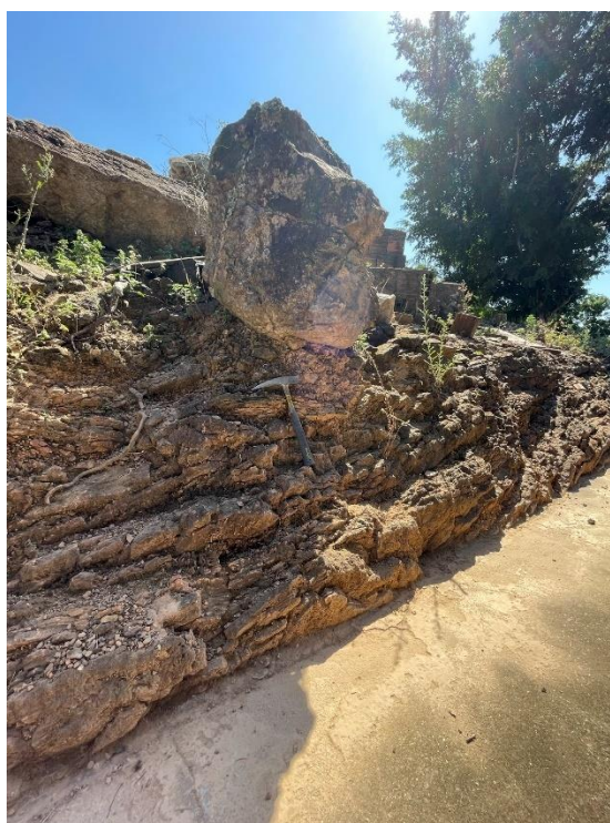
Figura 119 – Bloco de rocha com risco de queda.
