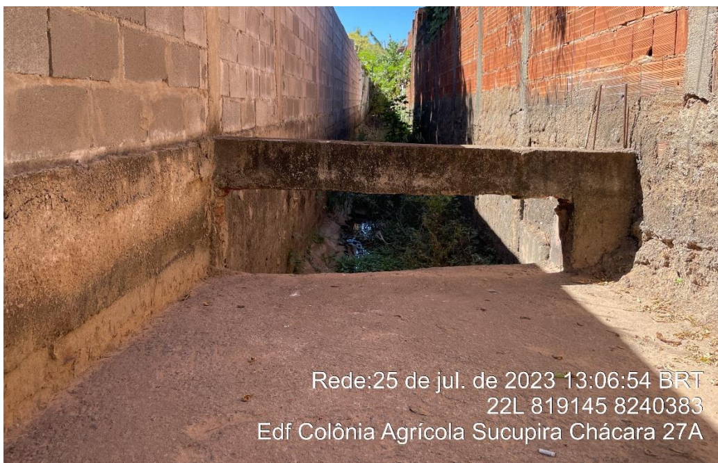
Figura 42. Passagem de águas pluviais, com a presença de efluentes residenciais.
