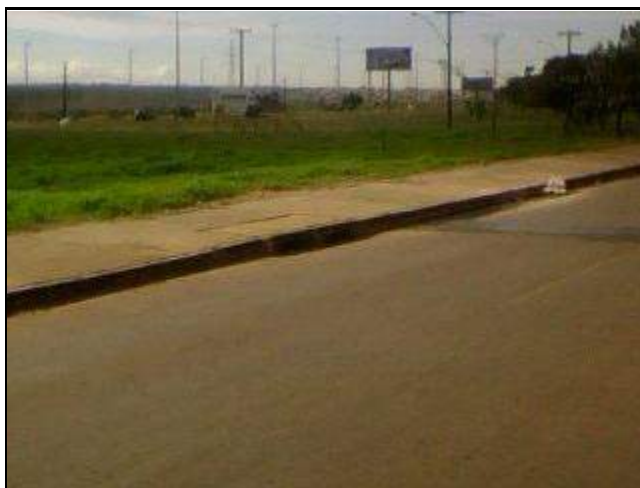
Foto 3 - Existência de Drenagem no Contorno da Área de Estudo (Extrema Construções LTDA)
