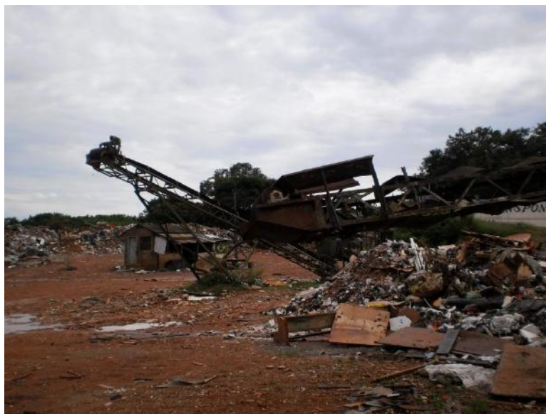
Figura 142 – Sucatas da esteira que constituía a Central de Processamento de Entulhos.
