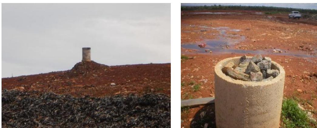
Figura 144 – Dutos de gases.
