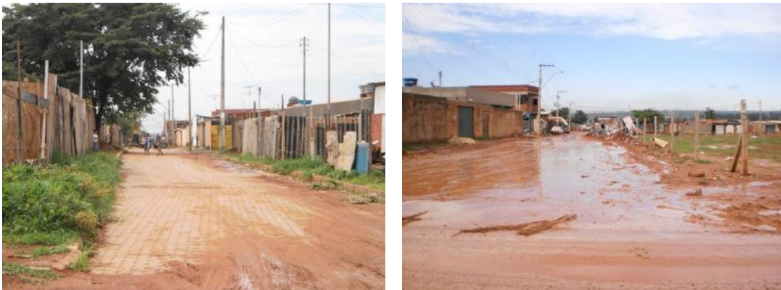
Figura 133 – Situação da pavimentação asfáltica presente.
