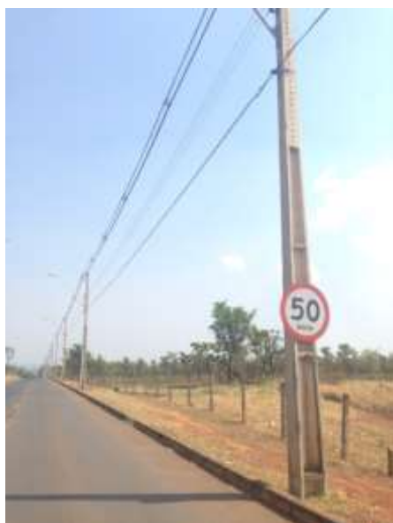
Rede elétrica ao longo da via HI-104
