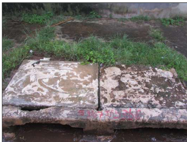
Foto 70: Equipamento de Drenagem Pluvial.
