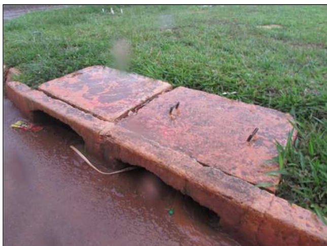
Foto 69: Equipamento de Drenagem Pluvial.
