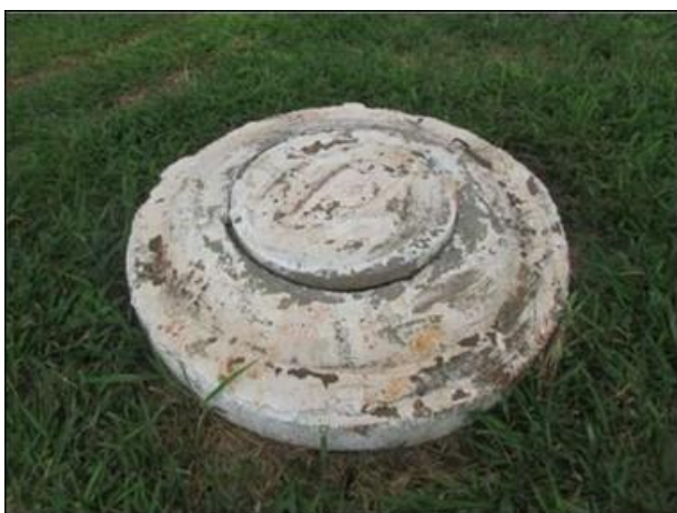
Foto 168 - Ponto de Verificação (CAESB).
