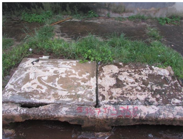
Foto 86 - Equipamento de Drenagem Pluvial. UTM: 180244/8226801
