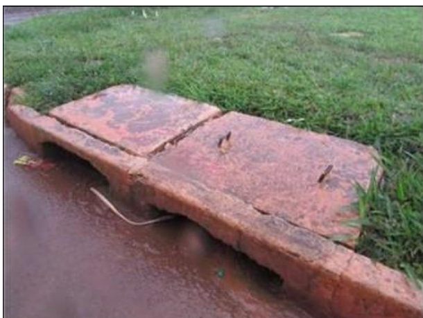
Foto 166 - Equipamento de Drenagem Pluvial.
