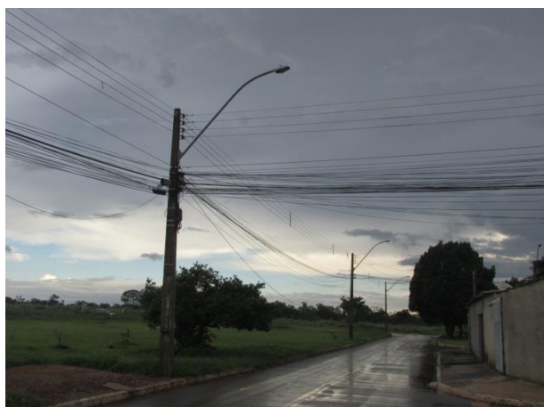
Foto 89 - Rede Elétrica. UTM: 179808/8226674
