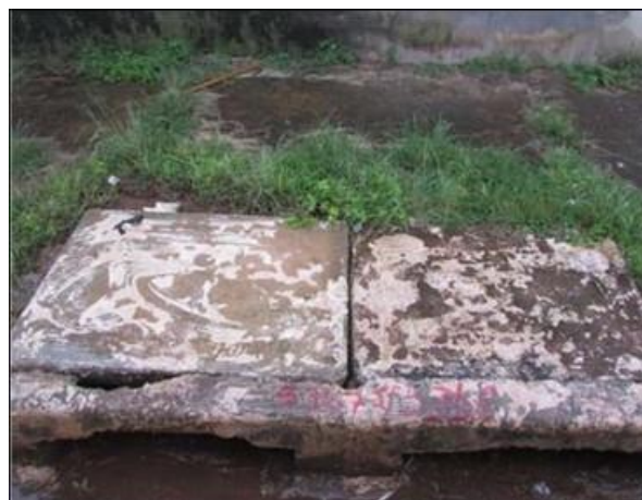
Foto 167 - Equipamento de Drenagem Pluvial.
