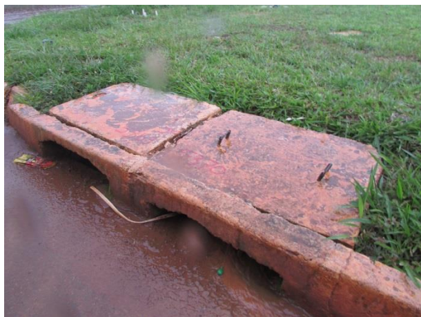
Foto 85 - Equipamento de Drenagem Pluvial. UTM: 180276/8226743
