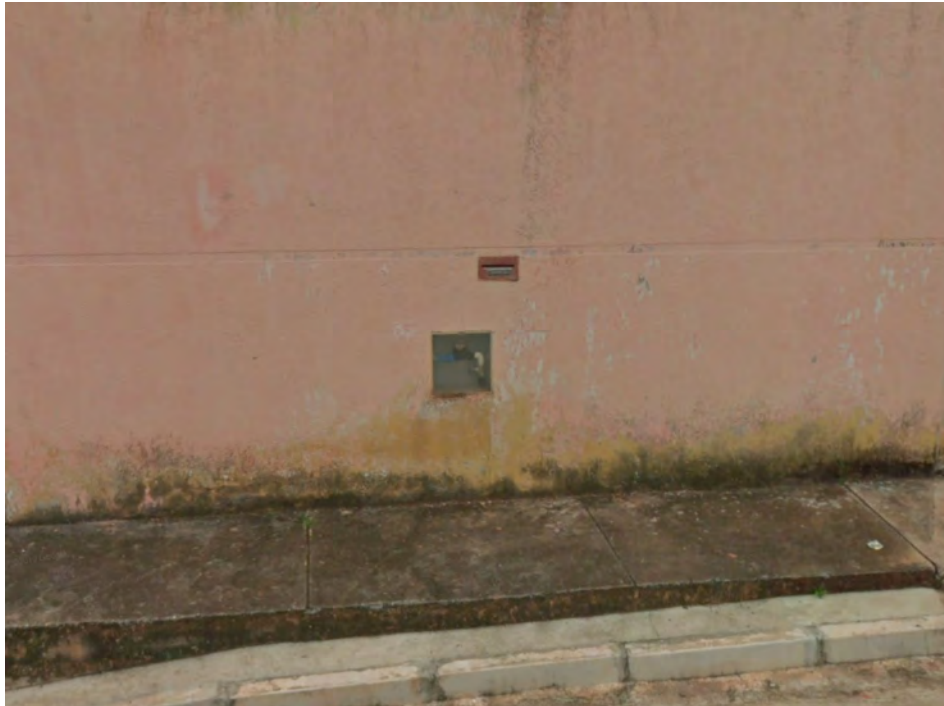
Figura 62 - Hidrômetro da CAESB instalado em rua adjacente ao parcelamento.
