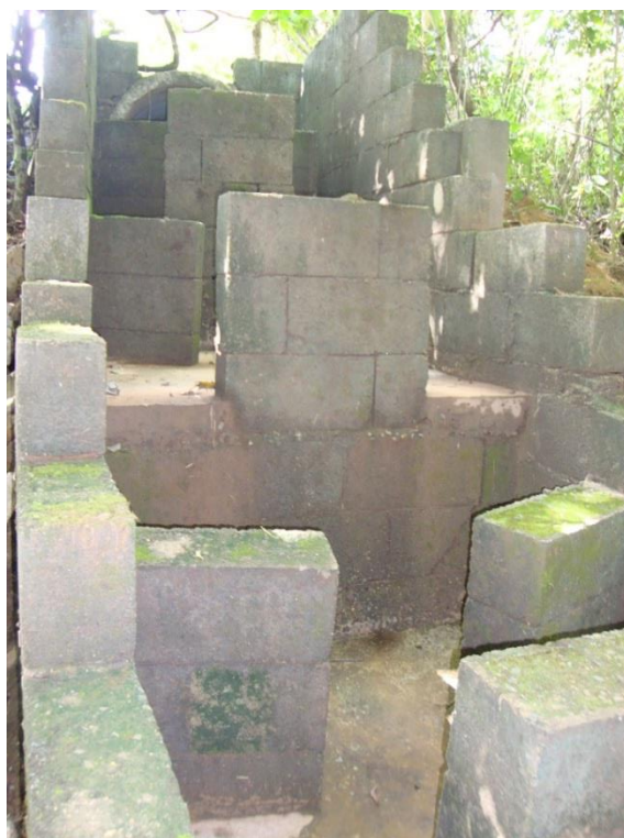
Figura 11. Sistema de dissipação de energia do ponto de lançamento das águas pluviais instalado no Conjunto 04.
