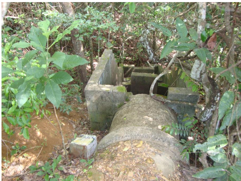
Figura 10. Ponto de lançamento das águas pluviais instalado no Conjunto 04.
