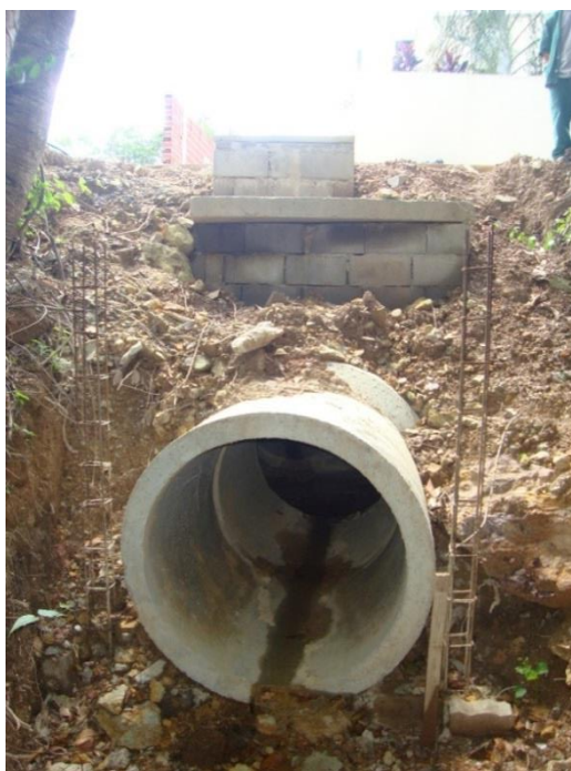
Figura 14. Ponto de lançamento das águas pluviais coletadas nos Conjuntos 16 e 17.
