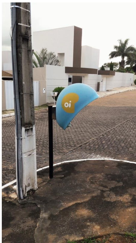
Figura 28. Rede pública de telefonia operada pela Oi.
