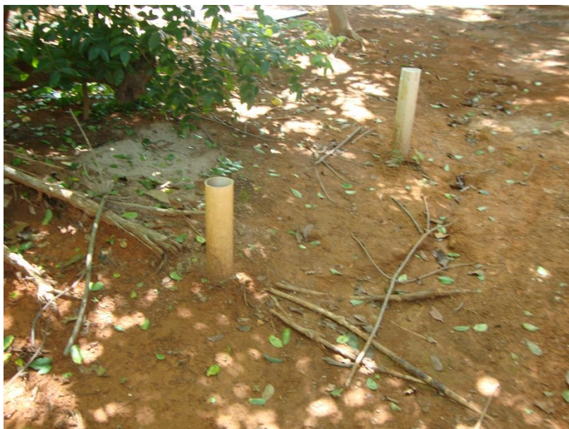
Figura 18. Suspiros da Ecofossa já instalado no ponto de apoio.
