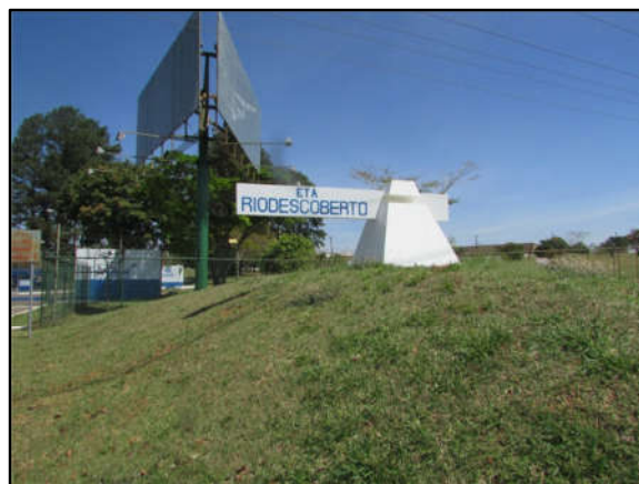
Foto 22: Estação de Tratamento de Água.
