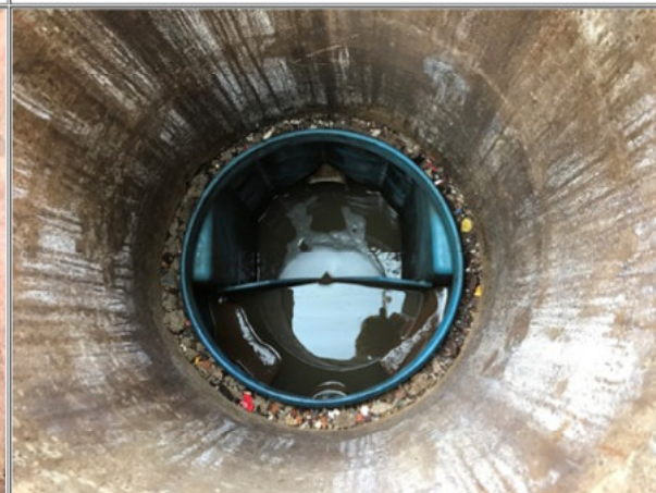
Foto 18. Caixa de amostragem da lavagem de veículos.
