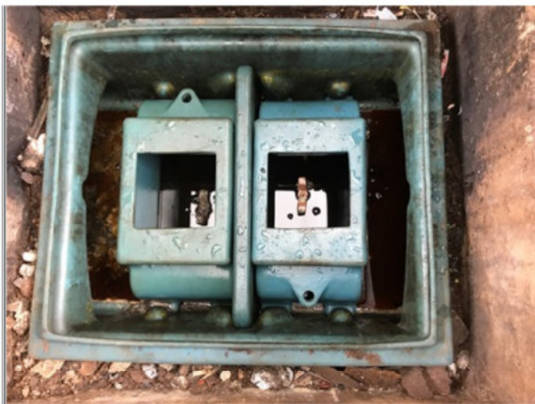
Foto 15. Caixa separadora de água e óleo da pista/descarga/lubrificação.
