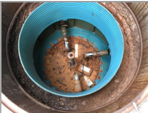
Foto 06. Câmara de contenção no acesso à boca de visita.
