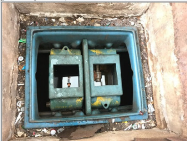
Foto 17. Caixa separadora de água e óleo da lavagem de veículos.
