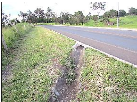
Foto 2.100: Drenagem pluvial na DF-005.
