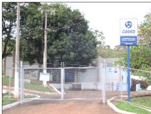
Foto 2.104: Estação Elevatório do Lago Norte 1.
