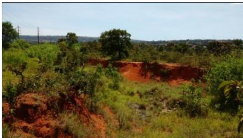
Foto 2.22: Erosão situada na área próxima a estrada.
