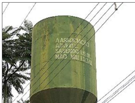
Foto 2.103: Abastecimento comunitário de água no Núcleo Rural do Jerivá.
