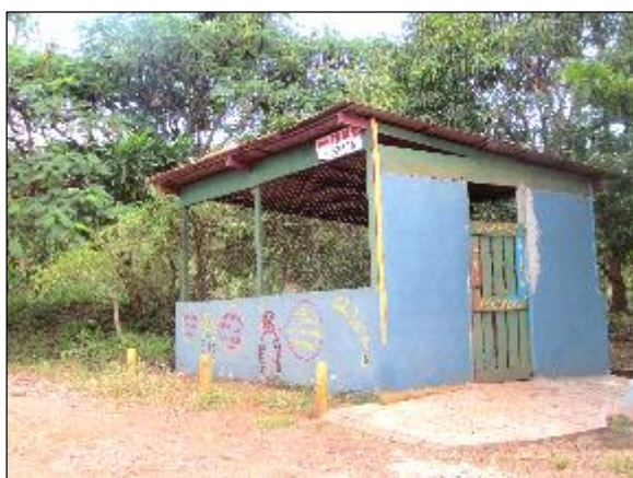
Foto 2.109: Armazenamento temporário de resíduos no Jerivá.
