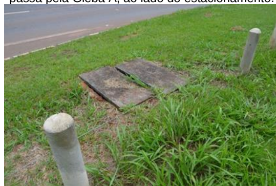
164. Caixa de inspeção da rede elétrica da CEB, ao lado da Gleba A, na Via L4 Sul.
