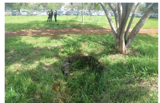
157. Manilha de águas pluviais sob a via da Gleba A, obstruída por vegetação.
