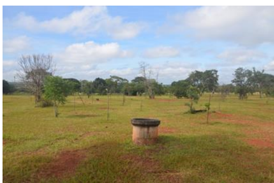
166. Poço de visita da rede de águas pluviais que passa pela Gleba C.
