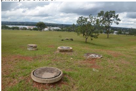
168. Conjunto de caixas de passagem e poços de visita de redes provenientes do SES, na Gleba C.
