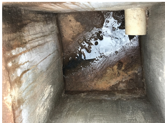
Foto 7. Caixa de inspeção, com indícios de efluentes oleosos.
