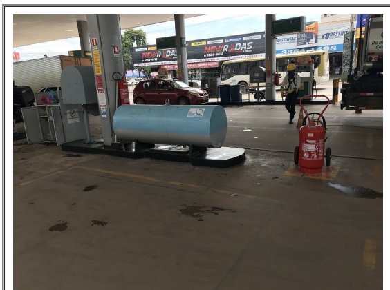
Foto 6. Tanque de OLUC na área de abastecimento.
