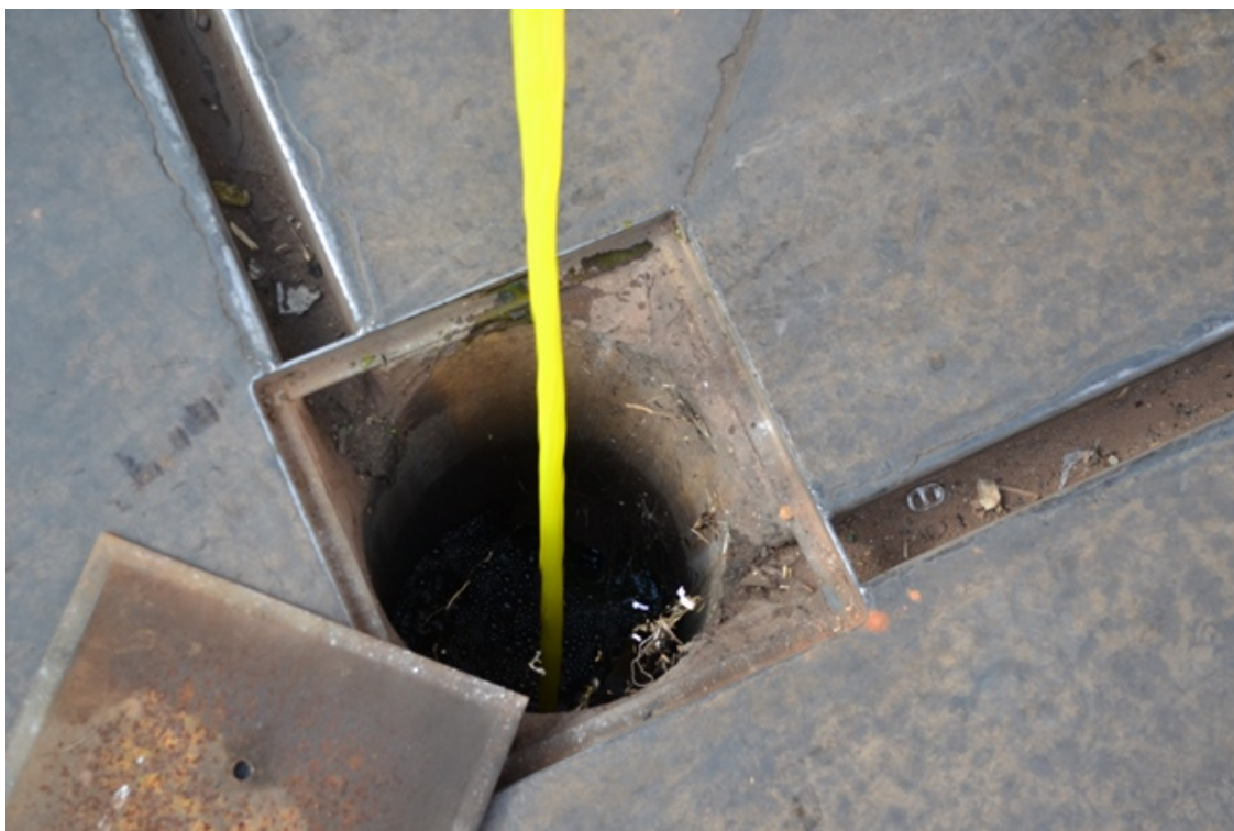
Figura 12: Caixa de passagem dos canaletos de águas pluviais.
