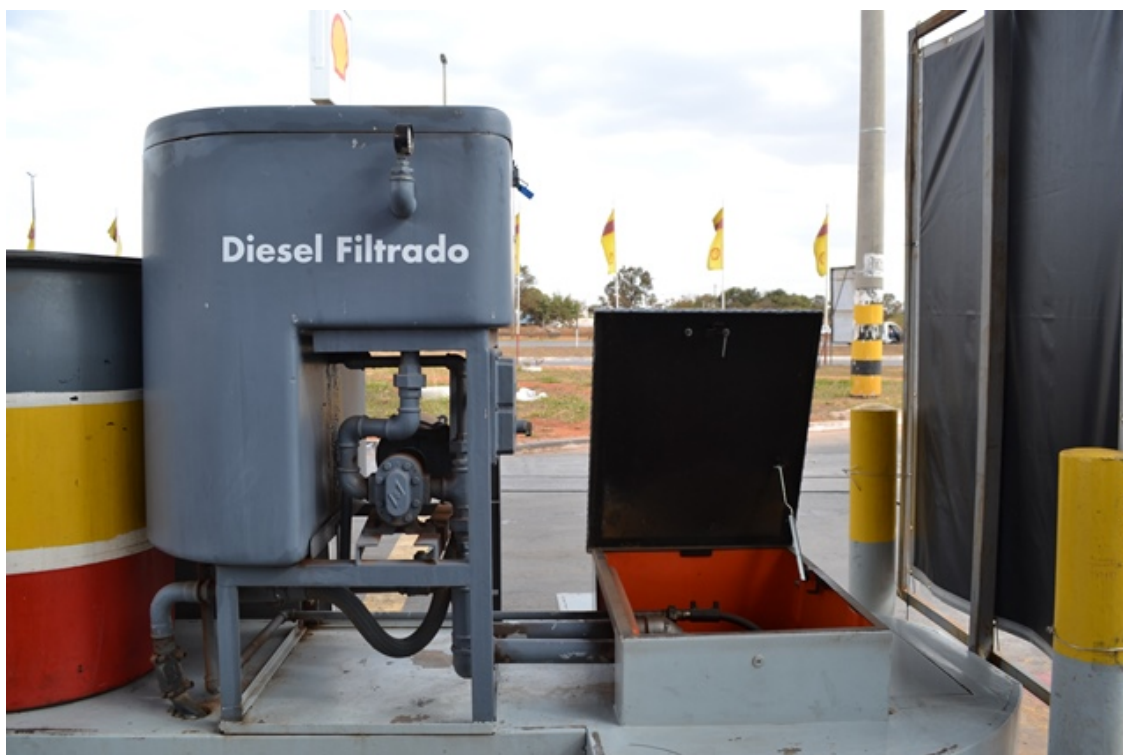
Figura 8: Filtro de Diesel 2 localizado na pista de abastecimento.
