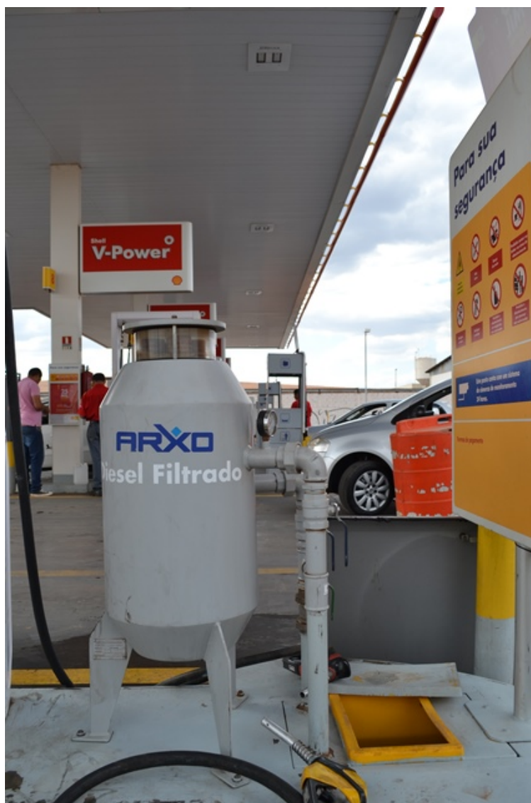
Figura 6: Filtro de Diesel 1 localizado na pista de abastecimento.
