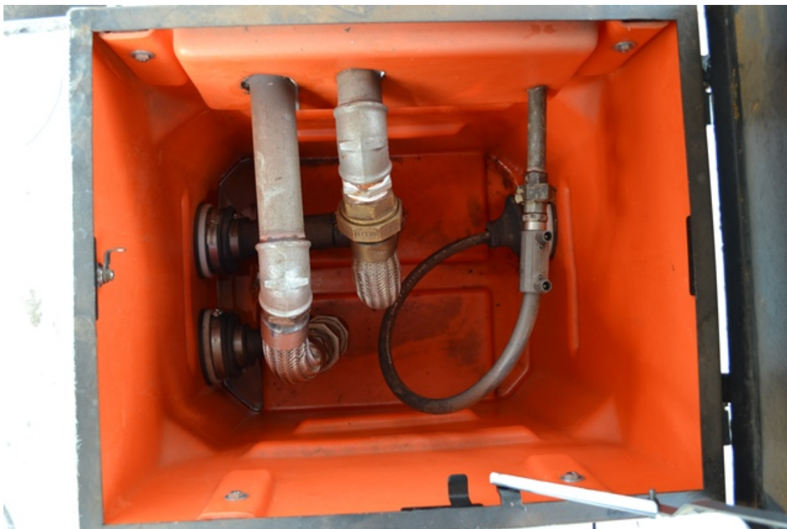
Figura 9: Câmara de contenção (sump) do filtro de Diesel 2.
