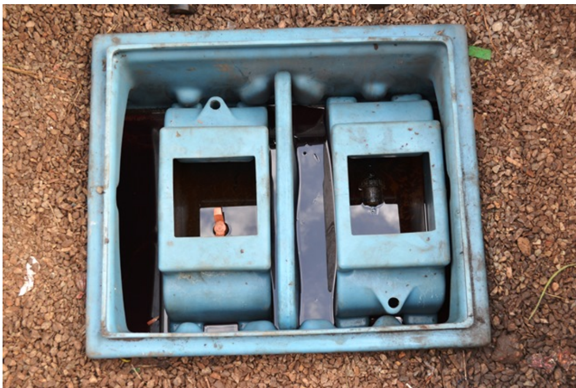
Figura 14: Aspecto da Caixa separadora de água e óleo do S.A.O.
