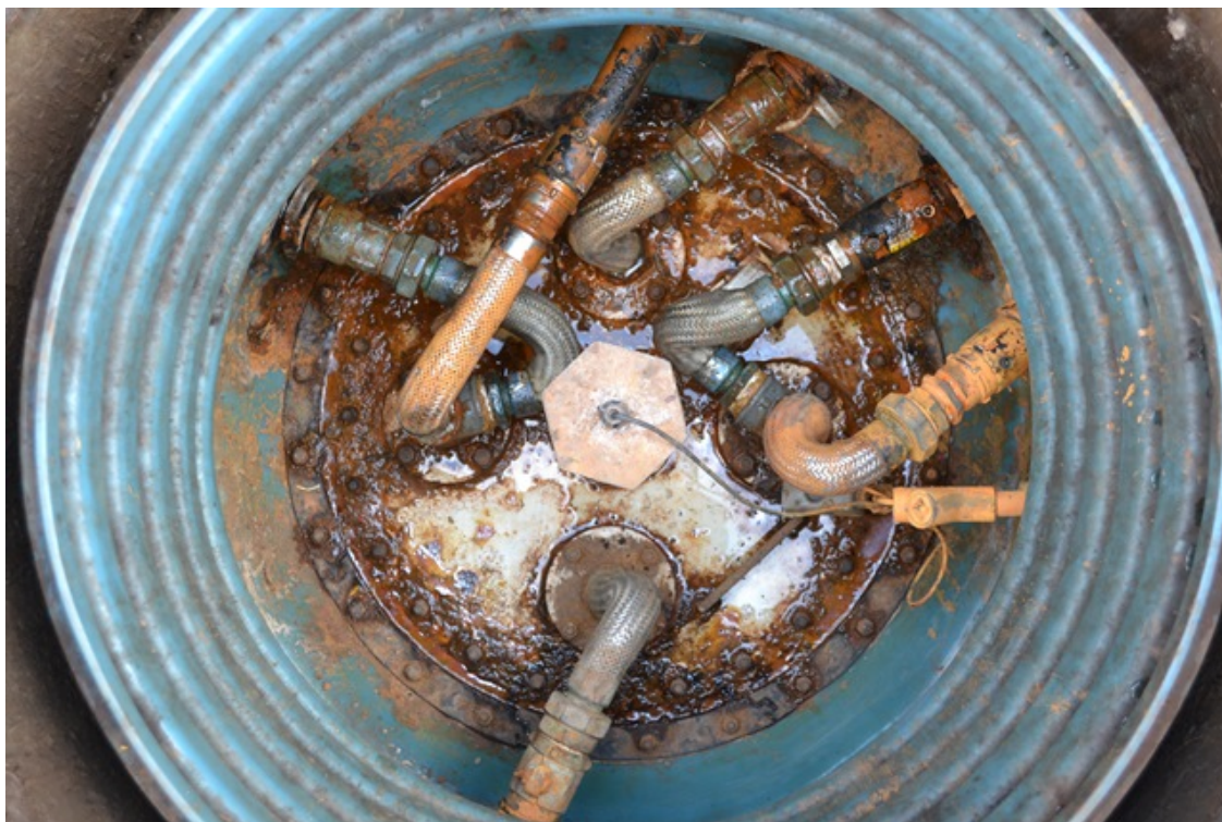
Figura 5: Boca de visita do tanque de combustível com sensor de monitoramento intersticial.
