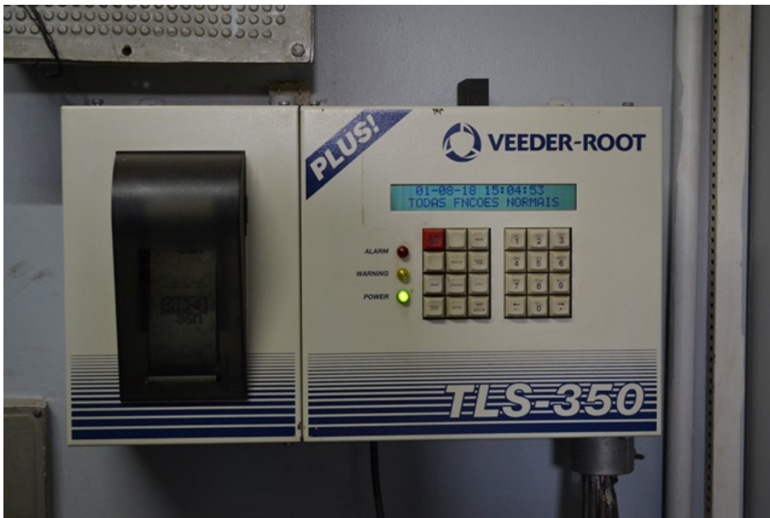
Figura 17: Sistema de monitoramento ambiental Veeder root .
