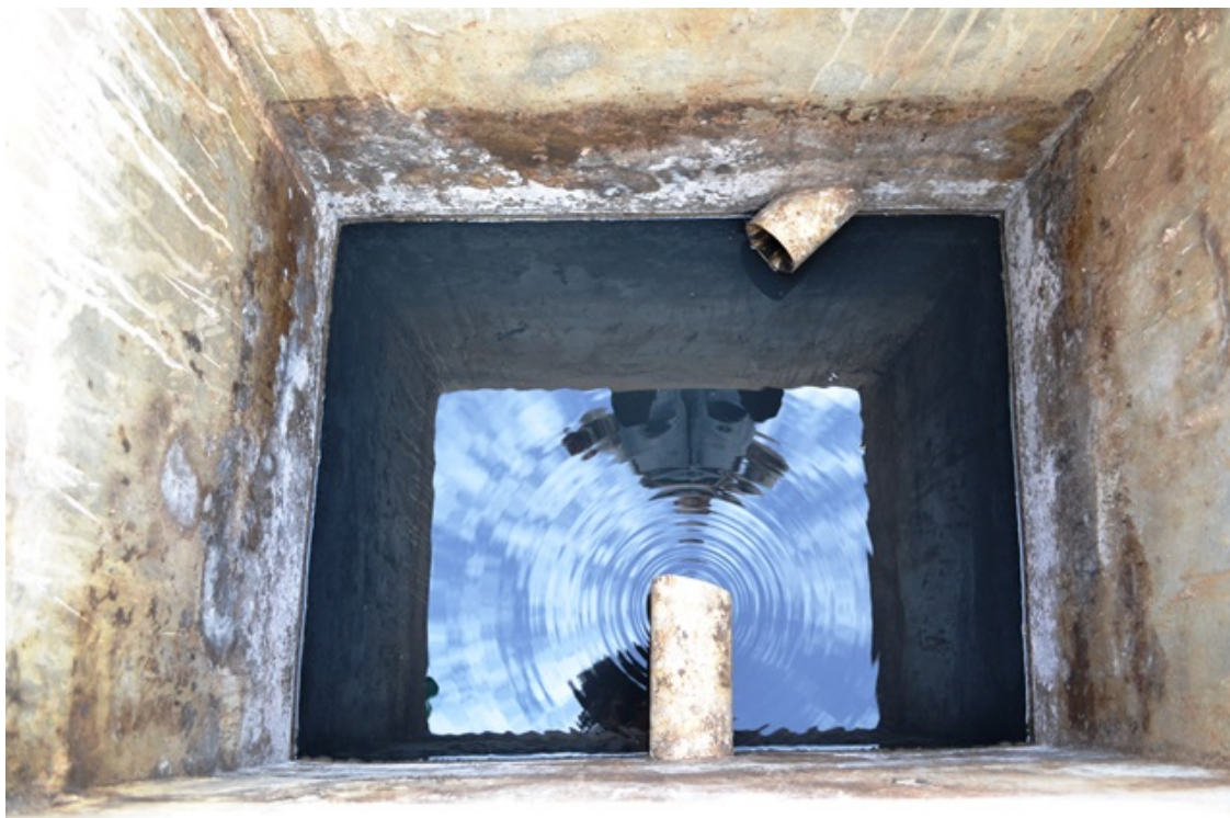
Figura 15: Aspecto da Caixa de amostragem de efluentes do S.A.O.
