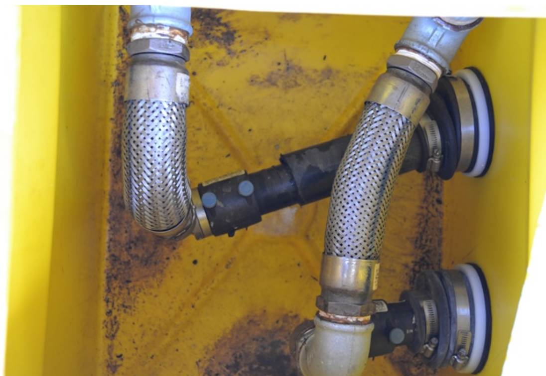
Figura 7: Câmara de contenção (sump) do filtro de Diesel 1.
