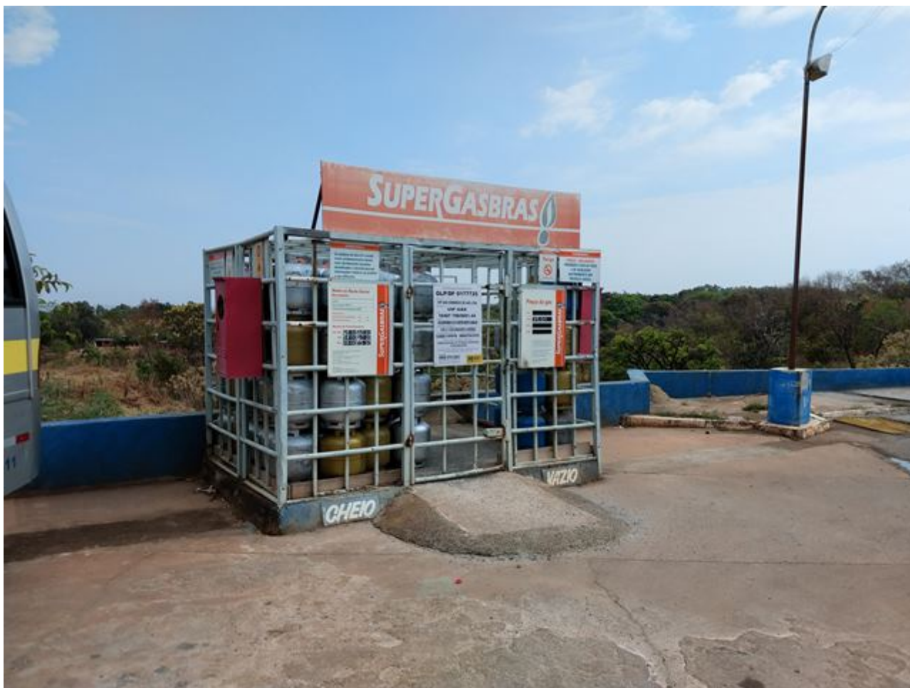
Figura 15- Gaiola de GLP. O estabelecimento aluga esta área para terceiros.
