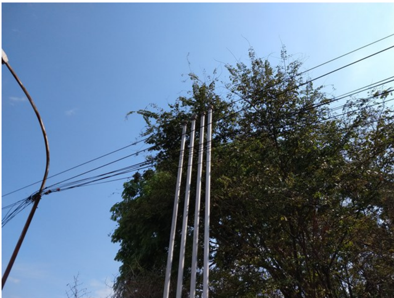
Figura 10- Respiros dos tanques da pista de abastecimento 1 com terminal corta-chamas.
