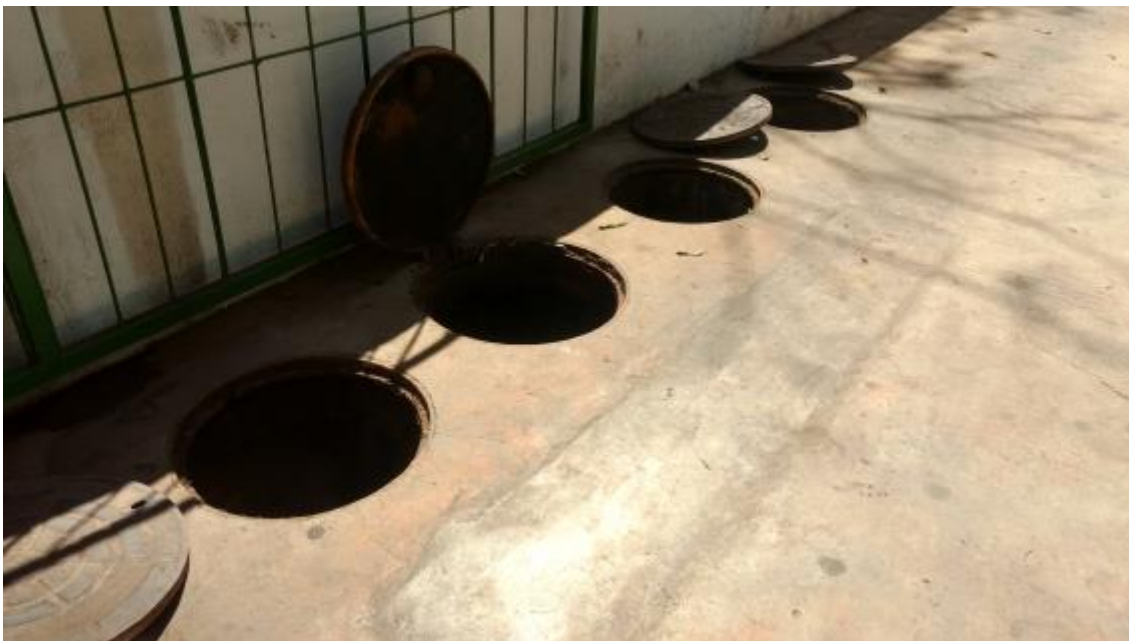
Foto 18: Sistema separador de água e óleo exclusivo da atividade de lavagem de veículos.
