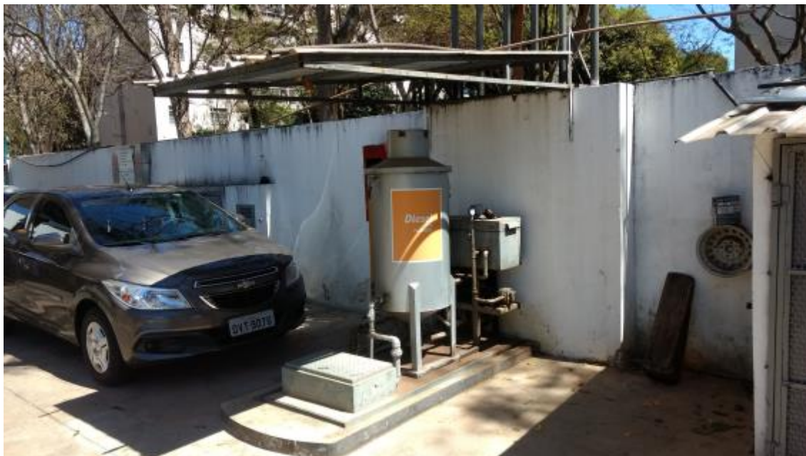
Foto 10: Unidade de filtragem de diesel instalada em local coberto e circundado por canaletes.
