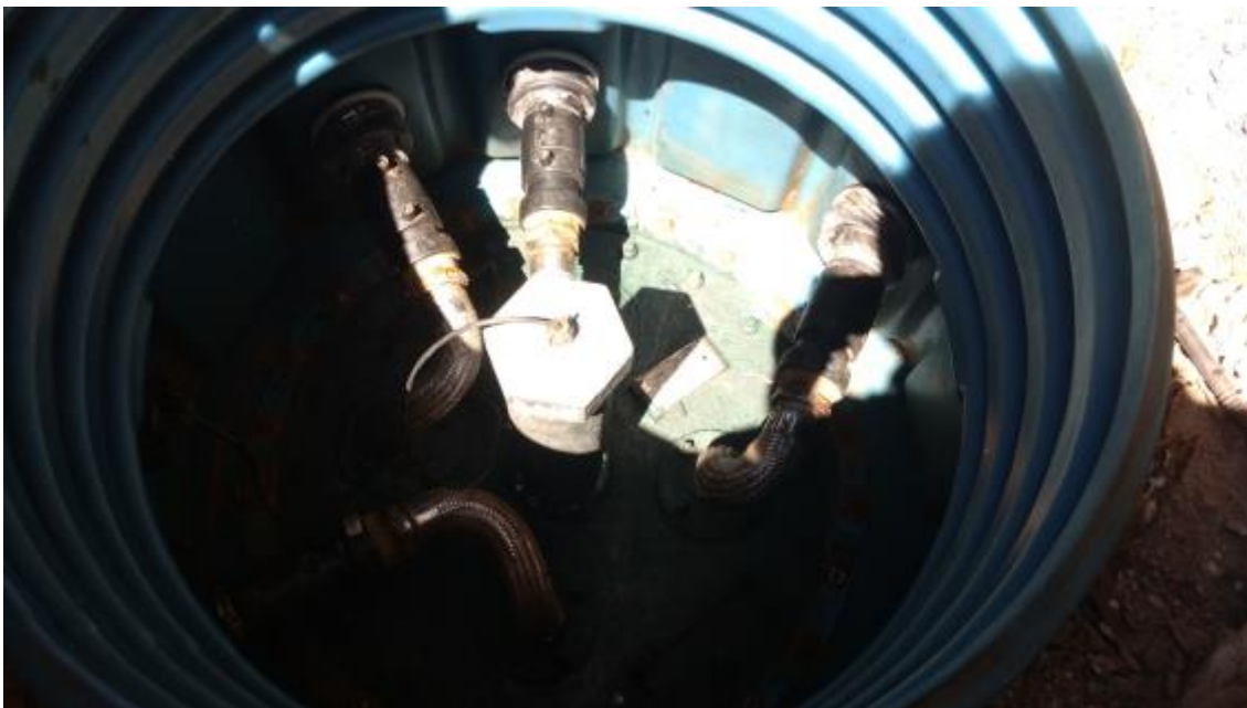
Foto 03: Boca de visita de um dos tanques com câmara de contenção, flanges de vedação e conexões metálicas flexíveis.
