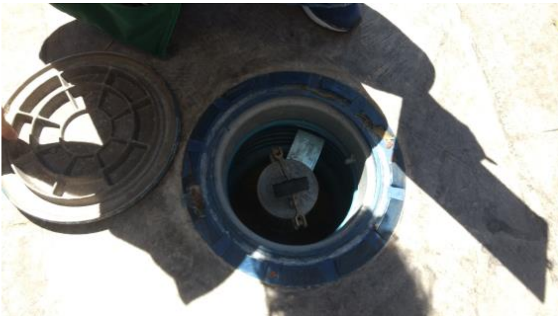
Foto 06: Descargas sobre o tanque com câmaras de contenção e válvula anti-transbordamento.
