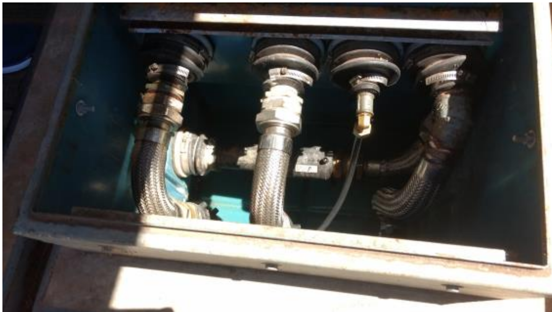
Foto 11: Câmara de contenção da unidade de filtragem de diesel.
