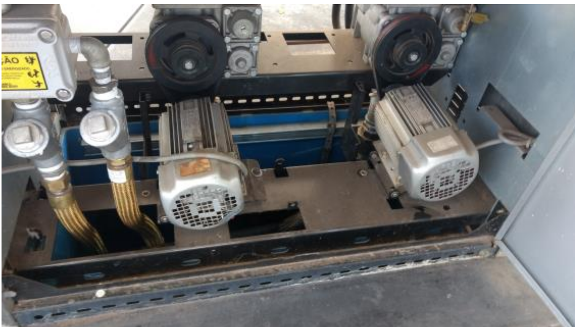
Foto 09: Unidade de abastecimento com câmara de contenção, check valve e sensor de vazamento.
