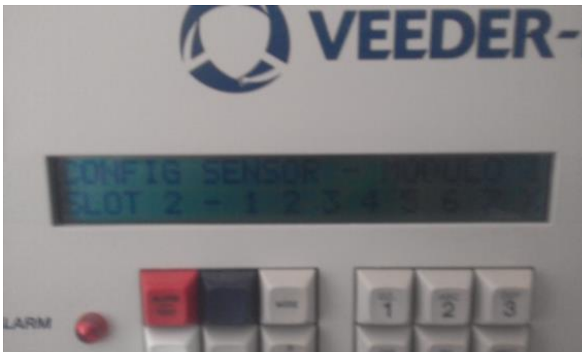
Foto 04: Painel eletrônico da marca Veeder Root para o controle de estoque e monitoramento ambiental. Na tela, a presença dos 07 (sete) sensores instalados nos tanques e unidades de abastecimento.
