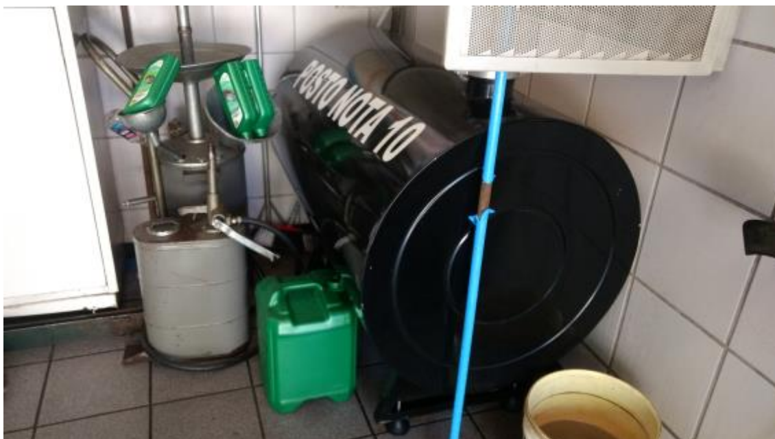
Foto 14: Tanque para armazenamento de OLU, localizado dentro da área de lubrificação de veículos.
