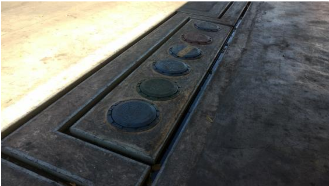
Foto 07: Descargas à distância com câmaras de contenção e circundadas por canaletes.
