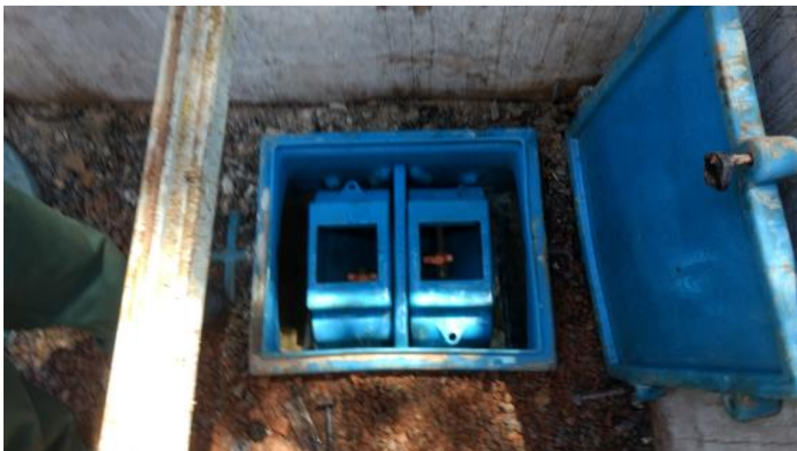
Foto 16: Caixa separadora de água e óleo da pista de abastecimento com caixa coletora de óleo embutida.
