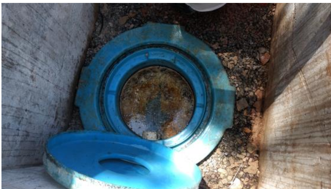
Foto 15: Caixa de areia do SAO da pista de abastecimento.
