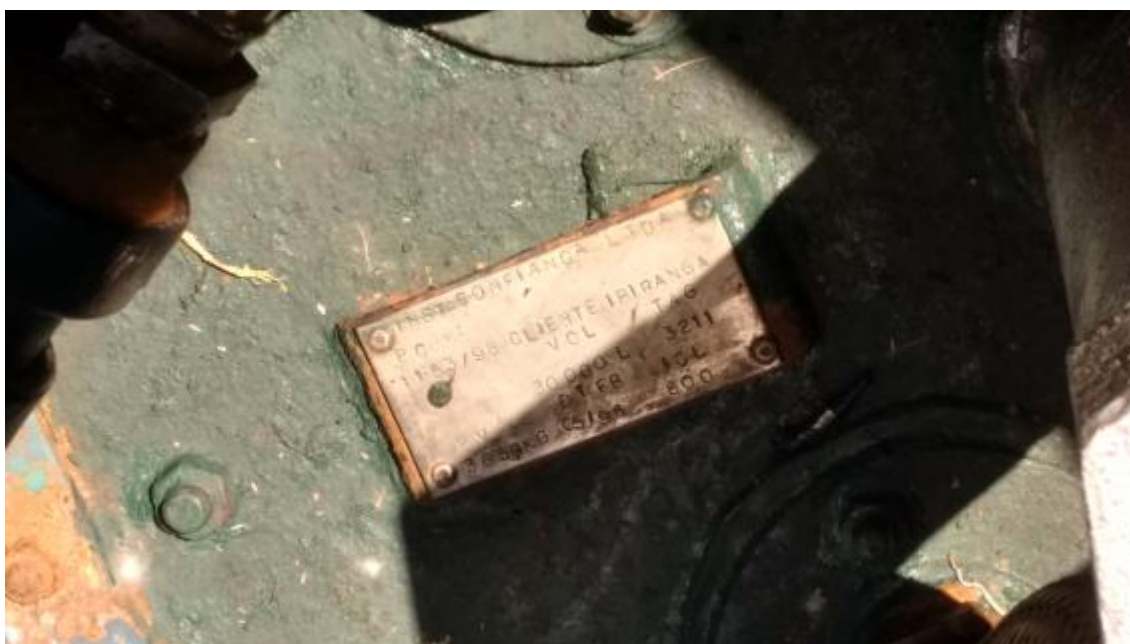
Foto 02: Placa de identificação de um dos tanques subterrâneos instalados no empreendimento.
