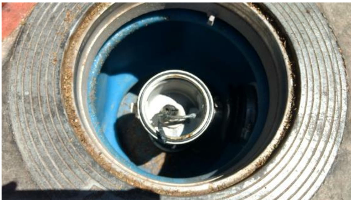
Foto 05: Câmara de contenção do monitoramento e caixa de passagem do sensor.
