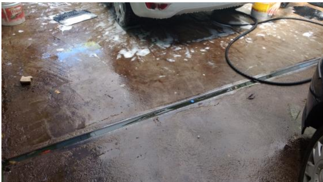
Foto 12: Fuga de efluente para área não abrangida pelo Sistema de Drenagem Oleosa da atividade de lavagem de veículos e canaleta obstruído.
