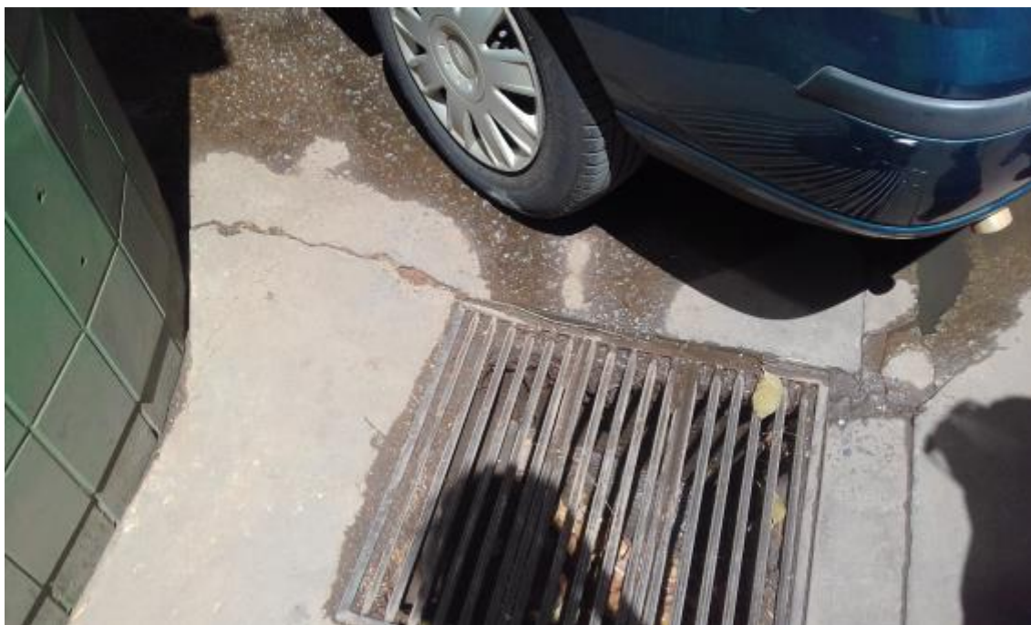
Foto 13: Efluente da atividade de lavagem de veículos sendo despejado na caixa de passagem ligada ao sistema de captação de água pluvial.
