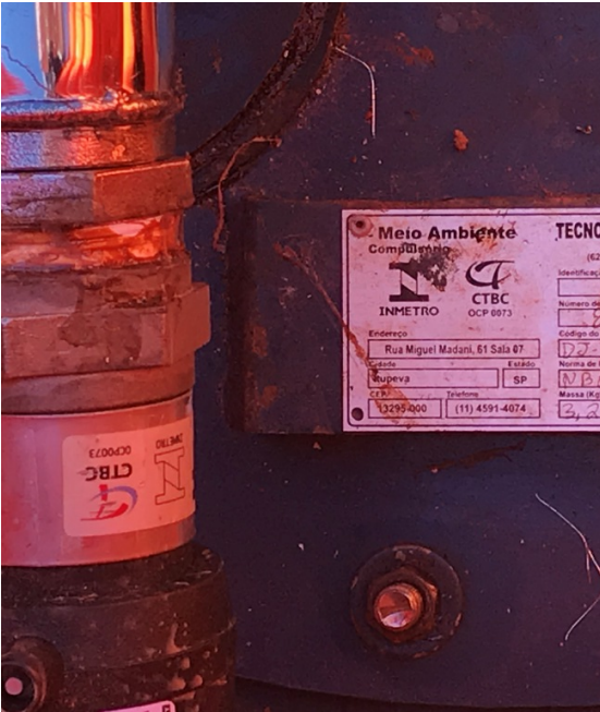
Foto 10. Detalhe da placa de identificação de um dos tanques.
