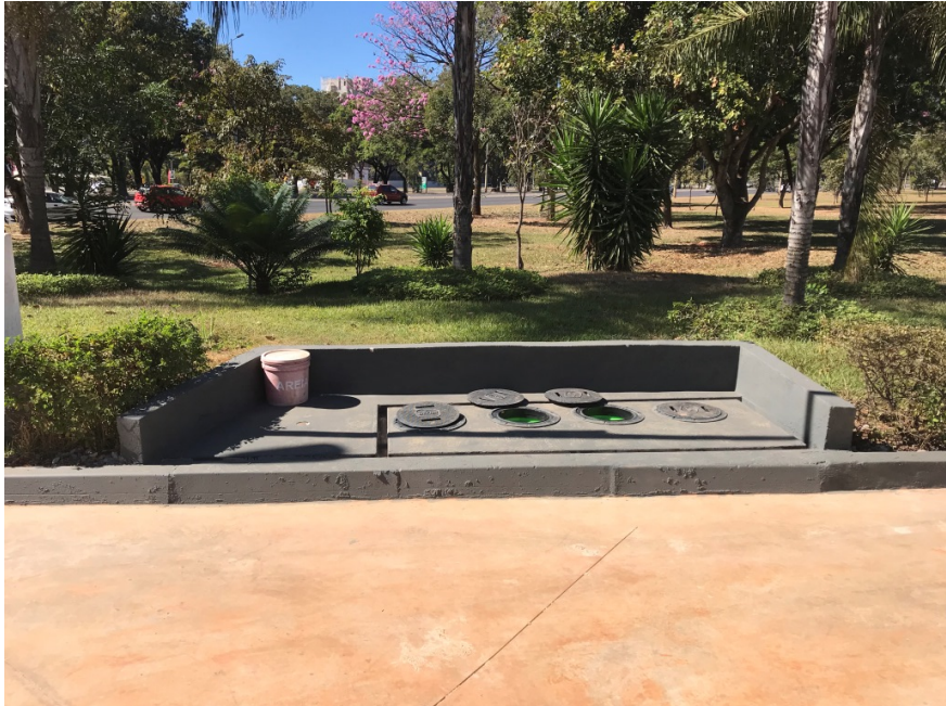
Foto 7. Visão geral da descarga selada sobre o tanque.
