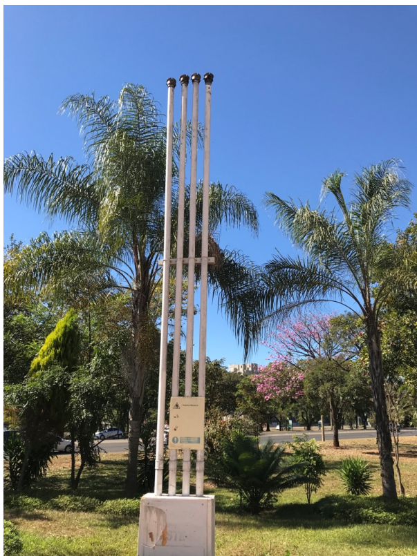
Foto 17. Visão geral dos respiros instalados.
