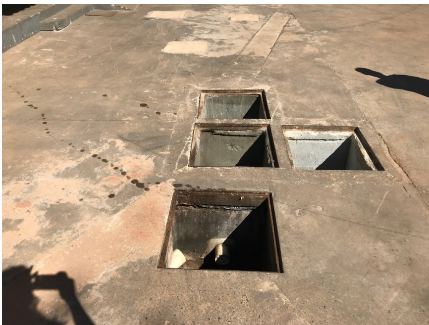
Foto 15. Visão geral do SAO da área de lavagem de veículos.
