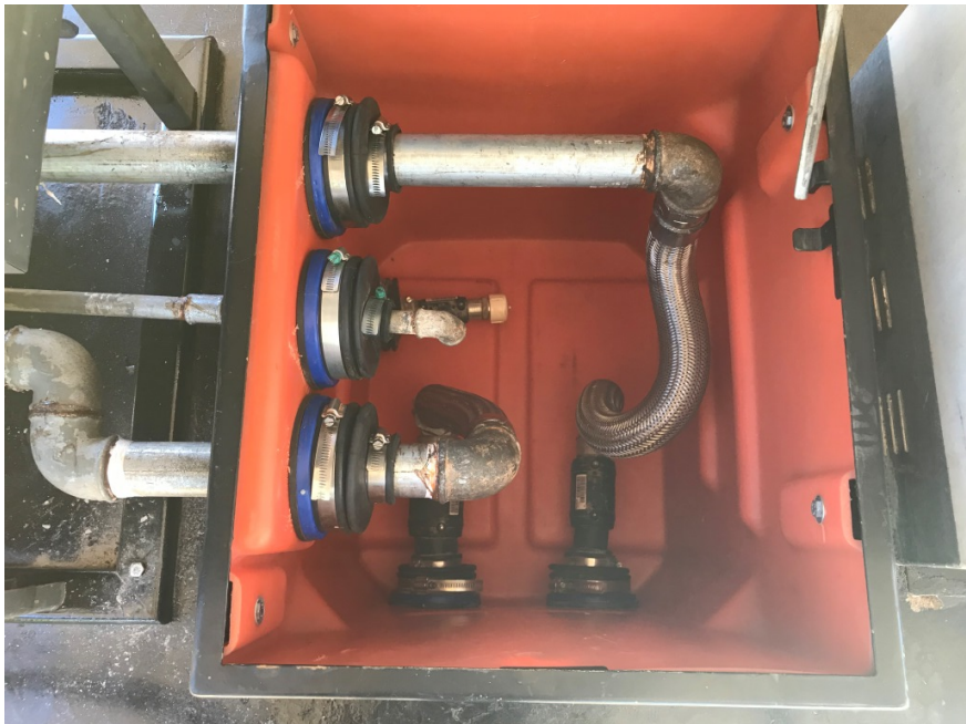
Foto 5. Câmara de contenção do filtro de diesel.
