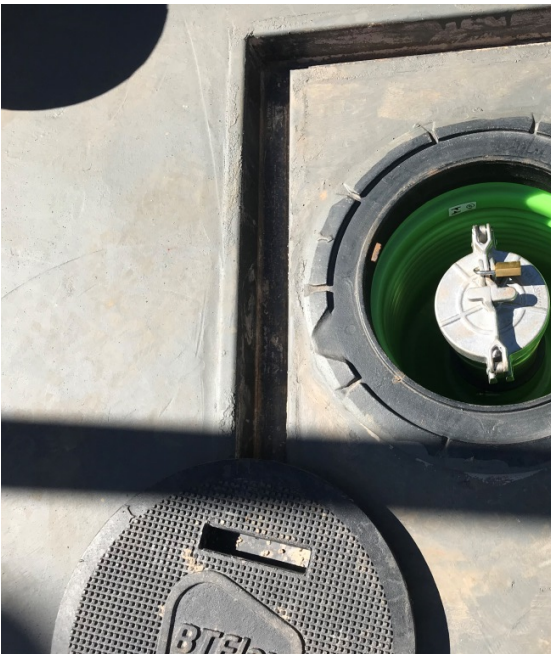
Foto 6. Descarga selada sobre o tanque com câmara de contenção
