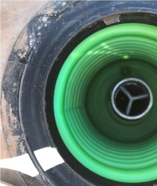
Foto 8. Detalhe da descarga selada sobre o tanque, com câmara de contenção
