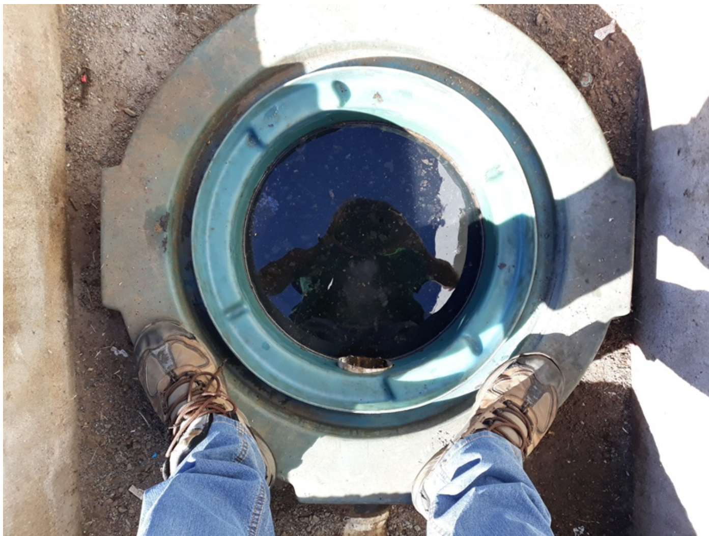
Figura 18 - Caixa separadora de areia.
