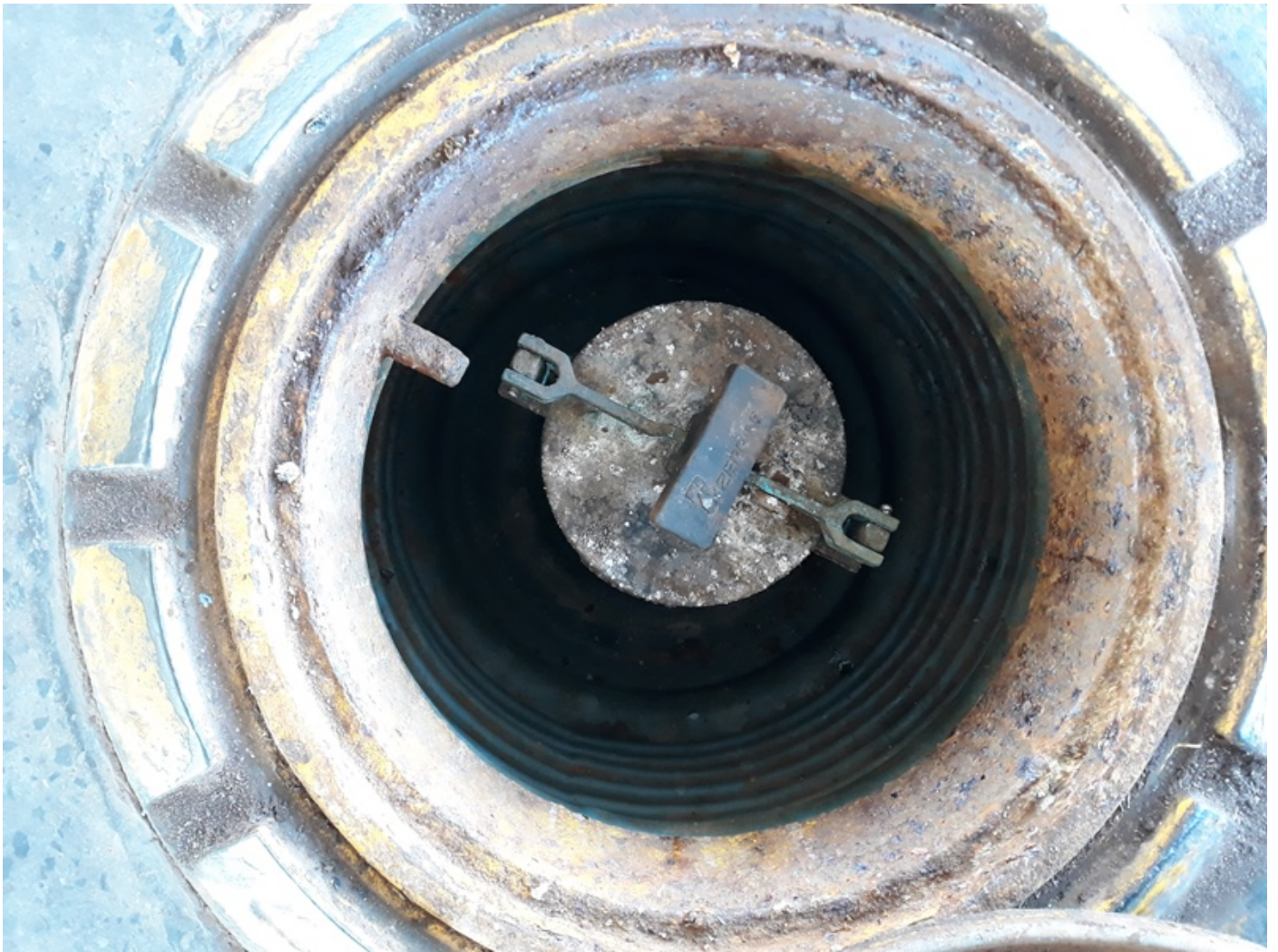
Figura 09 - Descarga selada sobre o tanque dotada de câmara de contenção e com boa manutenção, observa-se, entretanto, necessidade de substituição da tampa que se encontra deteriorada.
