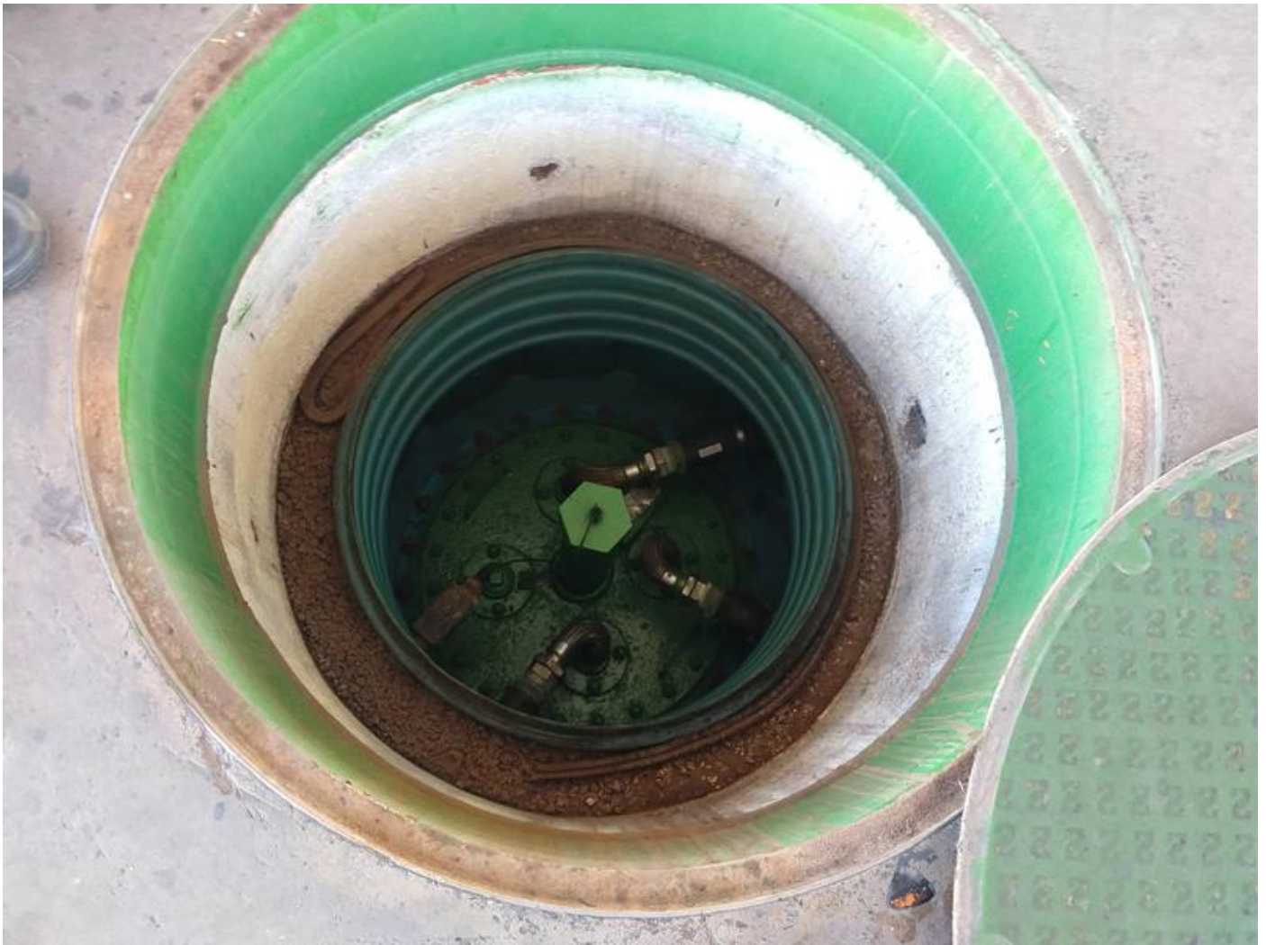
Figura 06 - Câmara de contenção no acesso à boca de visita do ranque, observa-se tubulações em PEAD e controle de estoque eletrônico (2).
