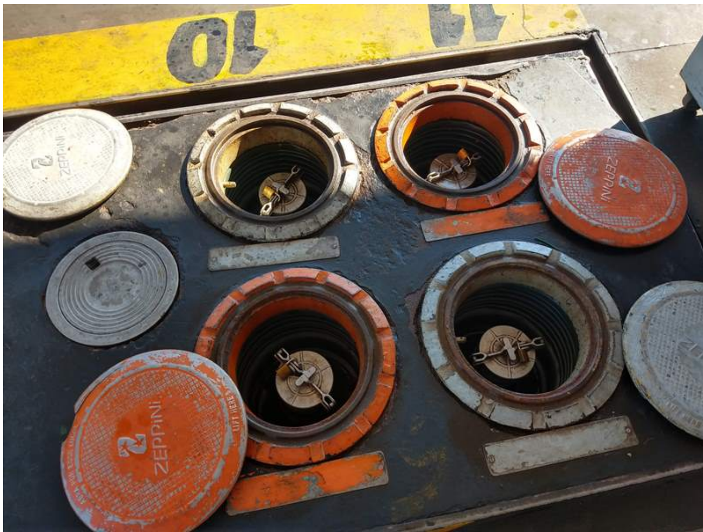
Figura 07 - Descargas seladas a distância, todas localizadas no interior da pista de abastecimento, cercadas por canaletas, com câmara de contenção e manutenção adequada.
