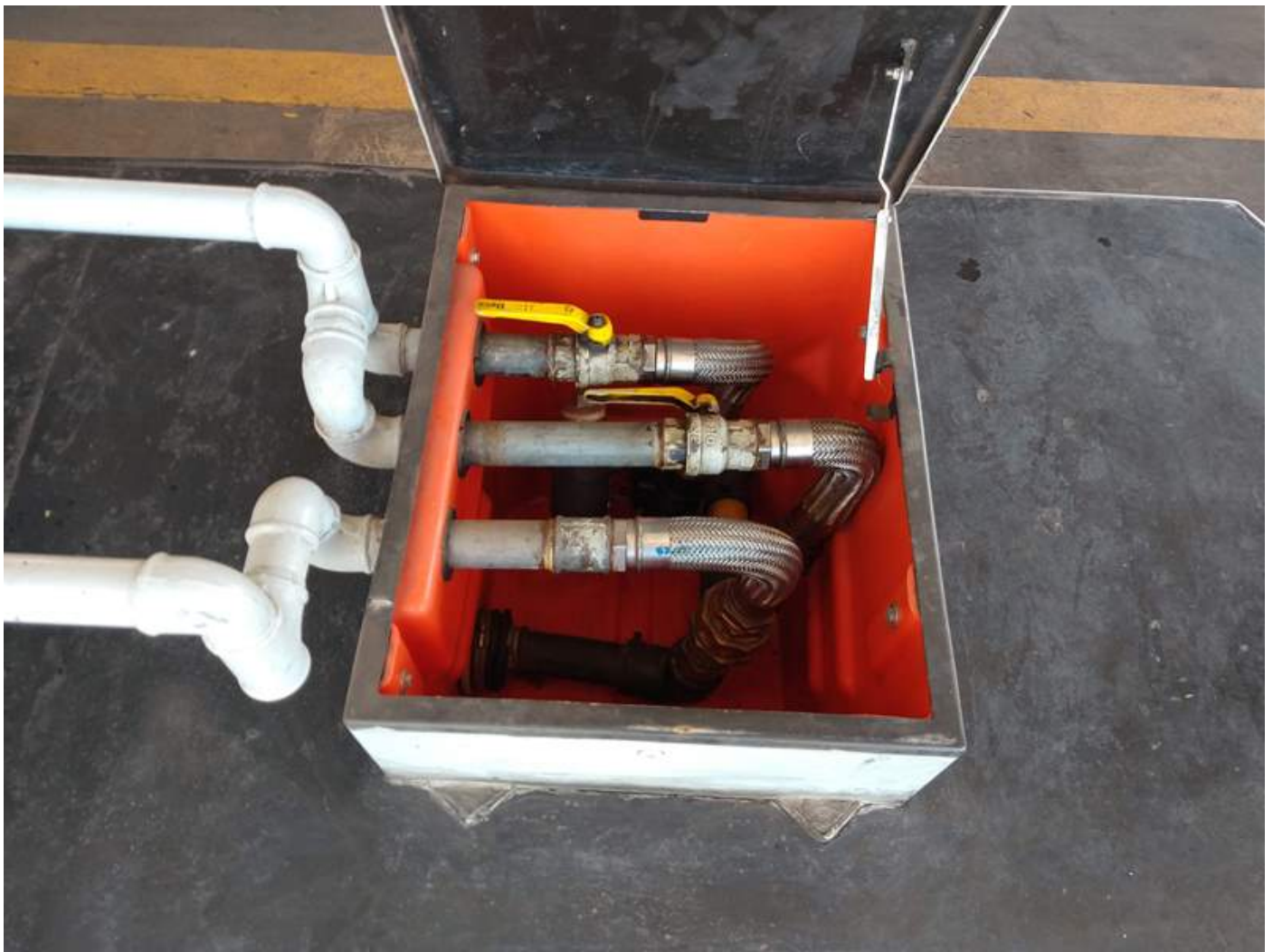
Figura 15 - Câmara de contenção da unidade filtrante de diesel.
