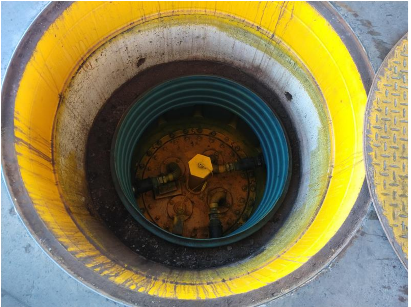
Figura 05 - Câmara de contenção no acesso à boca de visita do ranque, observa-se tubulações em PEAD e controle de estoque eletrônico, infelizmente não foi possível observar o conteúdo da placa de identificação desta unidade.
