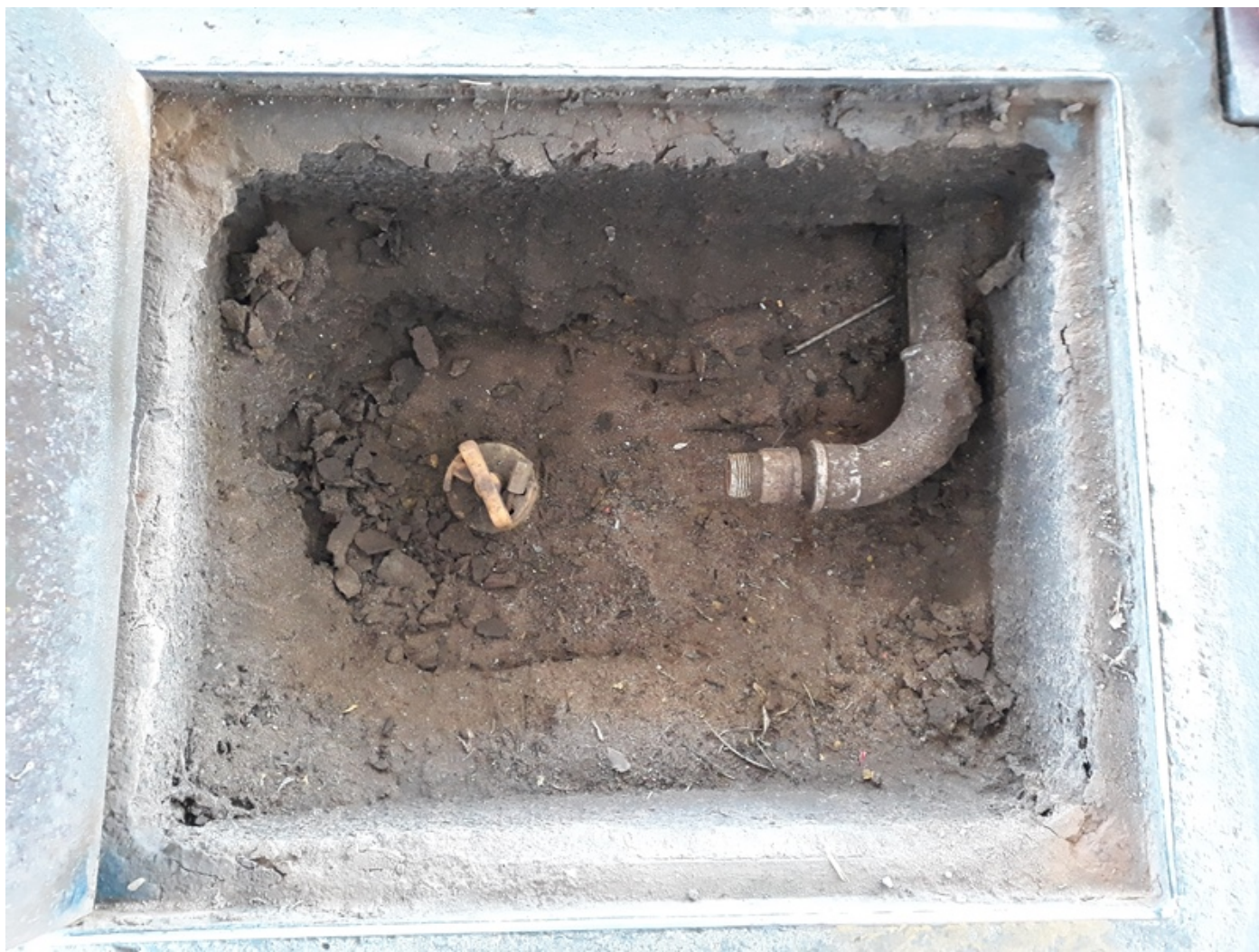
Figura 22 - Poço destinado ao remediamento ambiental, que se encontrava desativado no momento da vistoria.
