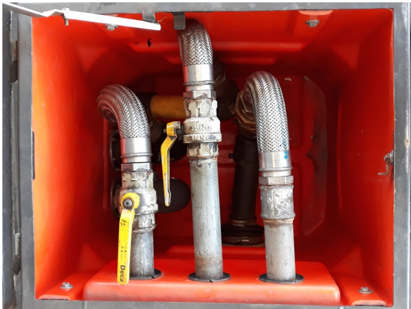
Figura 14 - Interior da câmara de contenção da unidade filtrante, observa-se tubulação não metálica para o trecho subterrâneo e metálica para o trecho aéreo.
