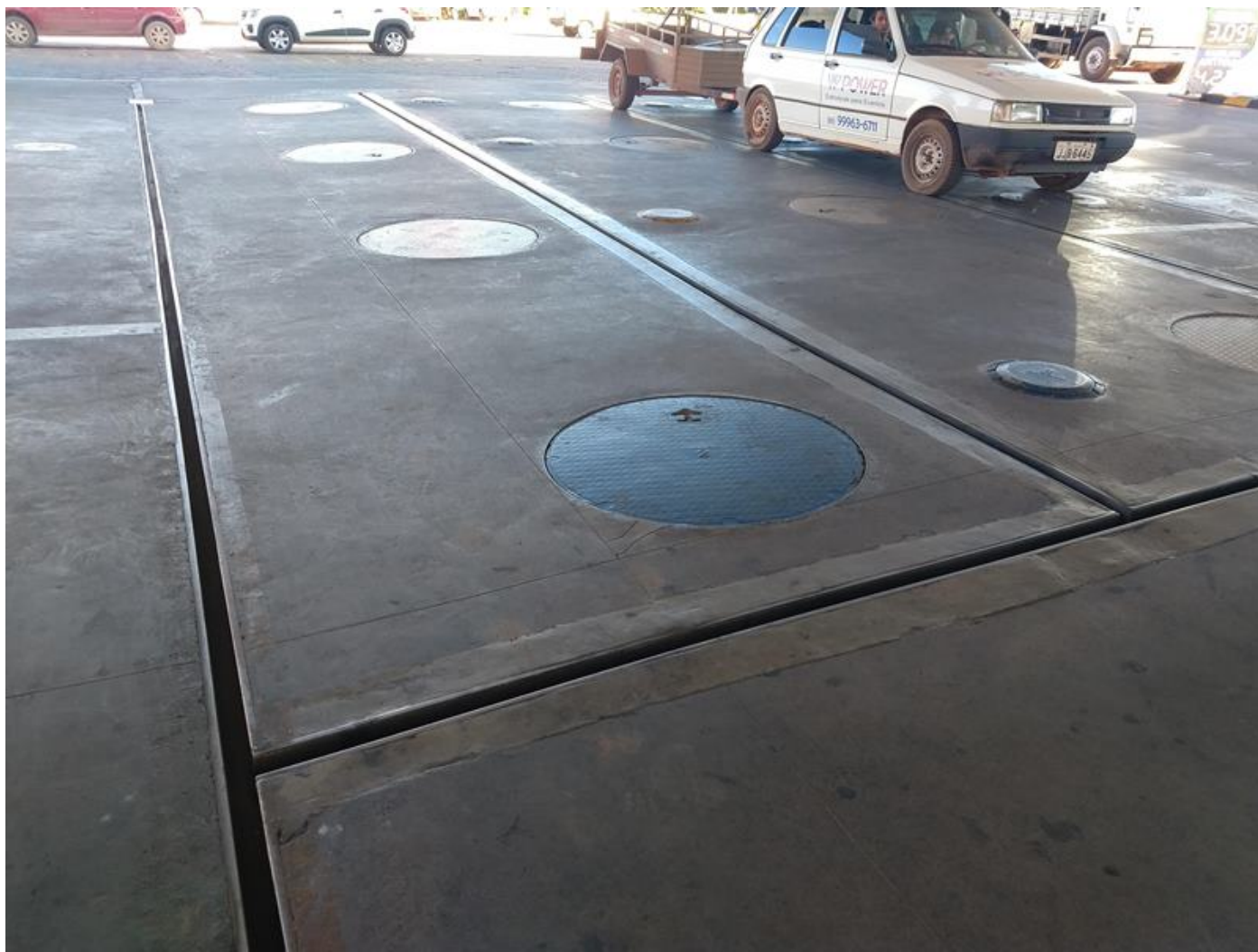
Figura 04 - Área de tancagem, no interior da pista de abastecimento e cercada por canaletes.
