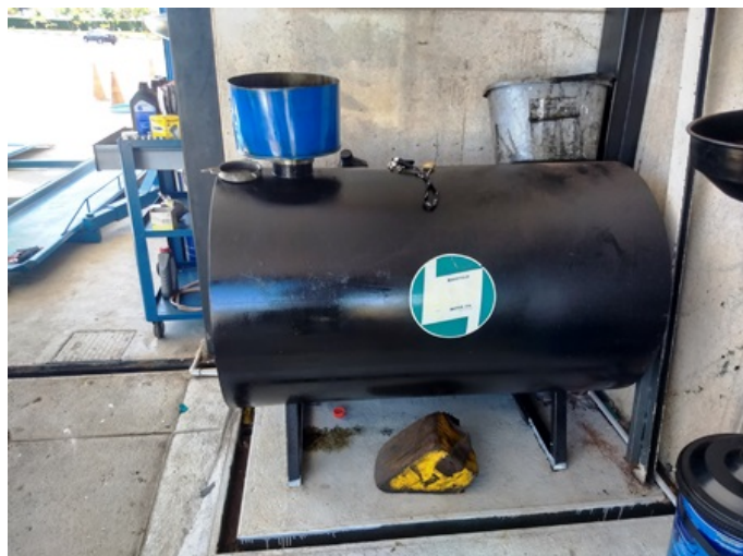
Foto 26 - Tanque aéreo de OLUC em local coberto e contemplado por canaletas.
