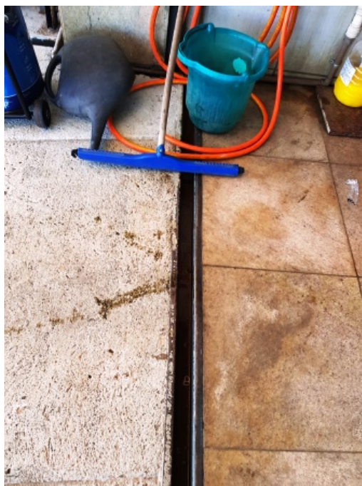
Foto 25 - Canaleta integrante do SDO localizada na entrada da área de lubrificação.
