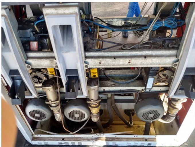
Foto 13 - Detalhe da unidade abastecedora, dotada de check valve instalada em linha de sucção.
