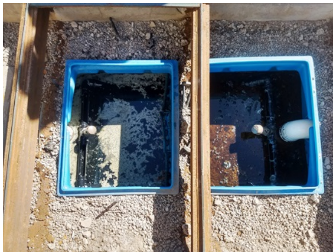
Foto 16 - Caixa de separação de água e óleo. Observa-se o acúmulo de efluentes sobrenadantes.
