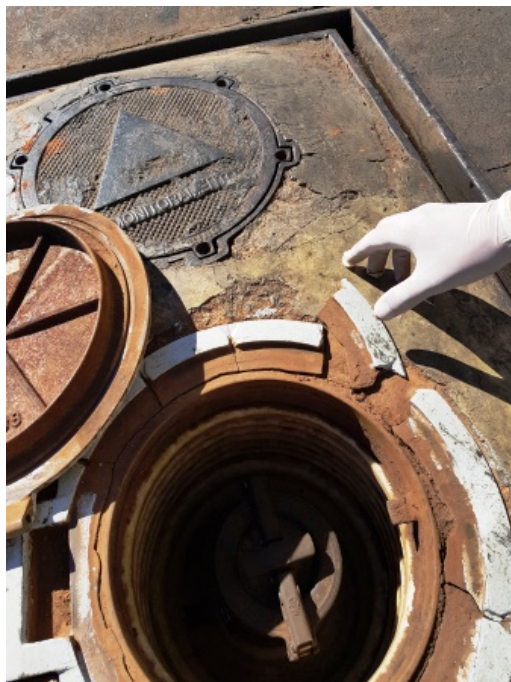
Foto 03 - Tampa da câmara de calçada da descarga sobre o tanque deteriorada.
