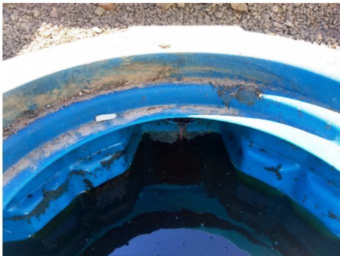
Foto 15 - Caixa de areia.
