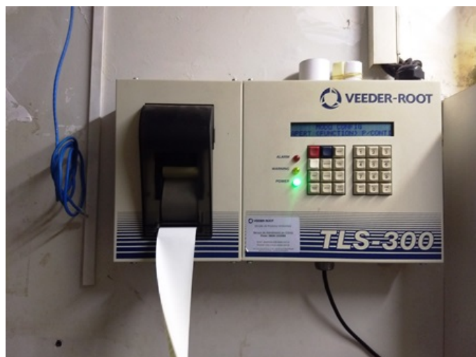
Foto 05 - Sistema de monitoramento intersticial e de estoque.
