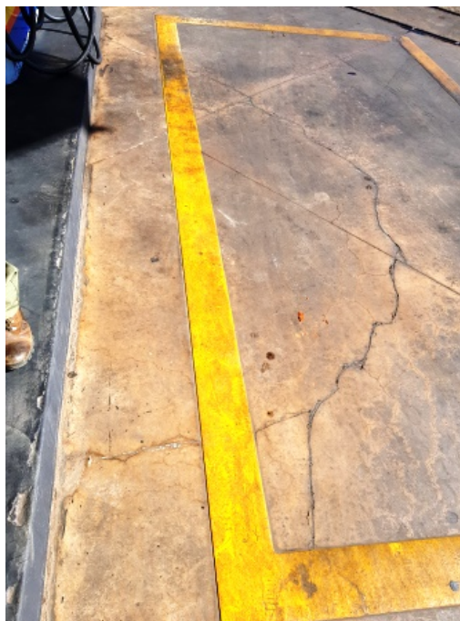
Foto 19 - Piso da pista de abastecimento com rachaduras.
