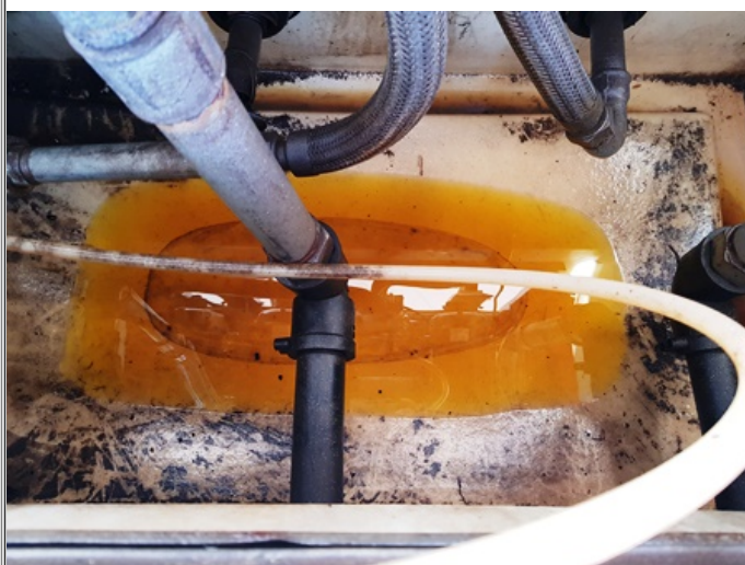
Foto 11 - Sump de bomba com acúmulo de combustíveis.
