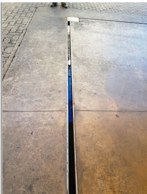
Foto 16 - Canaletes do Sistema de Drenagem Oleosa - SDO da pista de abastecimento.
