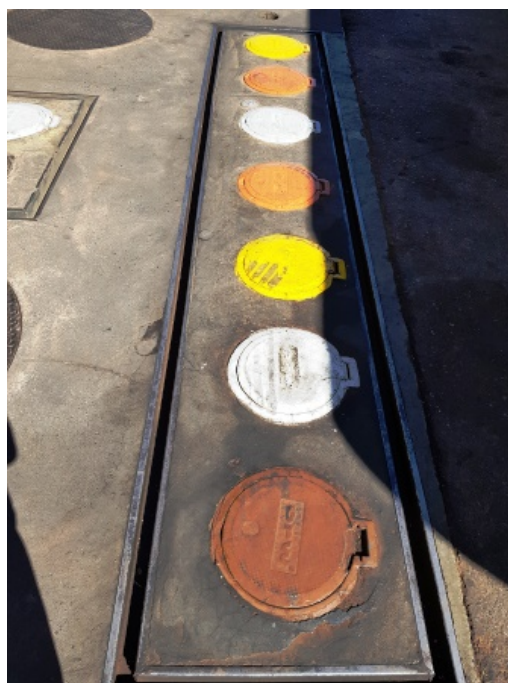
Foto 02 - Área de descarga selada à distância.
