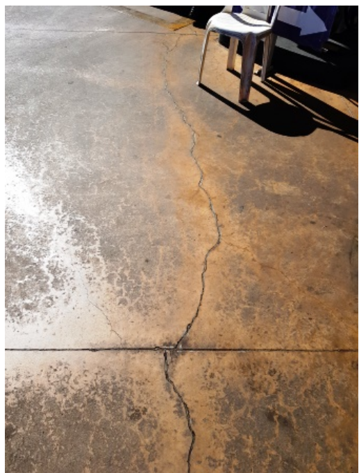
Foto 18 - Piso da pista de abastecimento com rachaduras.
