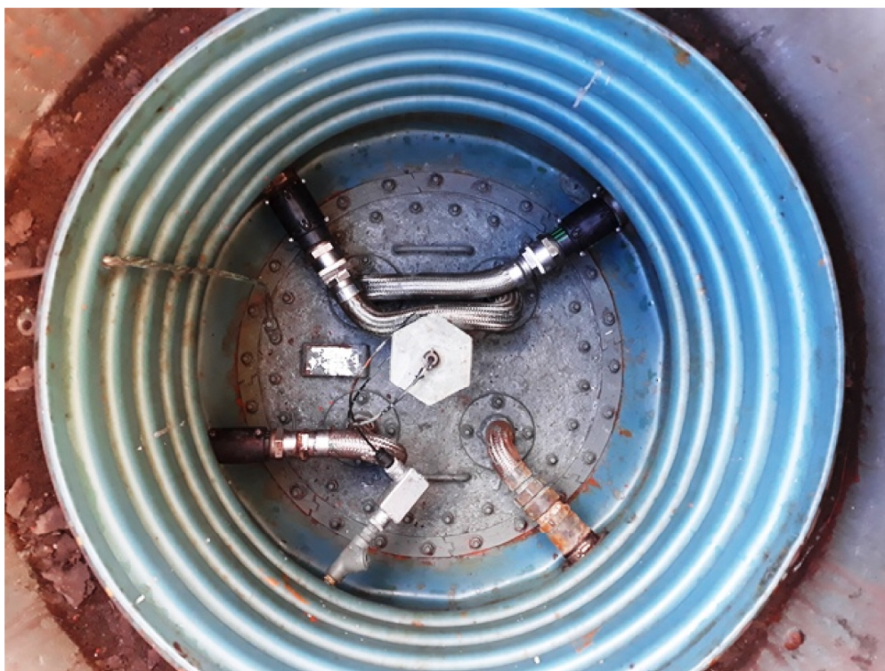
Figura 10 - Aspecto da Câmara de contenção de acesso à boca de visita ( sump de tanque ) do tanque pleno com controle eletrônico de estoque, tubulação metálica flexível, tubulação subterrânea em PEAD e flanges de vedação . O tanque deverá ter manutenção operacional constante conforme exige a ABNT NBR 15594-3:2008 tabela 1.
