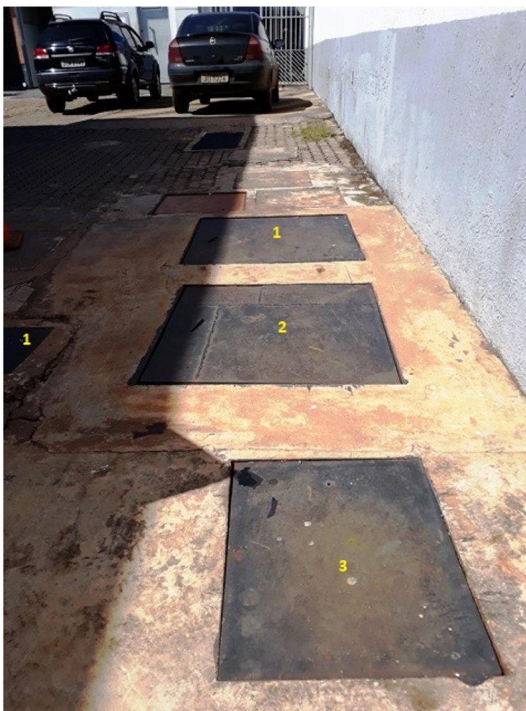
Figura 16 - Aspecto geral do Separador de Água e Óleo da área do lava Jato. O sistema possui Caixa de areia (n°1), Caixa separadora de água de óleo (n°2), caixa coletora de óleo e caixa de amostragem de efluentes (n°3). O sistema quando entrar em operação deverá realizar manutenção operacional semanal conforme exige a ABNT NBR 155943:2008 tabela 1.
