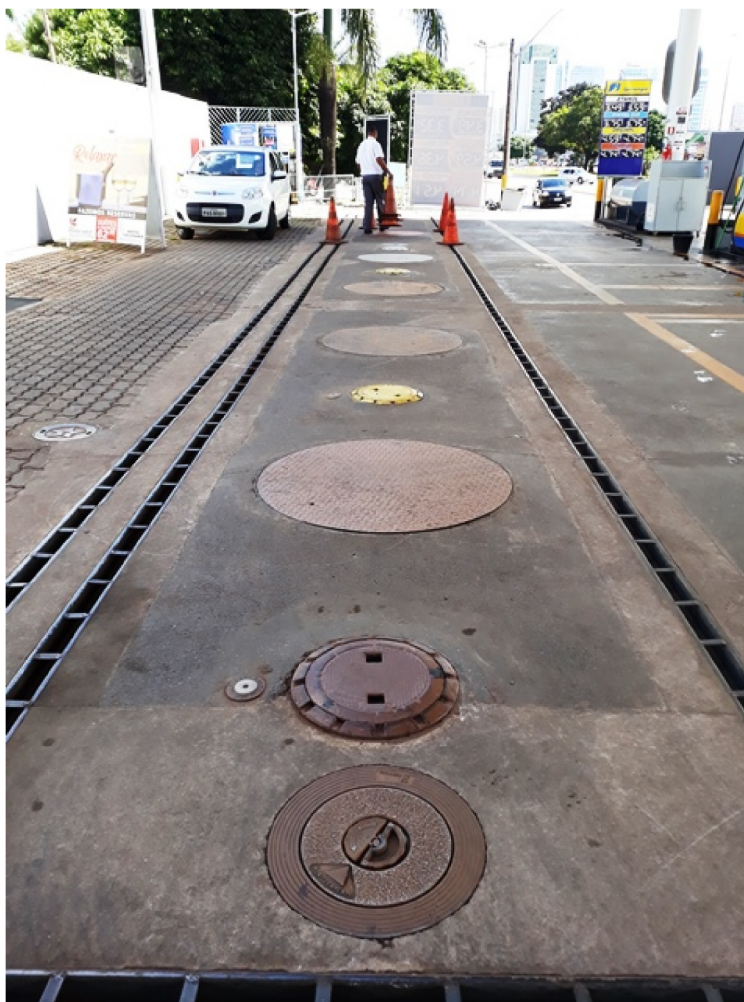
Figura 9 - Aspecto da área de tancagem do SASC com tanque pleno e bicompartimentado com capacidade de 15 a 30 m 3 com capacidade de 30 m 3 .
