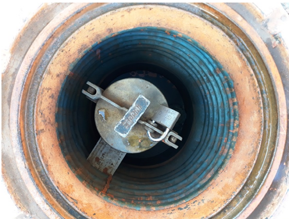
Figura 13 - Dispositivo de Descarga selada sobre o tanque com câmara de contenção ( Spill container ou descarga ) sem válvula anti-transbordamento. O dispositivo deverá ter manutenção operacional constante conforme exige a ABNT NBR 15594-3:2008 tabela 1.
