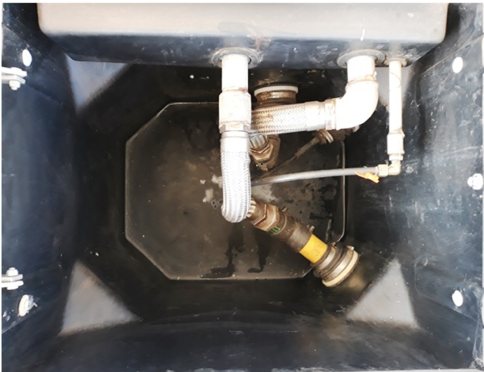
Figura 6 - Detalhe interno da Câmara de contenção da unidade de filtragem de óleo Diesel. Observa-se que a tubulação esta totalmente contida no sump de filtro da câmara de contenção no dispositivo de segurança. O sump das demais unidades necessitam de manutenção operacional diária conforme exige a ABNT NBR 15594-3:2008 tabela 1
