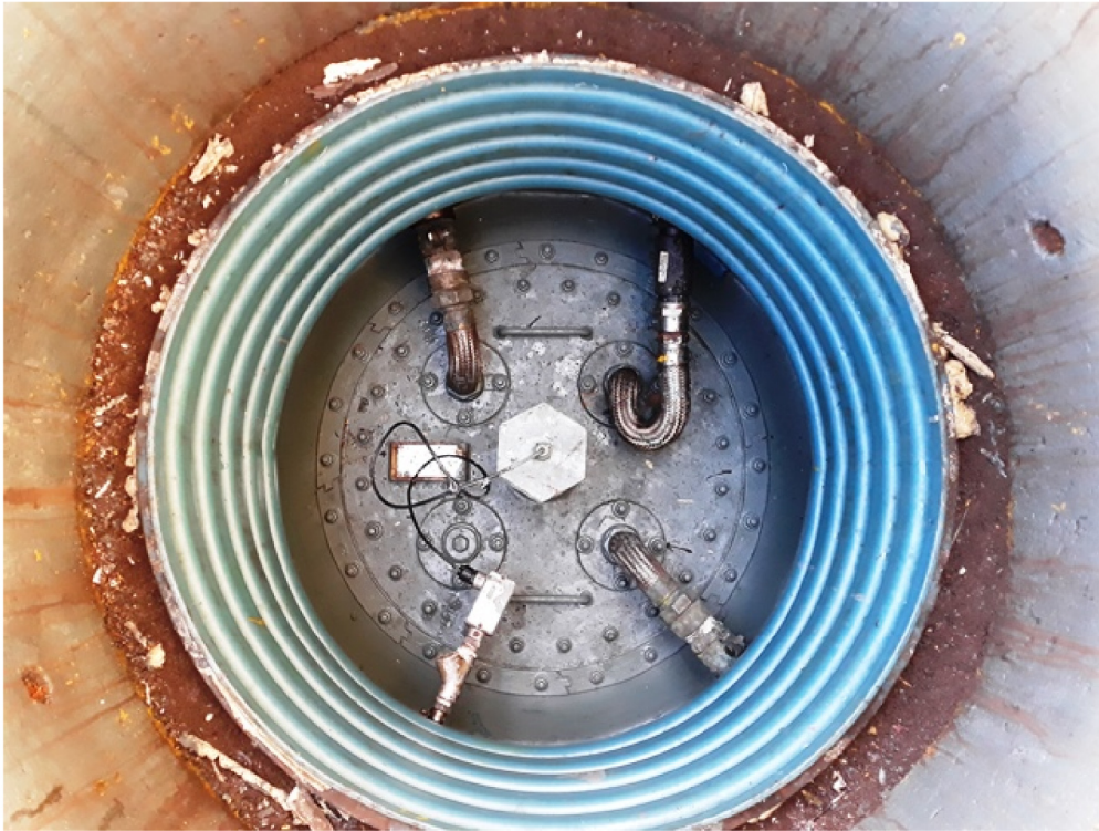
Figura 11 - Aspecto da Câmara de contenção de acesso à boca de visita de um dos SASC ( sump de tanque ) do tanque com controle eletrônico de estoque, tubulação metálica flexível, tubulação subterrânea em PEAD e flanges de vedação . O tanque deverá ter manutenção operacional constante conforme exige a ABNT NBR 15594-3:2008 tabela 1.
