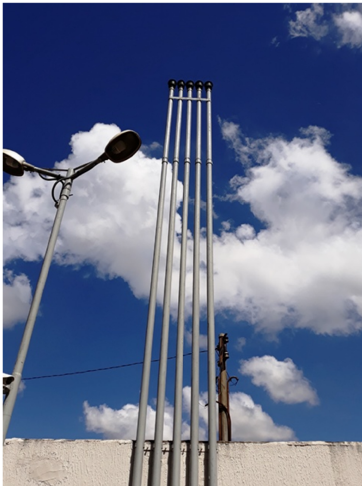
Figura 8 - Respiros com terminal corta chamas em conformidade com o que é exigido na ABNT NBR 13783:2014 item 8.3.4.
