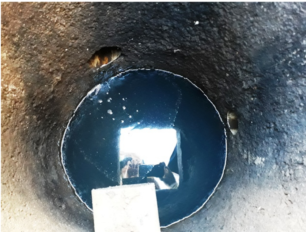
Figura 17 - Aspecto da Caixa de Areia do SAO da pista de Abastecimento.
