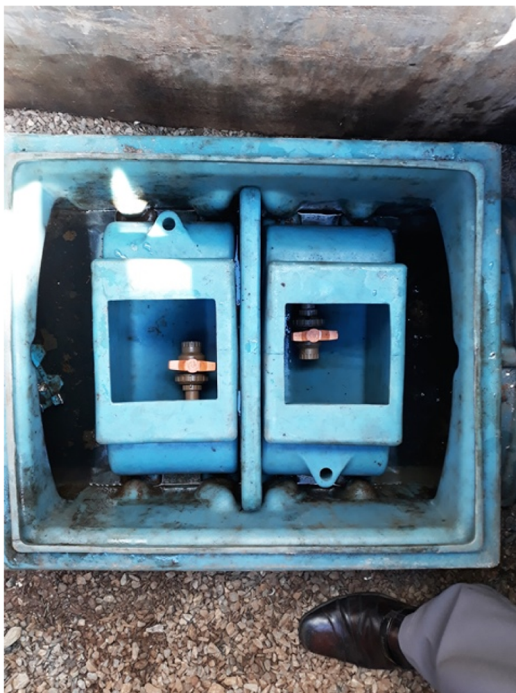
Figura 18 - Aspecto da Caixa Separadora de Água e Óleo - CSAO da pista de Abastecimento.
