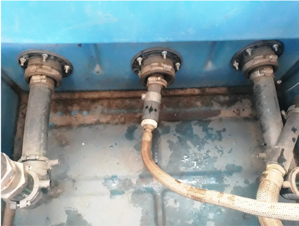
Figura 4 - Detalhe interno da Câmara de contenção de uma das Unidades Abastecedoras do SASC. Observa-se que a tubulação esta totalmente contida no sump da câmara de contenção no dispositivo de segurança. Os sumps das demais unidades necessita de manutenção operacional diária conforme exige a ABNT NBR 15594-3:2008 tabela 1
