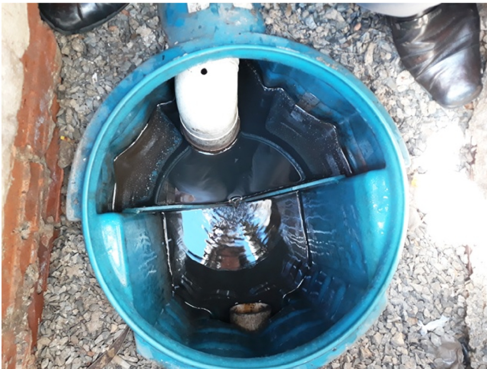
Figura 19 - Aspecto da caixa de amostragem de efluentes do SAO da pista de Abastecimento.
