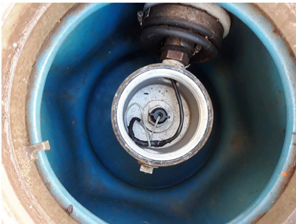
Figura 14 - Dispositivo do Monitoramento do interstício do tanque de parede dupla. O dispositivo deverá ter manutenção operacional constante conforme exige a ABNT NBR 15594-3:2008 tabela 1.
