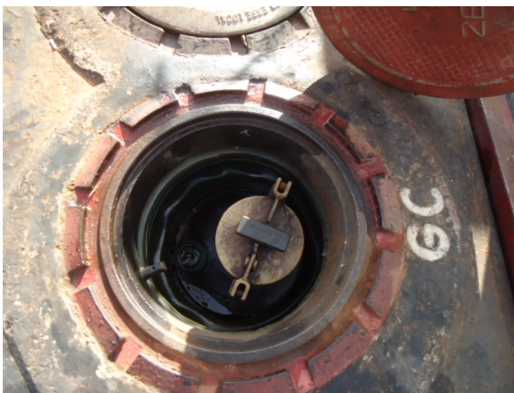
Foto 3. Descarga selada à distância sem flanges.
