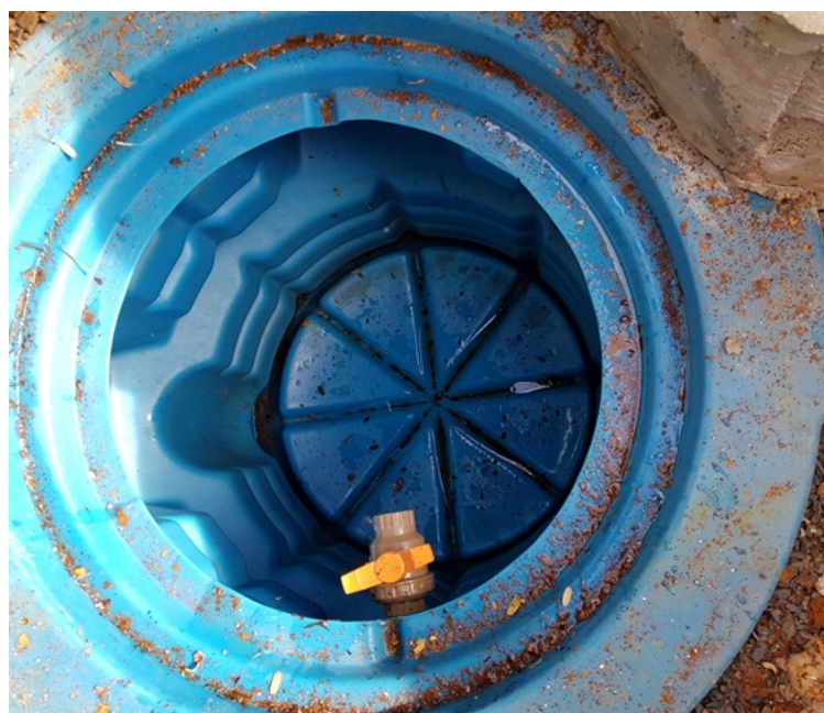
Foto 20 - Caixa coletora de óleo
