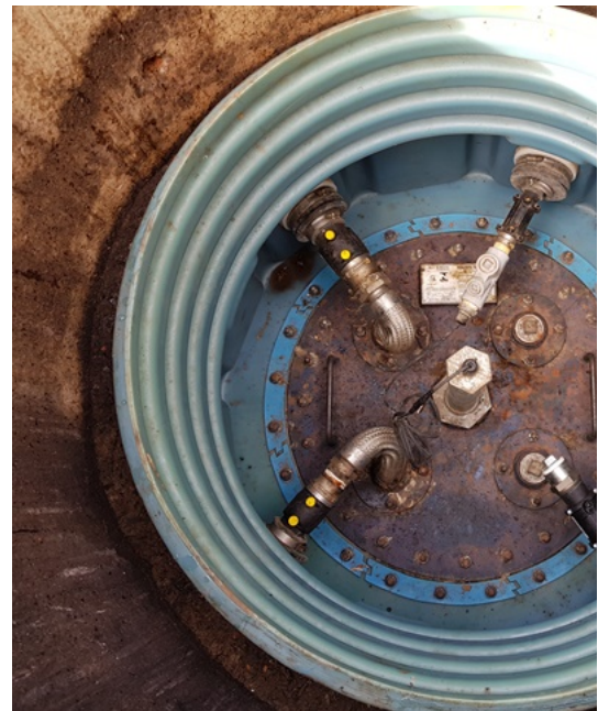
Foto 10 - Câmaras de contenção nos acessos às bo
