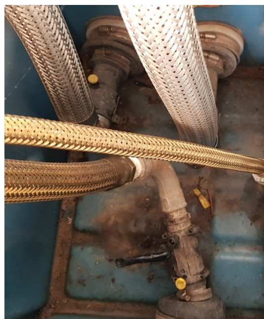
Foto 13 - Câmara de contenção - Sump de bomba, n
