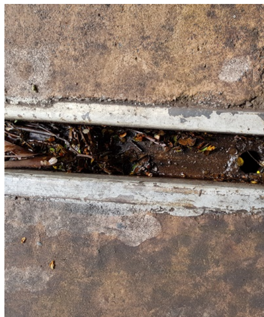
Foto 04 - Canaleta em volta da descarga sobre um dos tanques a passagem
