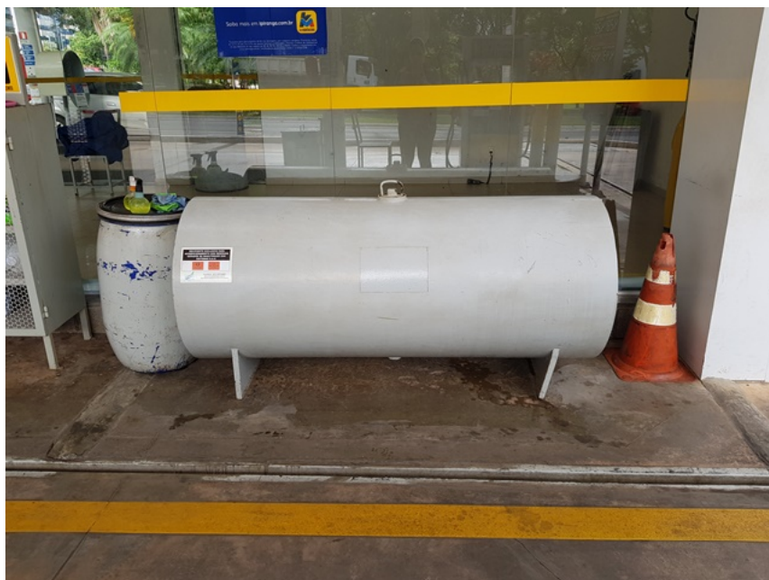
Foto 20 - Tanque de OLUC, dentro da pista de abastecimento
