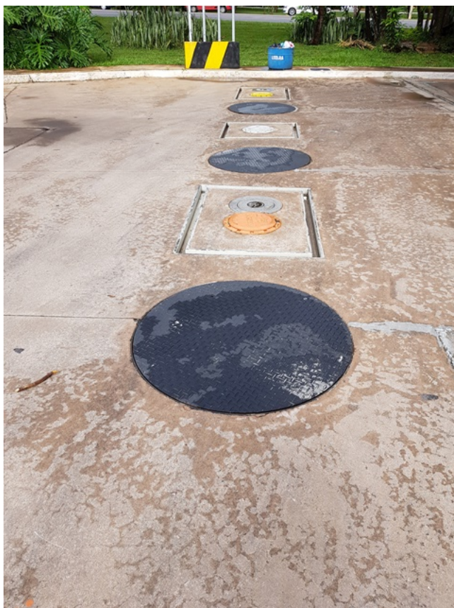
Foto 01 - Tanques em um dos lados do posto sendo, 01 (um) pleno de 15 m 3 e 01 (um) bipartido de 30 m 3
