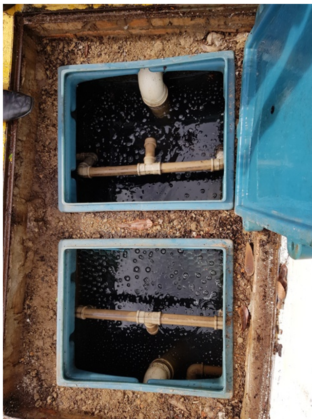
Foto 18 - Caixa separadora de água e óleo, em bom estado de manutenção
