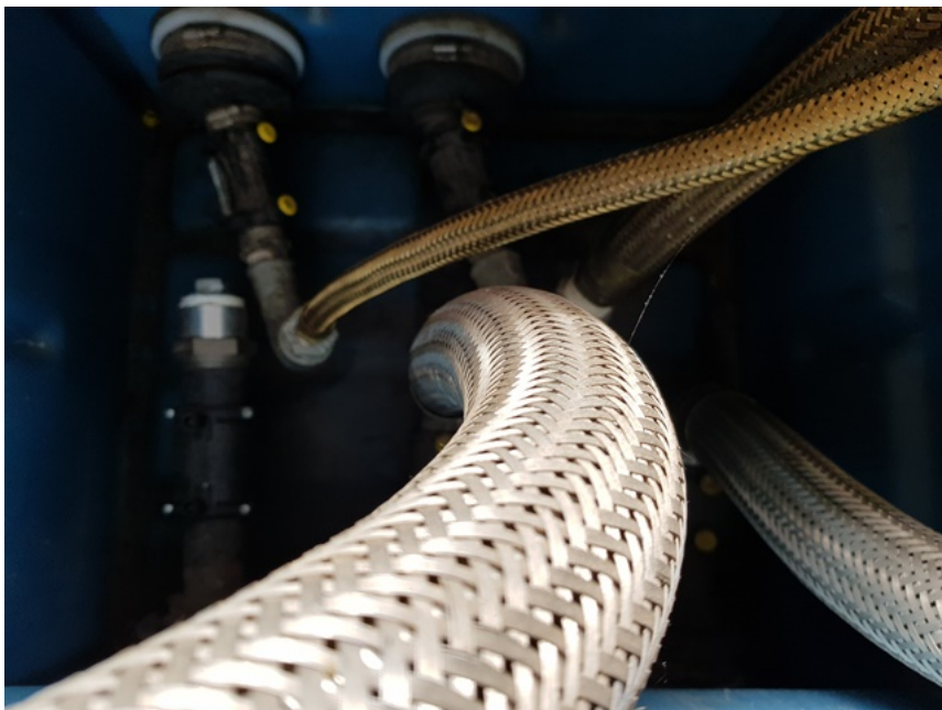
Foto 14 - Tubulação contida corretamente no Sump de bomba
