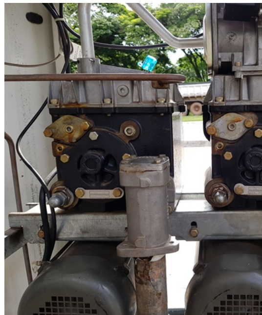
Foto 15 - Válvulas de retenção – C
