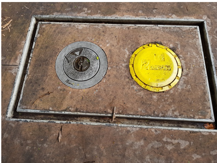
Foto 03 - Descarga selada sobre o tanque, com canaletos ao seu redor com restos de folhas
