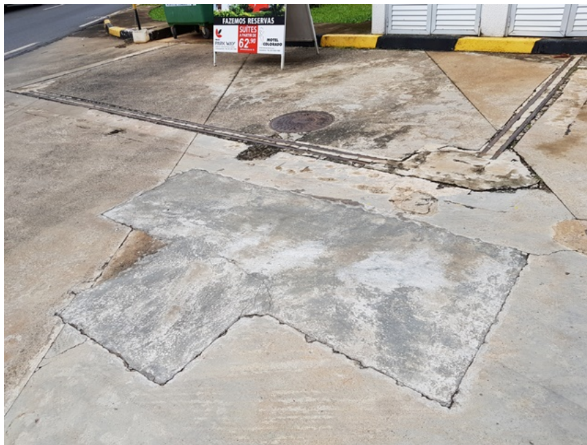
Foto 16 - Área de lavagem desativada e marcas do antigo S.A.O desta área
