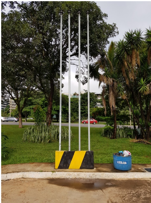
Foto 09 - Respiros dos tanques, todos com terminal corta-chamas
