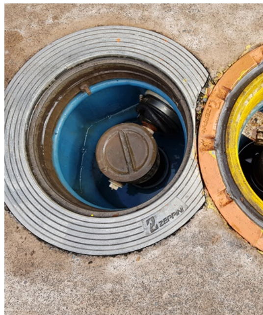
Foto 06 - Válvula anti-transbordamento e monit
