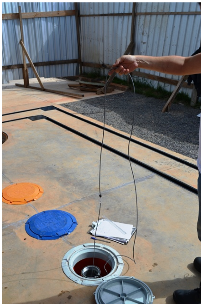
Figura 15 - Verificação no local do Monitoramento do interstício de um dos SASC.
