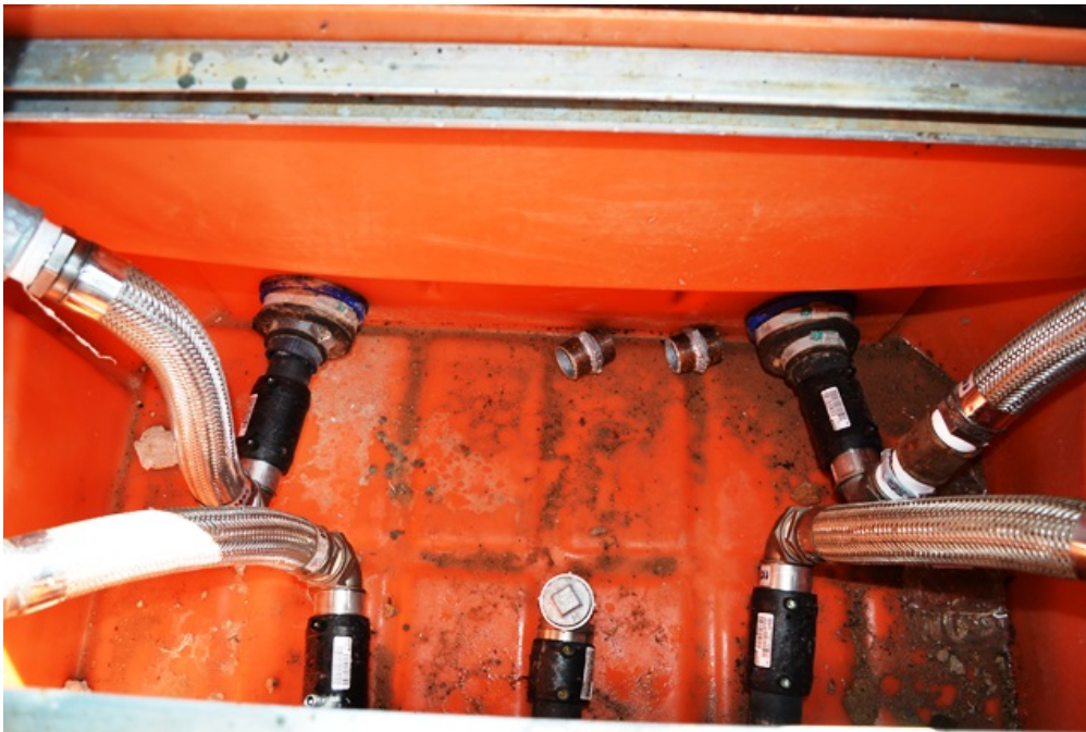
Figura 7 - Detalhe interno da Câmara de contenção da unidade de filtragem de óleo Diesel. Observa-se que a tubulação esta totalmente contida no sump de filtro da câmara de contenção no dispositivo de segurança. O sump das demais unidades necessitam de manutenção operacional diária conforme exige a ABNT NBR 15594-3:2008 tabela 1
