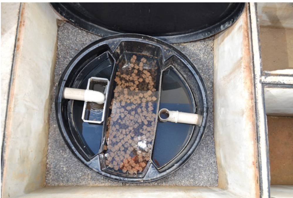
Figura 14 - Aspecto da Caixa Separadora de Água e Óleo - CSAO da pista de Abastecimento.
