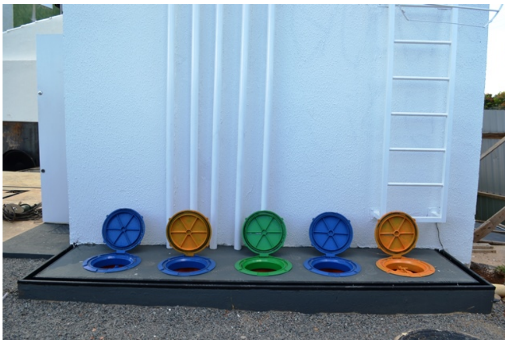
Figura 16 - Aspecto da Descarga selada à distância. Observa-se que o dispositivo é circundado por canaletas direcionadas ao CSAO da pista de abastecimento.
