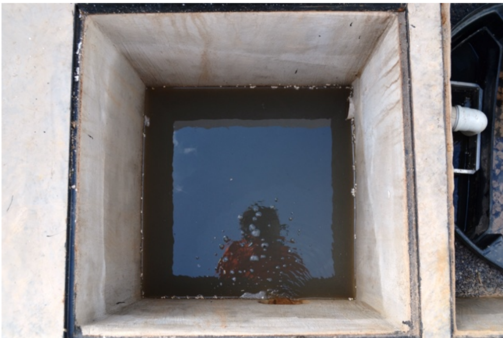
Figura 13 - Aspecto da Caixa de Areia do SAO da pista de Abastecimento.
