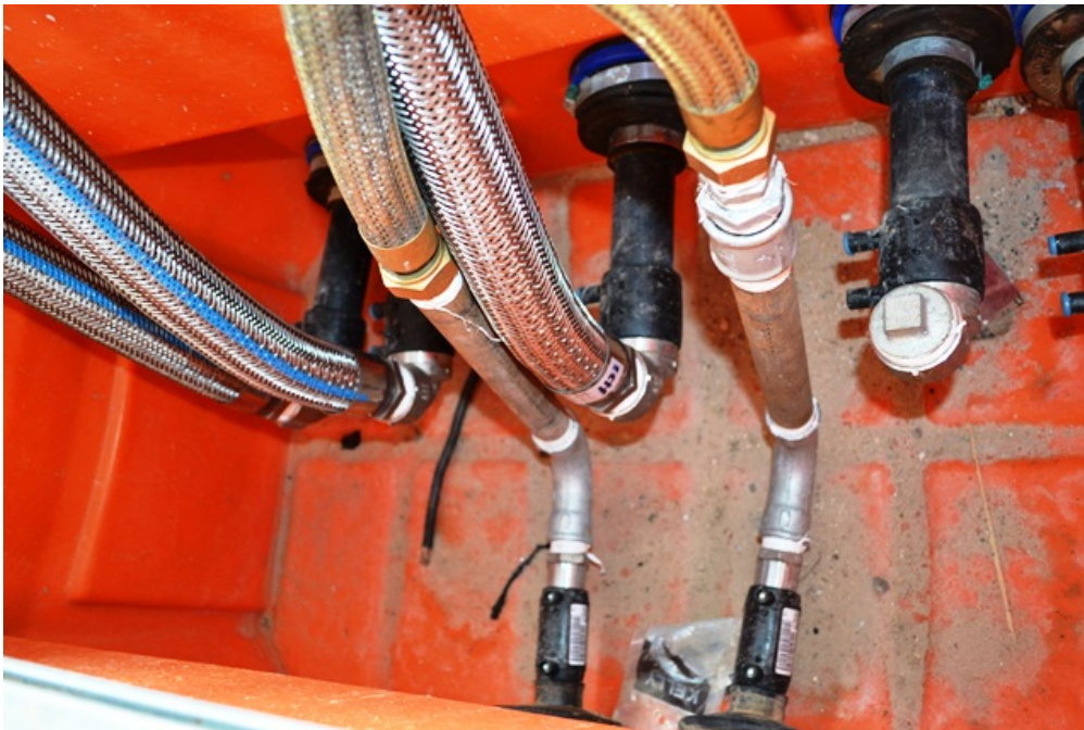
Figura 5 - Detalhe interno da Câmara de contenção de uma das Unidades Abastecedoras do SASC. Observa-se que a tubulação está totalmente contida no sump da câmara de contenção no dispositivo de segurança. Os sumps das demais unidades necessita de manutenção operacional diária conforme exige a ABNT NBR 15594-3:2008 tabela 1
