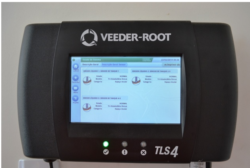
Figura 19 - Sistema de Monitoramento Ambiental. Observa-se que o sistema opera de forma correta (luz verde) conforme exige a ABNT NBR 15594-3:2008 tabela 1.
