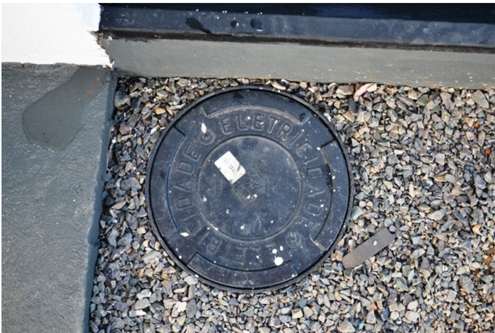
Figura 17 - Aspecto do aterramento ao lado da Descarga selada à distância.
