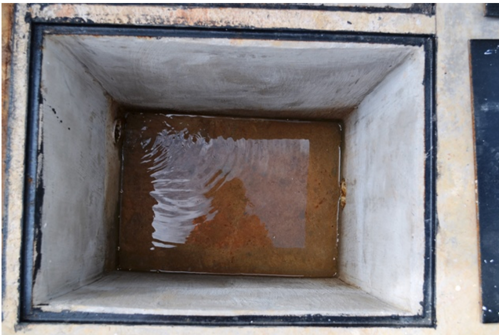
Figura 14 - Aspecto da caixa de amostragem de efluentes do SAO da pista de Abastecimento.
