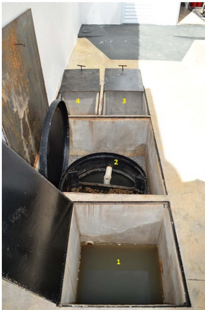
Figura 12 - Aspecto geral do Separador de Água e Óleo da área do lava Jato. O sistema possui Caixa de areia (nº1), Caixa separadora de água de óleo (nº2), caixa coletora de óleo e caixa de amostragem de efluentes (nº3) e caixa coletora de óleo (nº4). O sistema quando entrar em operação deverá realizar manutenção operacional semanal conforme exige a ABNT NBR 155943:2008 tabela 1.
