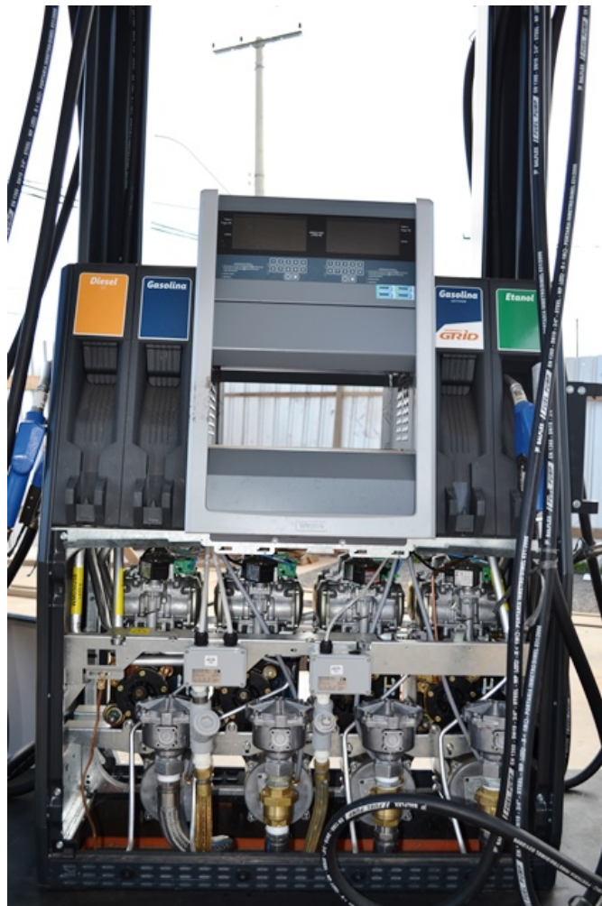
Figura 3 - Unidade abastecedora de Gasolina Comum, Diesel e Etanol com o dispositivo de segurança check-valve , observa-se que a tubulação está limpa e totalmente contida na câmara de contenção para unidade da bomba. A unidade necessita de manutenção operacional diária conforme exige a ABNT NBR 15594-3:200 tabela 1.
