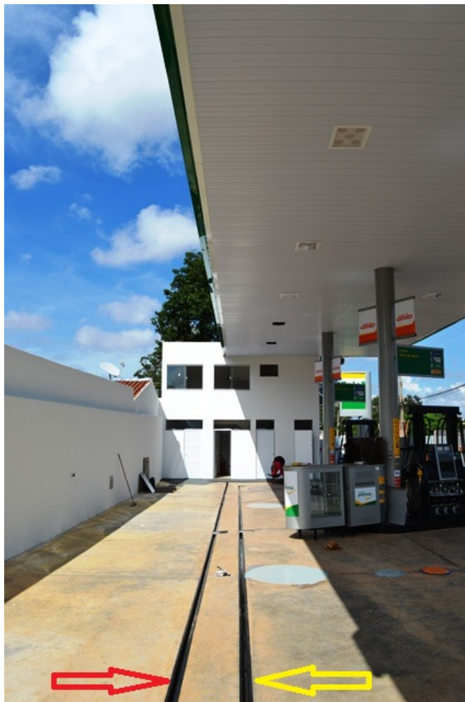
Figura 8 - Canaletes Internos ( seta amarela ) do Sistema de Drenagem Oleosa - SDO com recuo interno de 0,5 metros conforme exige a ABNT NBR 14.605-2:2010 item 4 e externos ( seta vermelha ) do Sistema de drenagem de águas pluviais da pista de abastecimento
