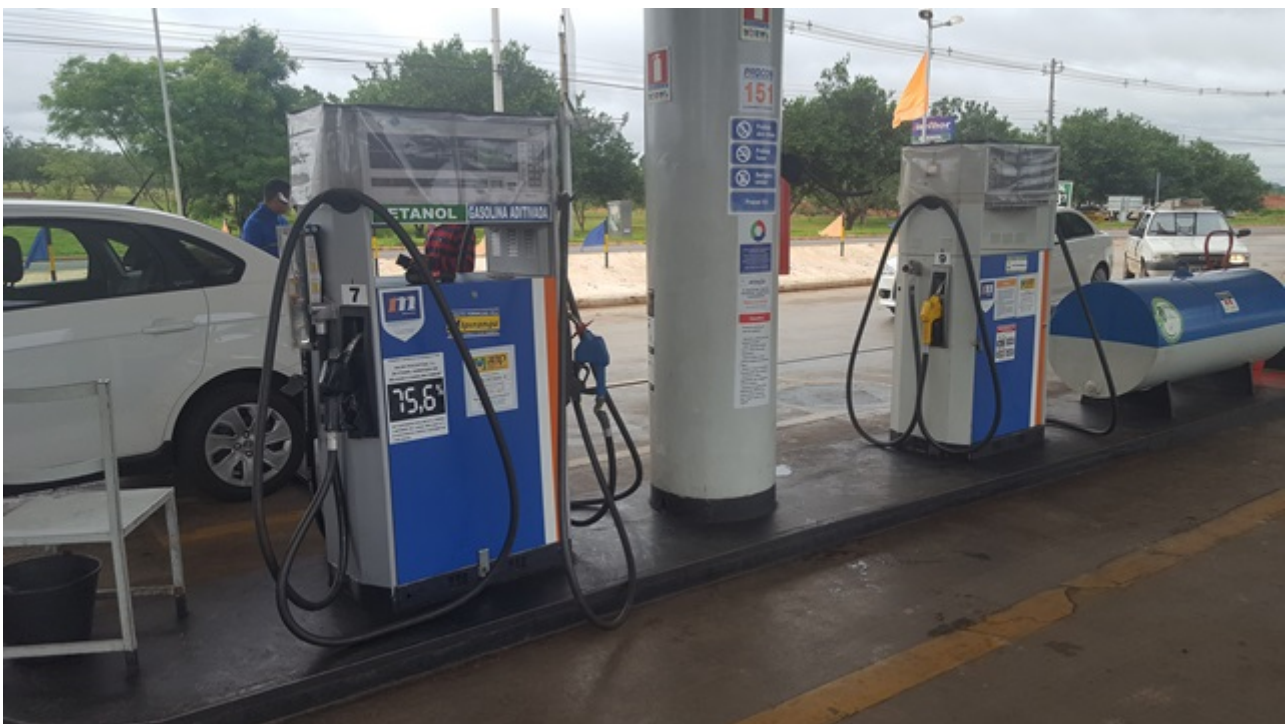
Figura 2: Pista de abastecimento com unidades abastecedoras.
