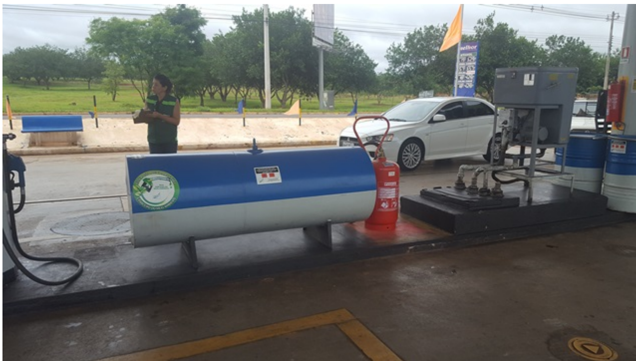
Figura 4: Tanque de OLUC e filtro de diesel localizados na pista de abastecimento.
