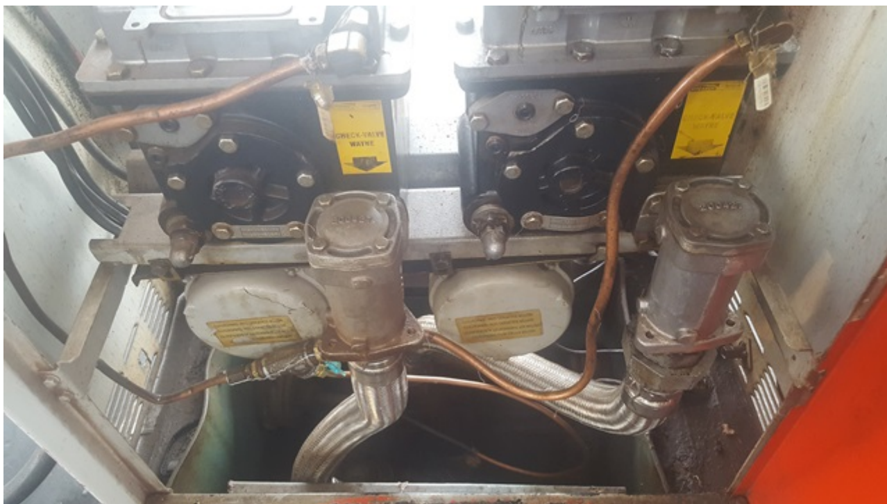
Figura 3: Unidade abastecedora com sump e chek valve.
