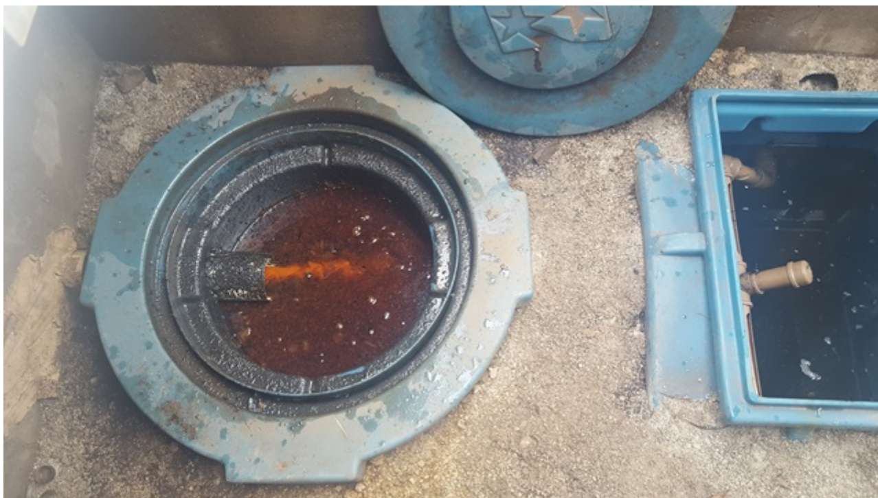
Figura 7: Caixa de areia do S.A.O. Observa-se o corante que serviu de teste para verificar eficiência da ligação dos canaletos ao S.S.A.O.
