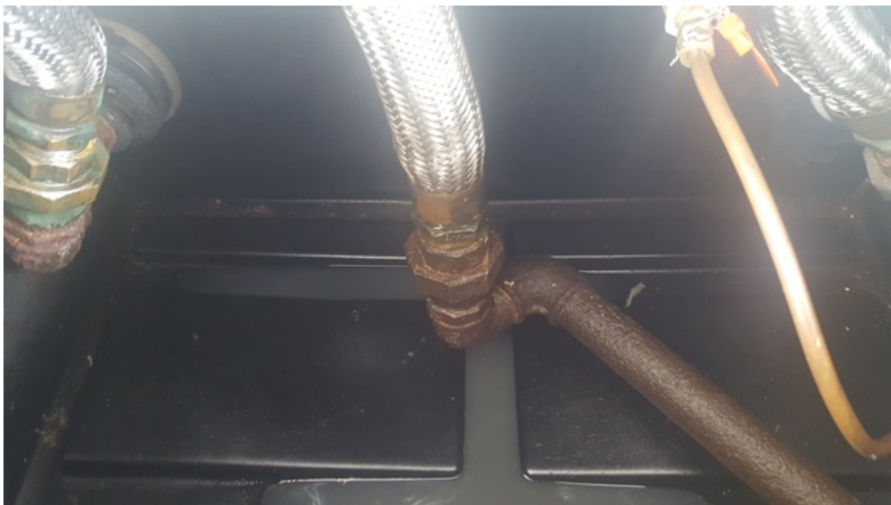
Figura 6: Câmara de contenção (Sump) do filtro de diesel em bom estado de manutenção.
