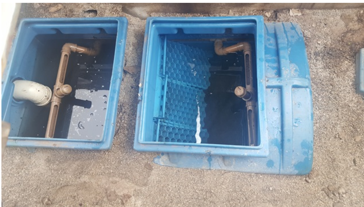
Figura 8: Caixa separadora com presença de placa coalescente do S.A.O.
