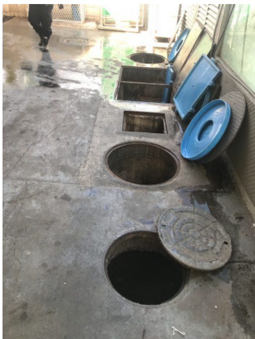
Foto 7. SAO da área de lavagem,
