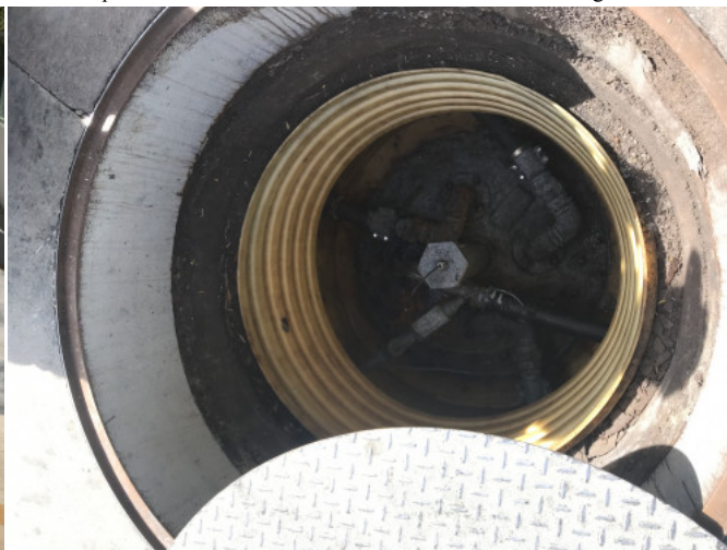
Foto 6. Câmara de acesso ao tanque.
