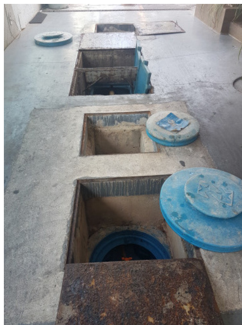
Foto 8. SAO da pista de abastecimento.
