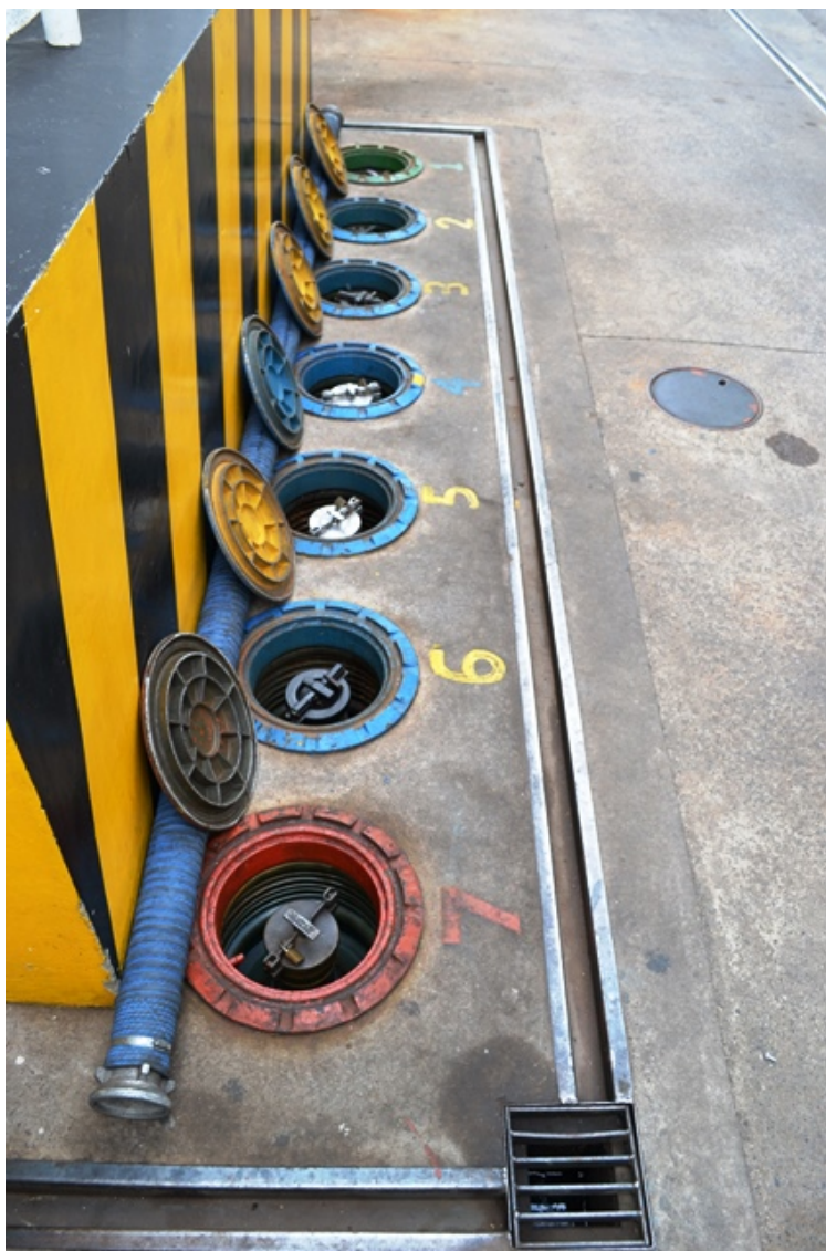
Figura 5 - Descarga selada à distância. Observa-se que o dispositivo é circundado por canaletas direcionados ao SAO exclusivo da pista de abastecimento.
