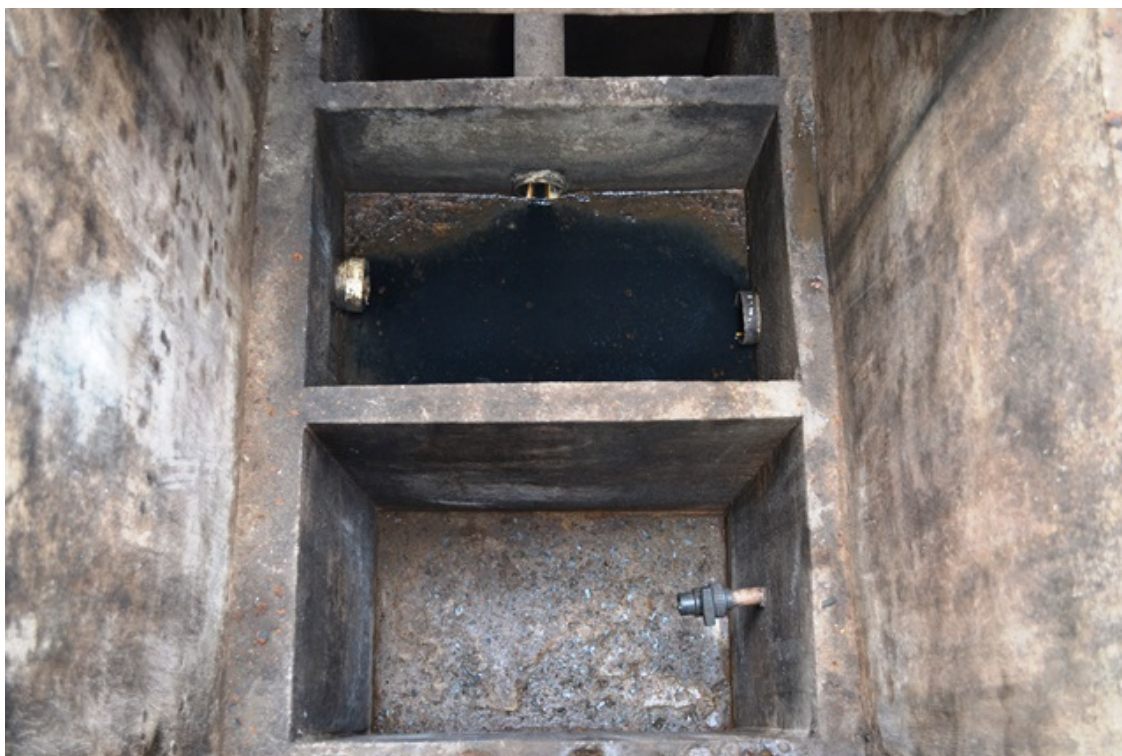
Figura 41 - Caixa de amostragem de efluentes (acima) e caixa coletora de óleo (abaixo) do SAO da área de abastecimento e manutenção e lubrificação. A caixa de amostragem de efluentes não possui a queda de 15 cm no qual é exigida na ABNT NBR 14.605-2:2010.
