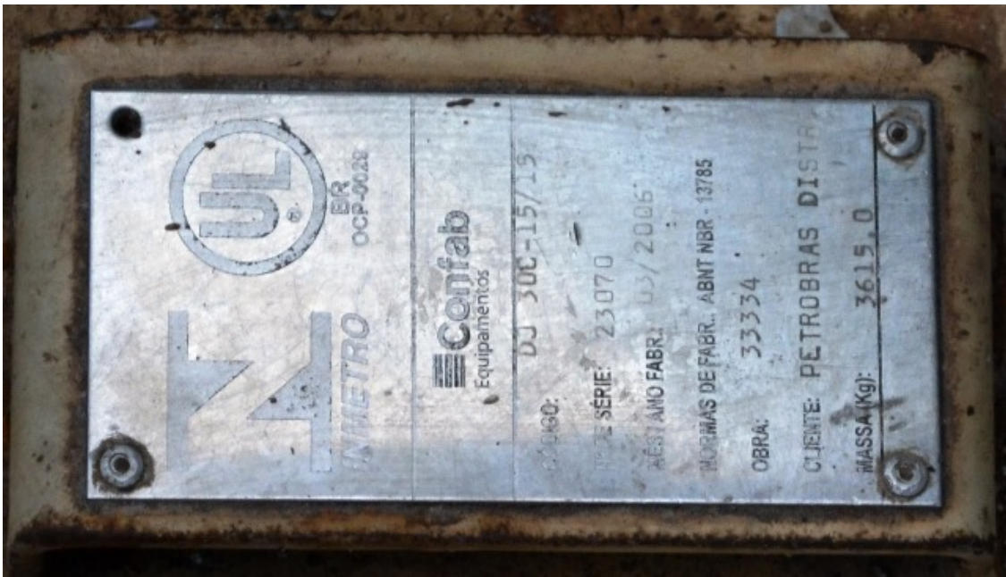
Figura 4 - Placa de identificação de um dos 4 SASC datados de 03/2006
