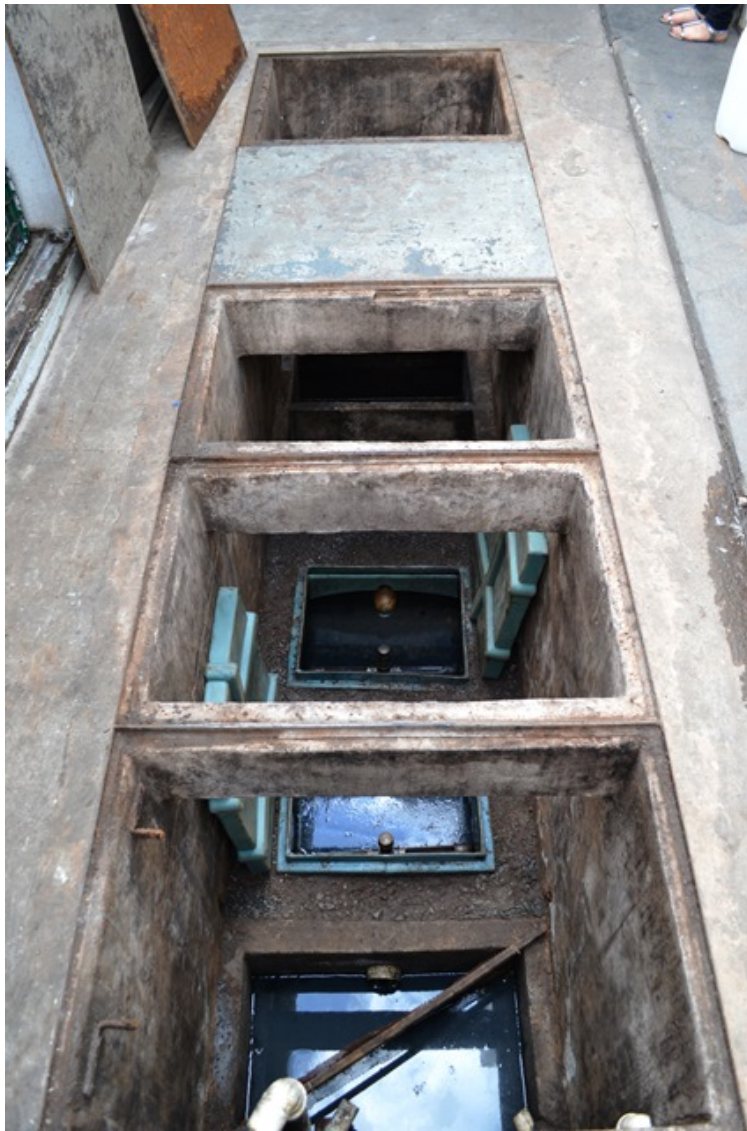
Figura 40 - Aspecto geral do Sistema Separador de Água e Óleo da pista de Abastecimento e da área de manutenção e lubrificação.
