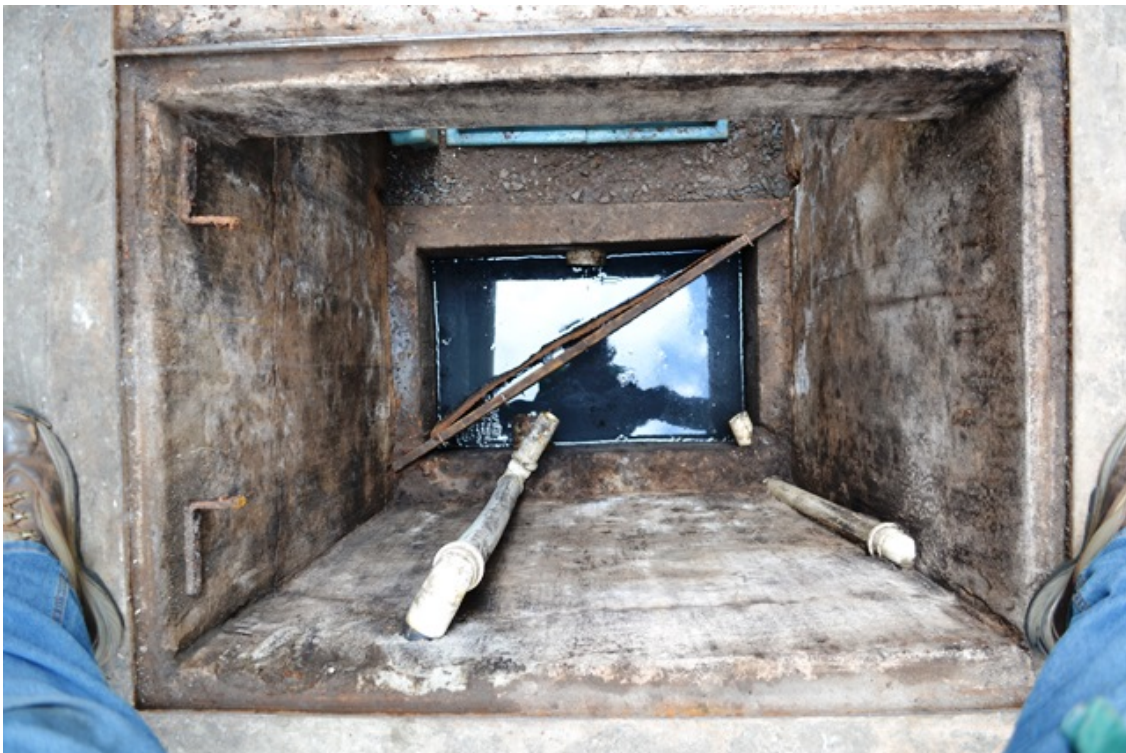
Figura 40 - Aspecto da Caixa de areia do Sistema Separador de Água e Óleo da pista de
