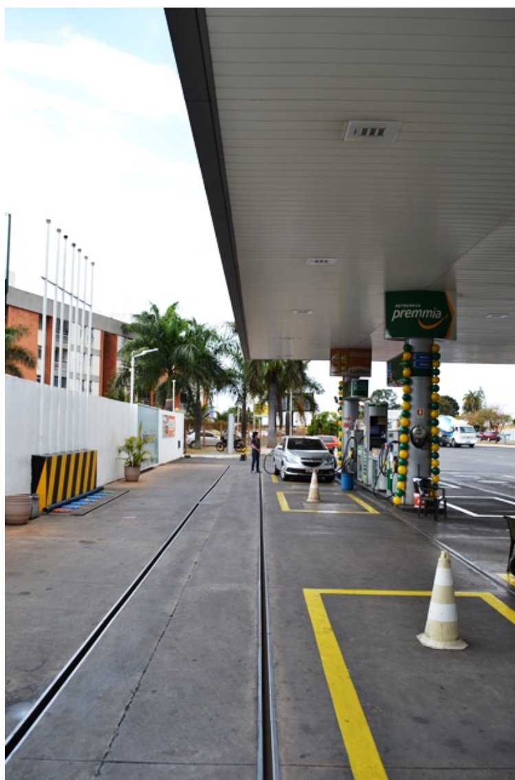
Figura 7 - Canaletes Internos do Sistema de Drenagem Oleosa - SDO e externas da drenagem de águas pluviais da pista de abastecimento com recuo interno de 0,5 metros conforme exige o item
