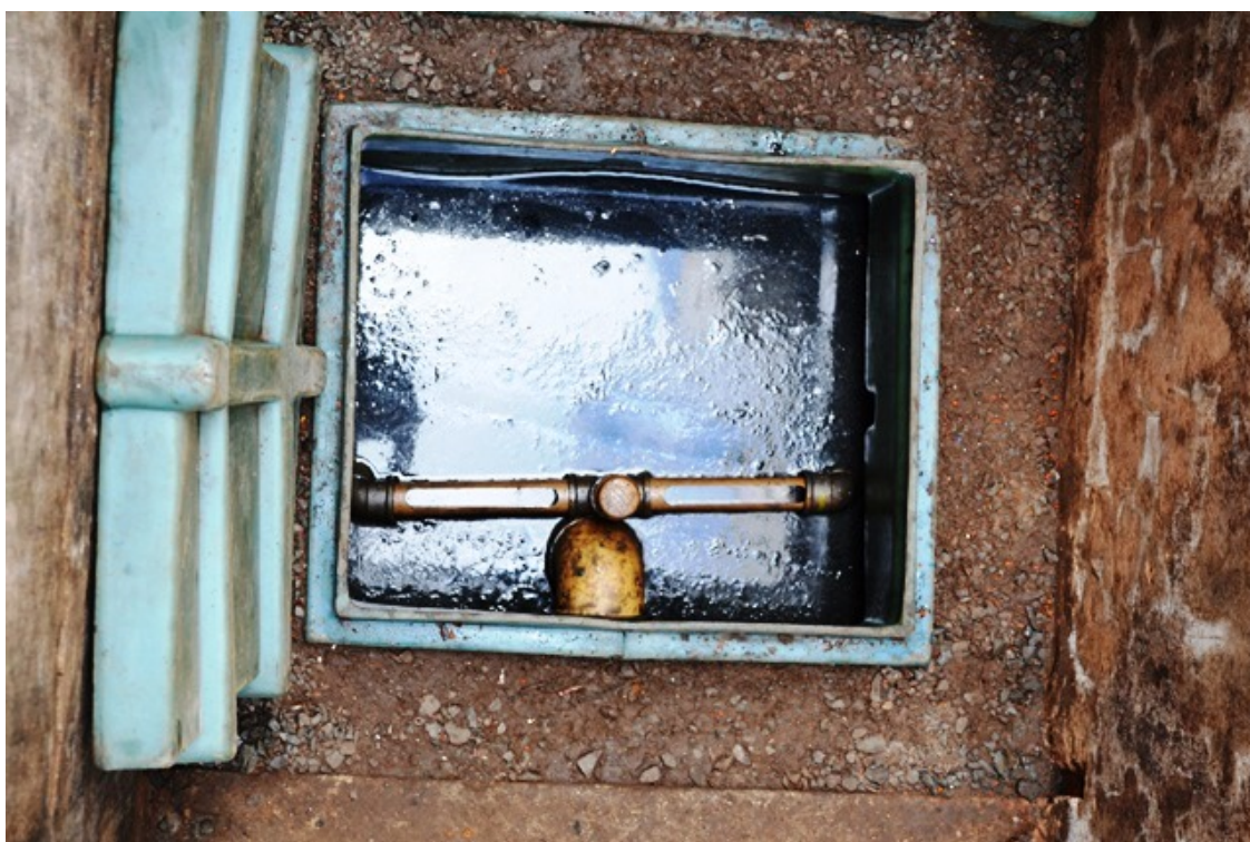
Figura 41 - Aspecto de um dos compartimentos da Caixa Separadora de Água e Óleo - CSAO do SAO da pista de abastecimento. O sistema instalado necessita de manutenção operacional semanal conforme exige a tabela 1 da ABNT NBR 15594-3:2008.
