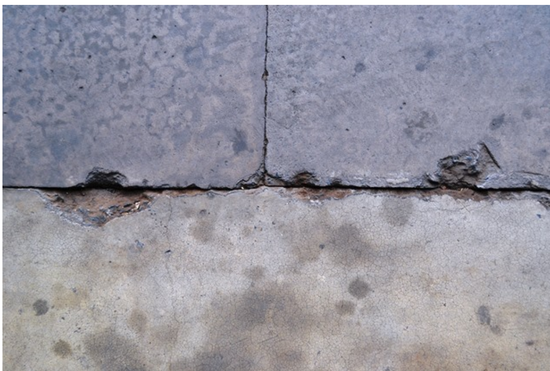
Figura 9 - Superfície da pista de abastecimento com trincas próxima a uma unidade abastecedora.
