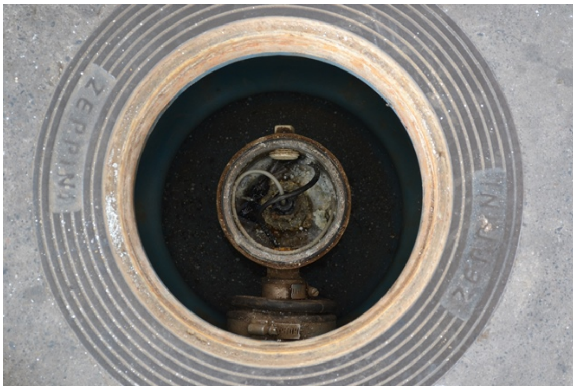
Figura 6 - Detalhe da câmara de contenção interna do Monitoramento do interstício. Observa-se
