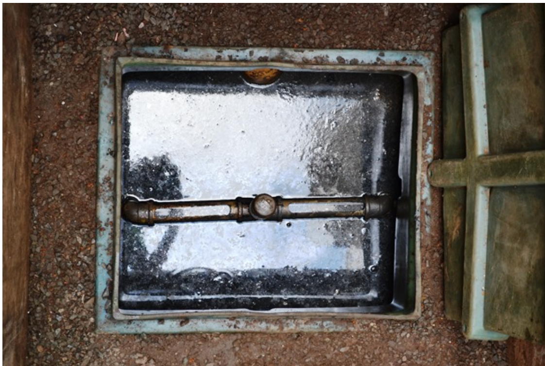
Figura 40 - Aspecto de um dos compartimentos da Caixa Separadora de Água e Óleo - CSAO do SAO da pista de abastecimento e da área de manutenção e lubrificação. O sistema instalado necessita de manutenção operacional semanal conforme exige a tabela 1 da ABNT NBR 15594-3:2008.
