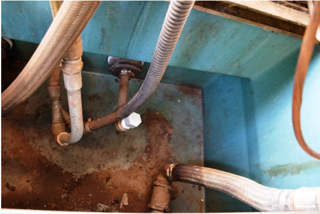
Figura 5 - Detalhe interno da Câmara de contenção de uma das Unidades Abastecedoras do SASC. Observa-se que a tubulação esta totalmente contida no sump da câmara de contenção no dispositivo de segurança. Os sumps das demais unidades necessita de manutenção operacional diária conforme exige a tabela 1 da ABNT NBR 15594-3:2008
