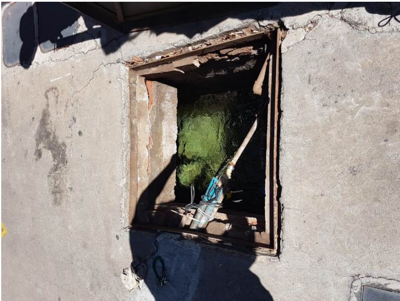
Figura 23 - Poço artesiano e cisterna de água para utilização na atividade de lavagem de veículos, observou-se cheiro de combustível próximo a cisterna.
