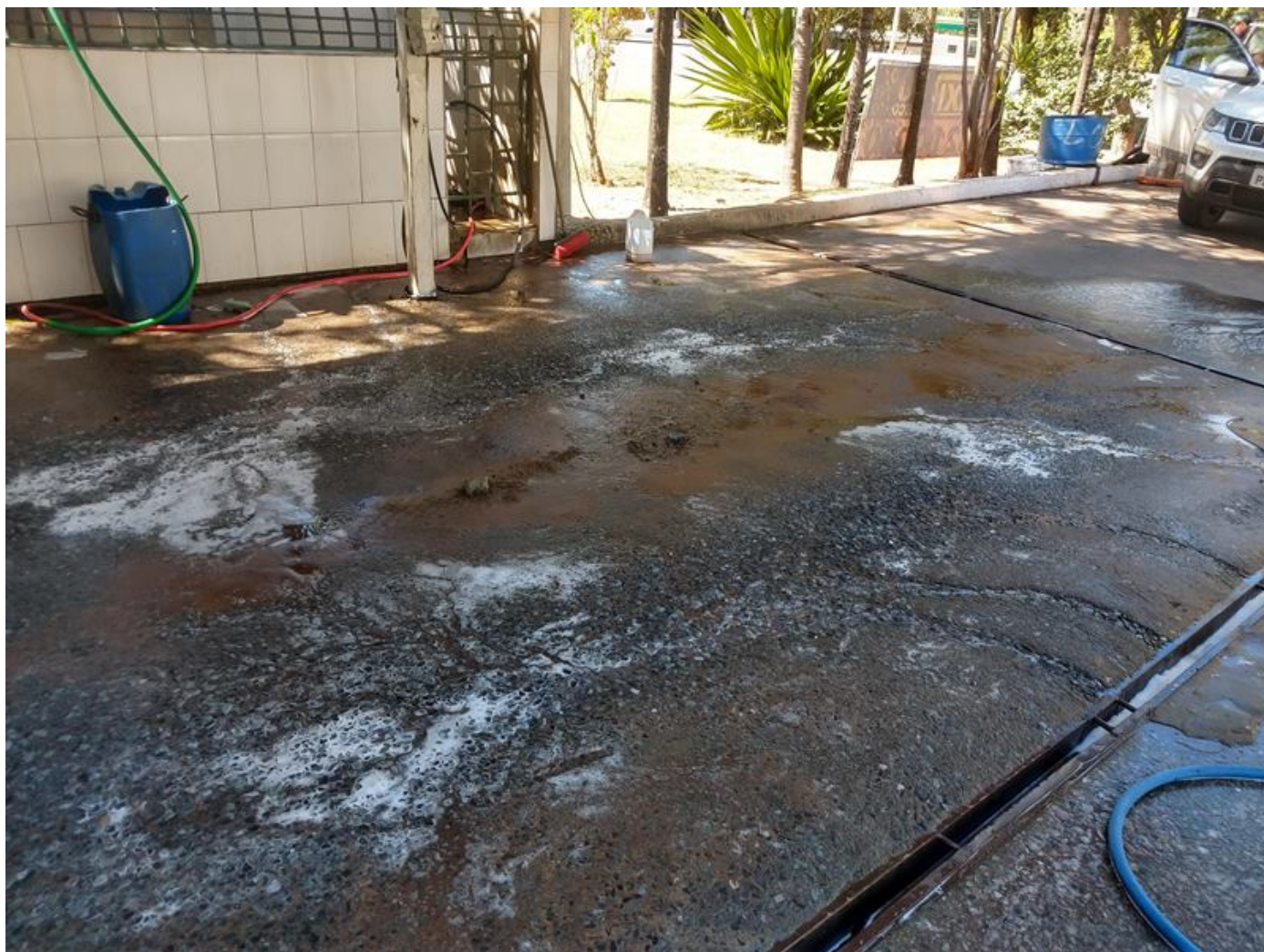
Figura 21 - Segundo espaço destinado a lavagem de veículos, cercado por canaletas porém sem caixa de areia central.
