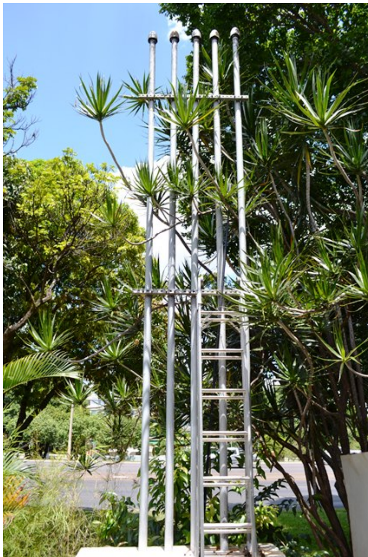
Figura 7 - Respiros com terminal corta chamas. Observa-se a presença de alguns indivíduos arbóreos no entorno das unidades, em desacordo com que é exigido no item 8.3.4 ABNT NBR 13783:2014.
