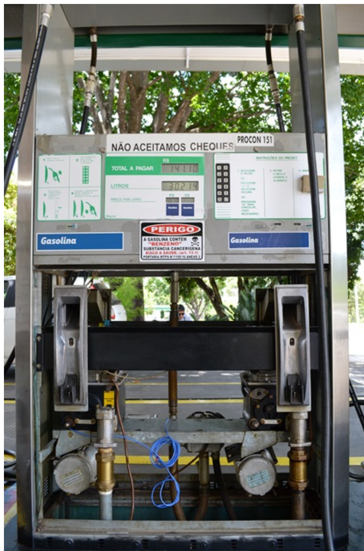
Figura 3 - Unidade abastecedora de Gasolina Comum com o dispositivo de segurança check-valve , observa-se que a tubulação está limpa e totalmente contida na câmara de contenção para unidade da bomba. A unidade necessita de manutenção operacional diária conforme exige a tabela 1 da ABNT NBR 15594-3:2008
