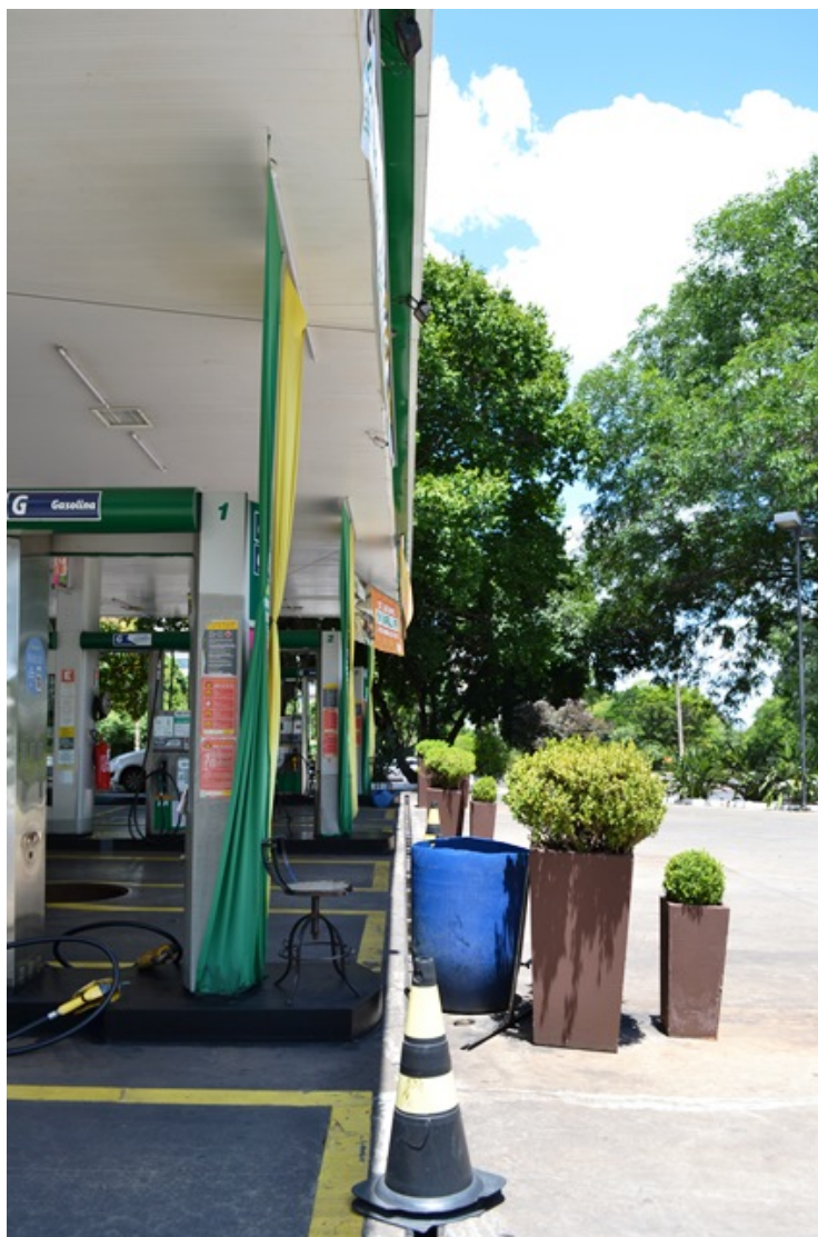
Figura 6 - Canaletes Internos do Sistema de Drenagem Oleosa - SDO da pista de abastecimento sem o recuo interno de 0,5 metros conforme exige o item 4, da ABNT NBR 14.605-2:2010
