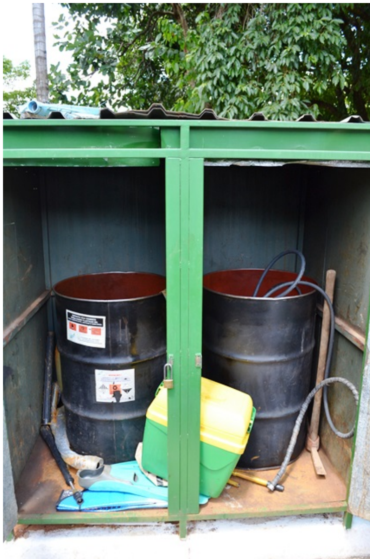
Figura 16 - Aspecto do local indicado para o acondicionamento de resíduos perigosos classe I. Observa-se que o local é coberto mas não é circundado por canaletes o que denota que não está de acordo com o que é exigido na NBR 12235 item 4.1.1.
