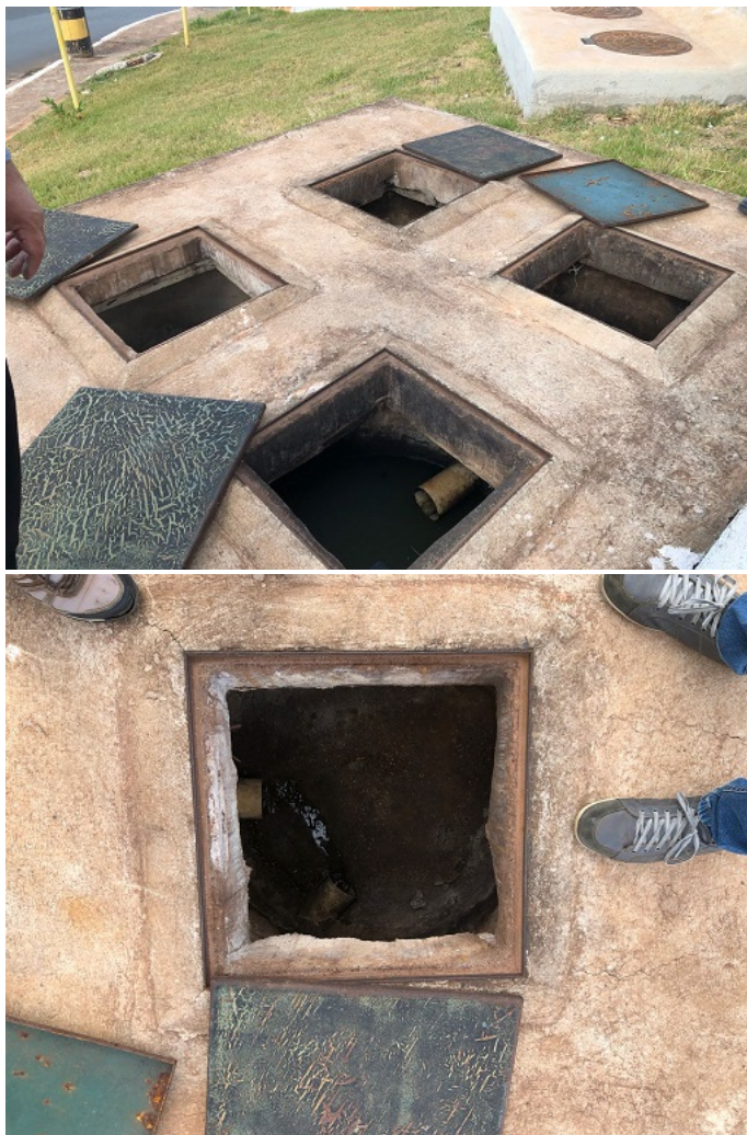
Figura 5 - SAO da pista de abastecimento, com lâmina de óleo sobre o efluente da caixa de inspeção.
