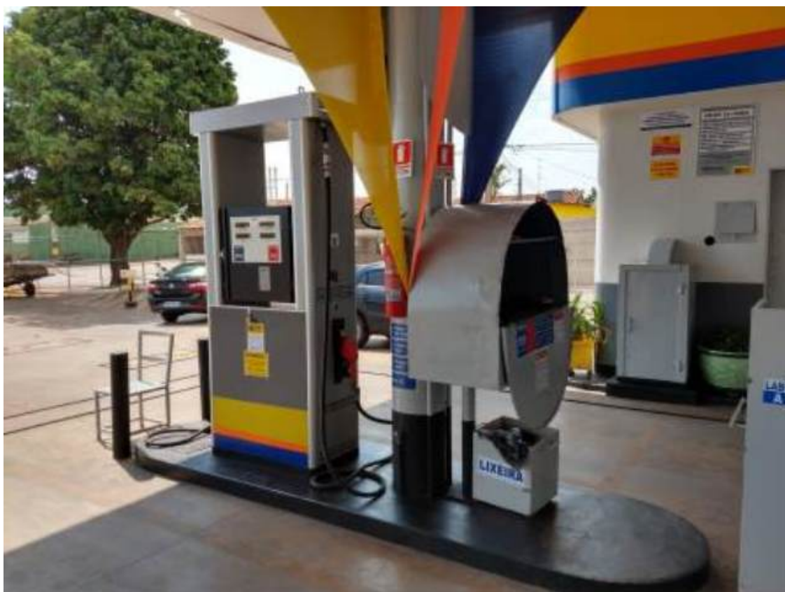
Figura 04 - Ilha com unidade de abastecimento.
