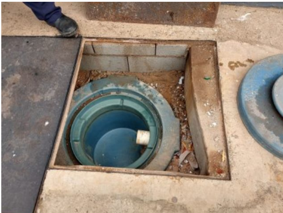
Figura 20 - Módulo para separação de sólidos do sistema separador desativado.
