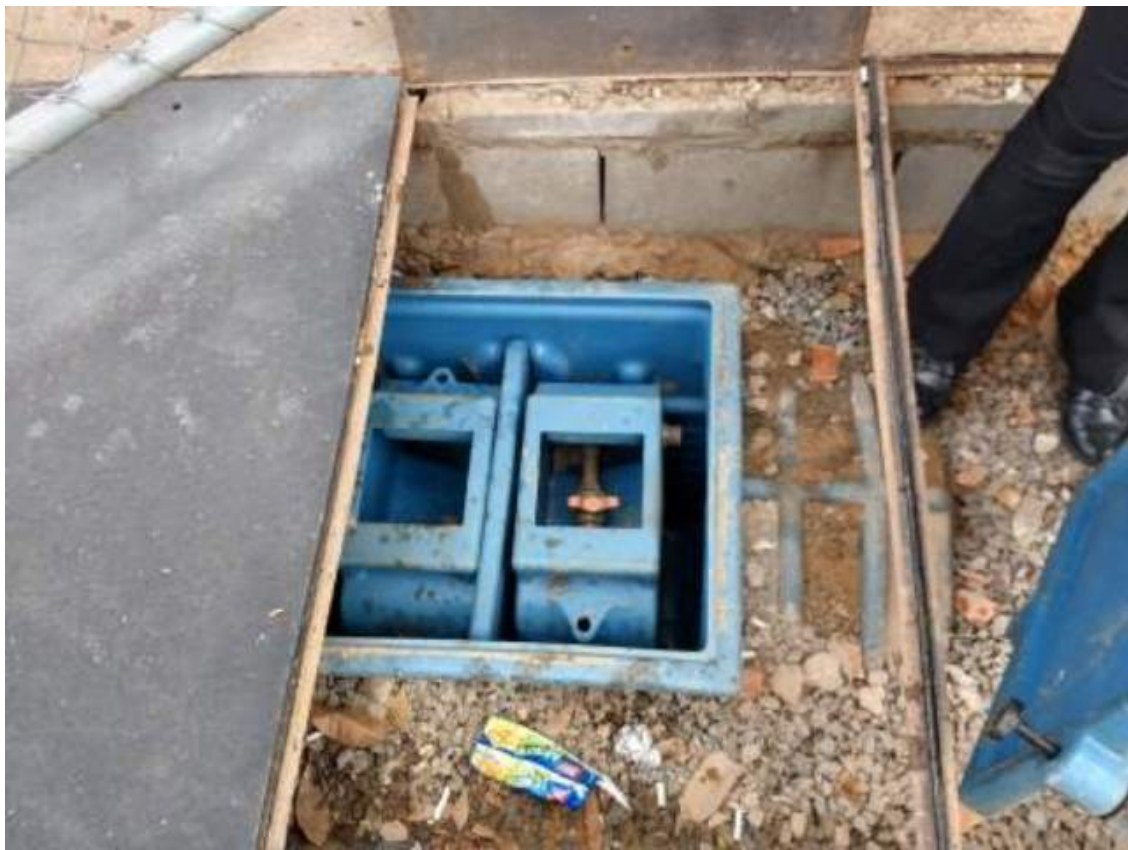
Figura 21 - Caixa separadora de água e óleo do sistema separador desativado.
