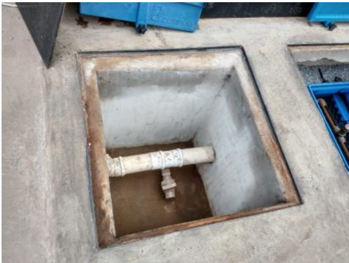
Figura 18 - Caixa de amostragem, em alvenaria.
