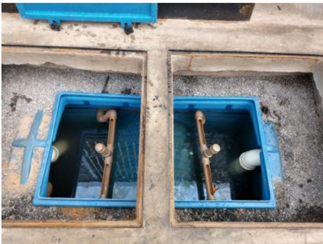
Figura 16 - Caixa separadora de água e óleo.
