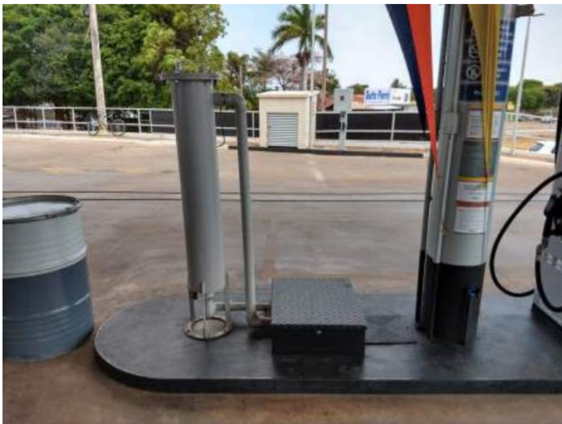
Figura 05 - Unidade filtrante de diesel com câmara de contenção.
