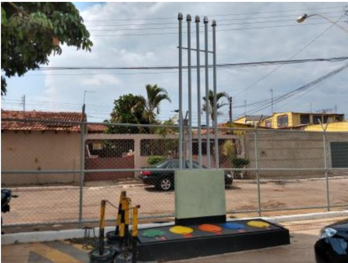
Figura 13 - Local das descargas seladas a distância, circundadas por canaletas direcionadas ao sistema separador. Observa-se cinco respiros para os compartimentos de armazenagem de combustíveis dotados de terminais corta-chamas.
