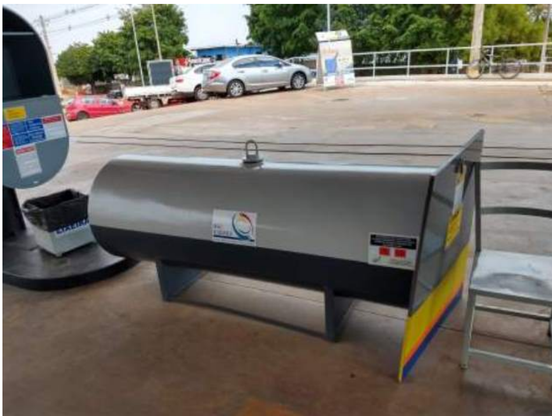
Figura 09 - Tanque de armazenamento de OLUC, dentro da pista de abastecimento, em área cercada por canaletas direcionadas ao sistema separador.
