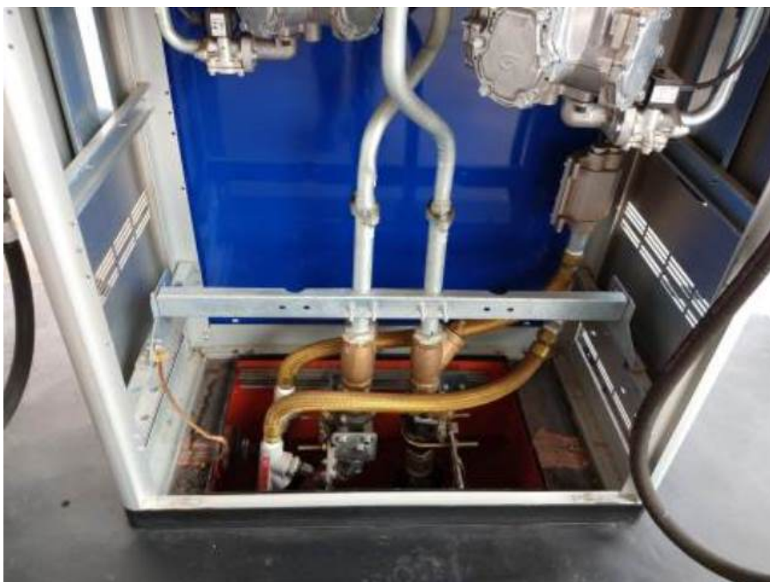
Figura 06 - Câmara de contenção da unidade de abastecimento, observa-se que a tubulação de combustível se encontra dentro da projeção da câmara.
