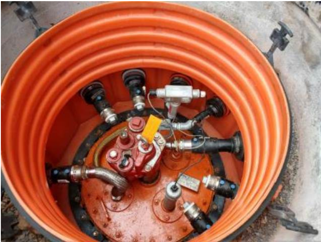
Figura 11 - Câmara de contenção da boca de acesso ao tanque, observa-se a tubulação em PEAD, sensor de controle eletrônico de estoque, sensor de líquidos, equipamento para retirada de combustível e demais tubulações não utilizadas vedadas corretamente.
