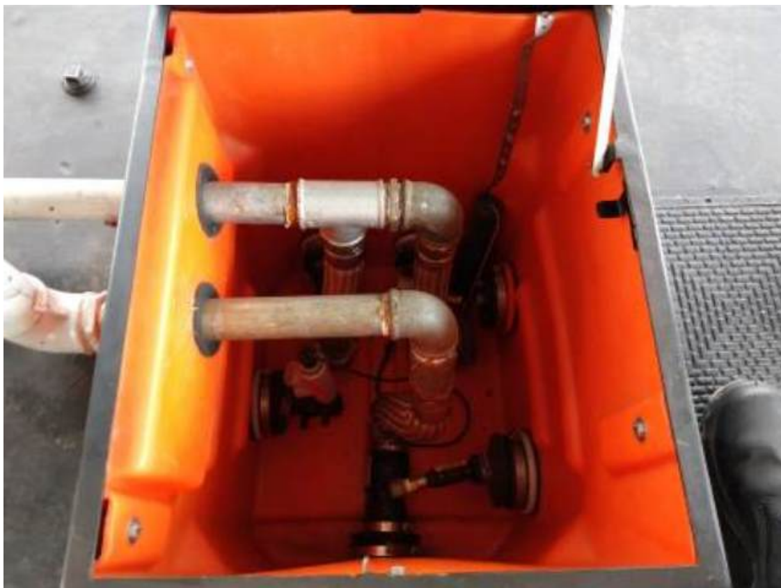
Figura 08 - Tubulação no interior da câmara de contenção da unidade de filtragem, observa-se a boa manutenção do equipamento.
