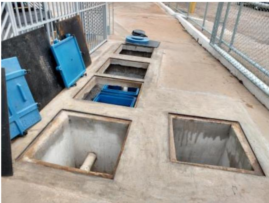
Figura 19 - Visão geral do sistema separador, em funcionamento, composto por quatro caixas.
