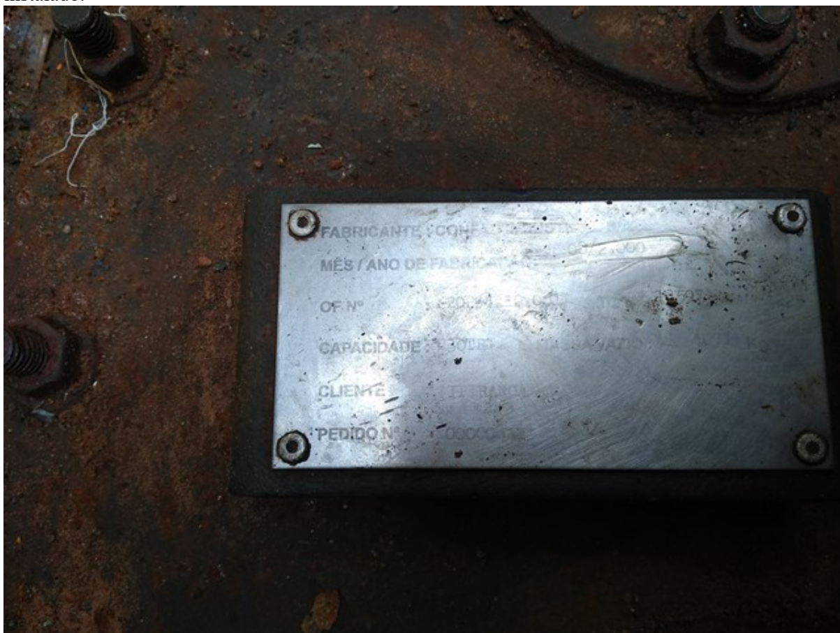
Figura 18 - Placa de identificação do tanque tripartido indicando data de fabricação em 08/2000
