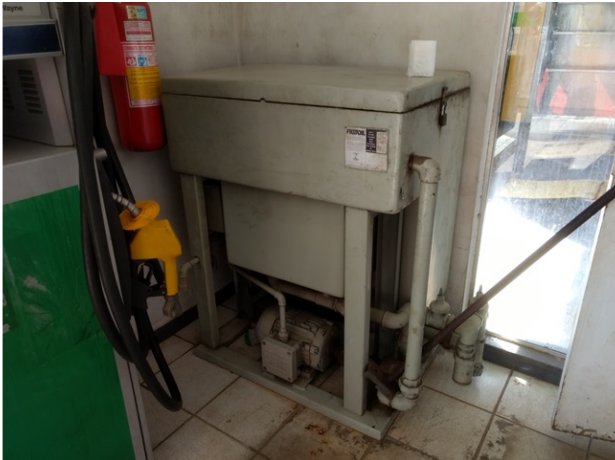
Figura 19 - Filtro de Diesel não utilizado e não instalado.
