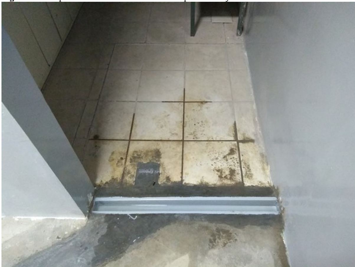
Figura 16 - Interior do depósito da área de troca de óleo e lubrificação com ralo isolado e canaleta instalado.
