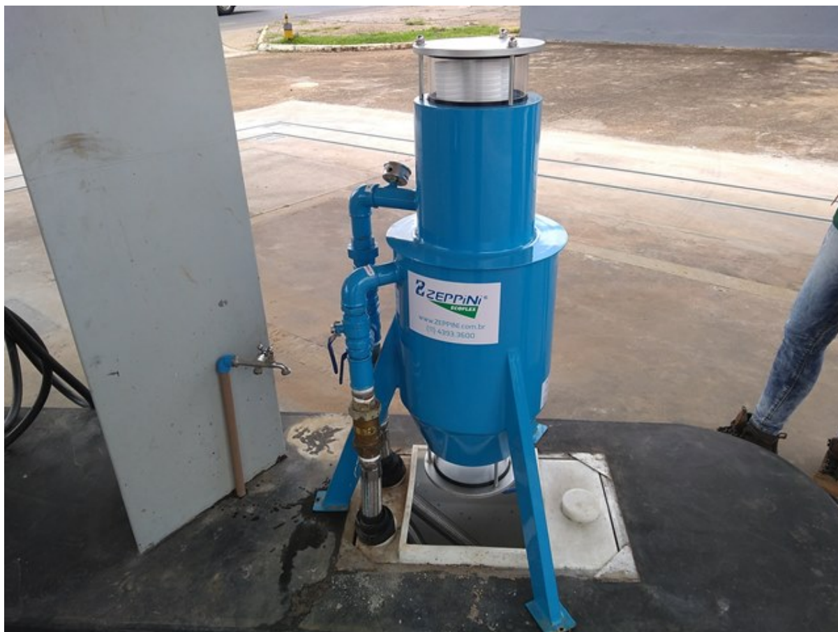
Figura 7 - Filtro de diesel, na pista de abastecimento.
