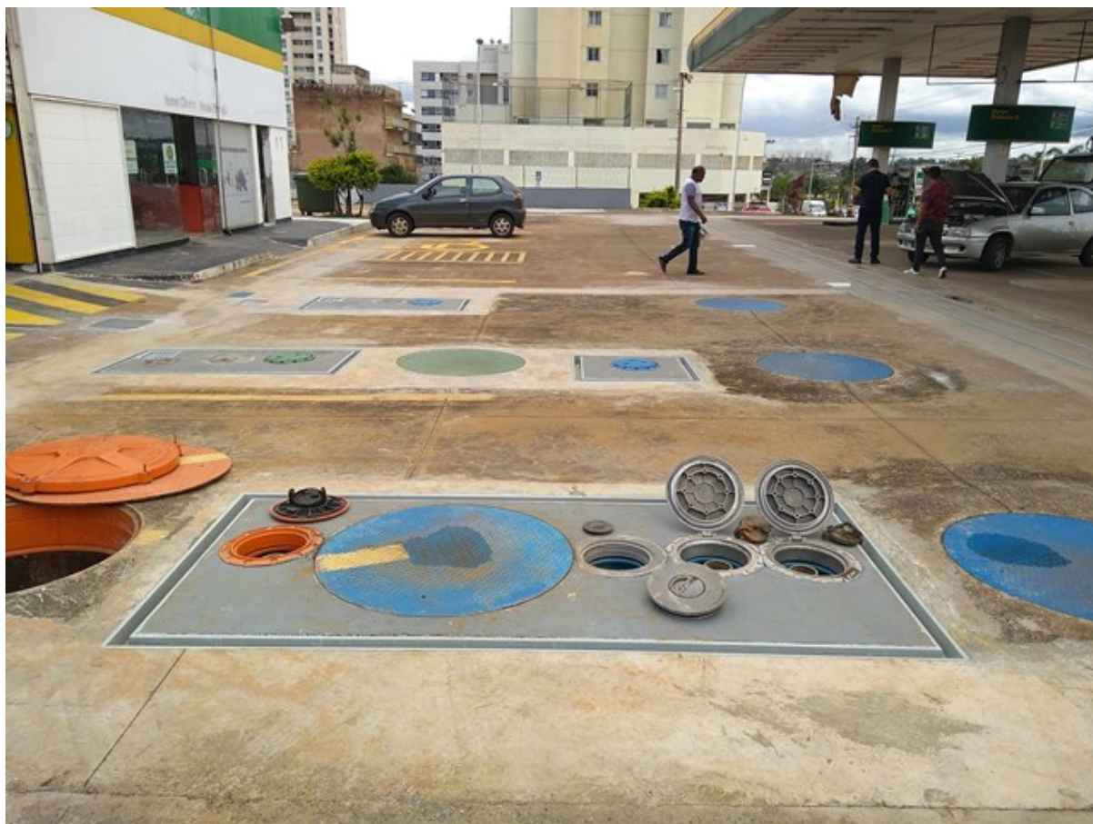
Figura 3 - Área de tanques com canaletes direcionados ao SAO
