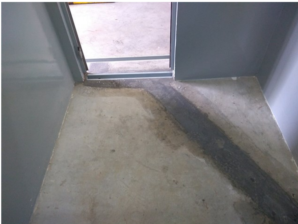
Figura 17 - Interior do depósito da área de troca de óleo e lubrificação com ralo isolado e canaleta instalado.
