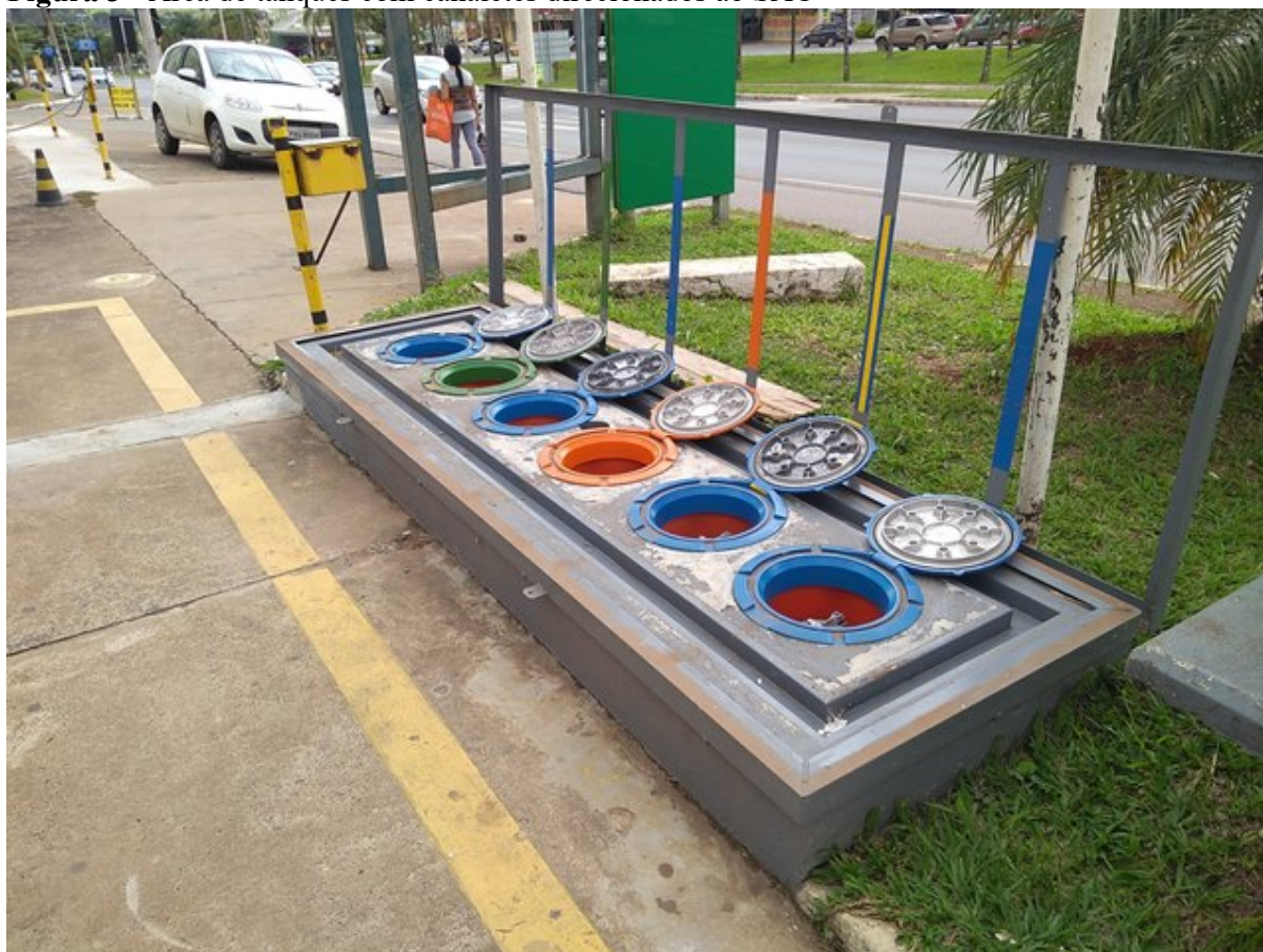
Figura 4 - Descargas seladas a distância, cercadas por canaletes e direcionadas ao SAO.
