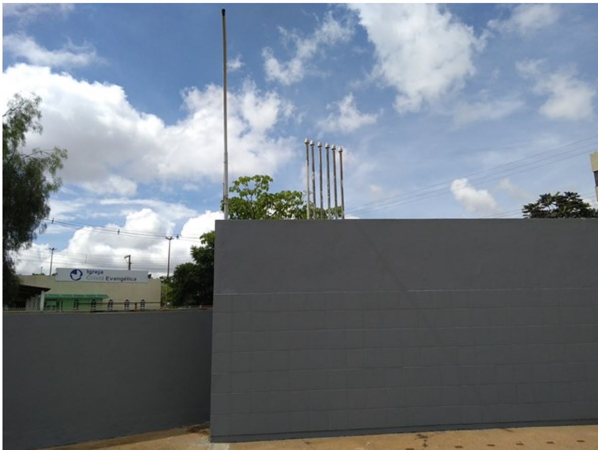
Figura 15 - Respiros com terminal corta-chamas e prédio da loja de conveniência.
