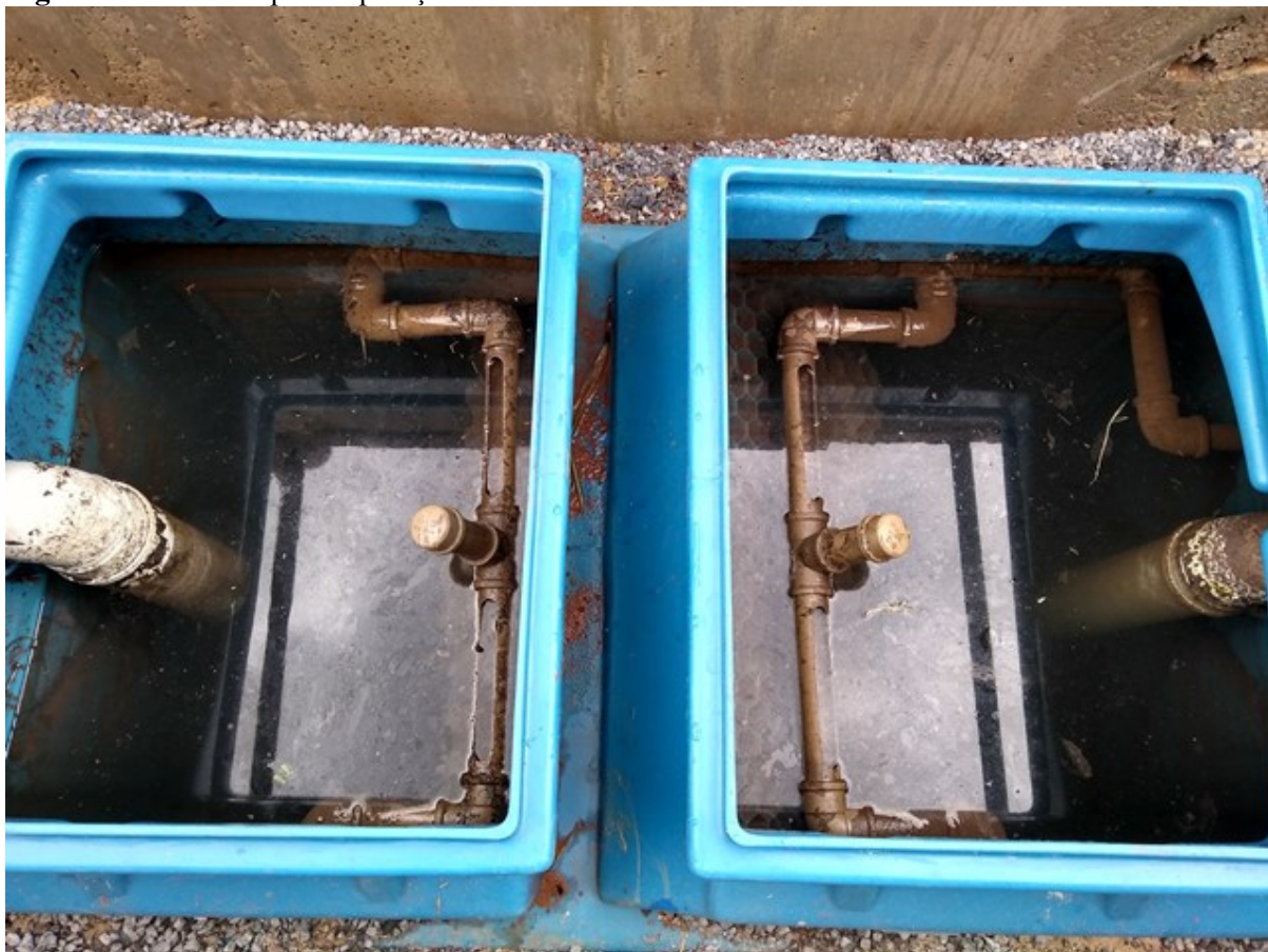
Figura 12 - SAO - Caixa separadora de água e óleo.
