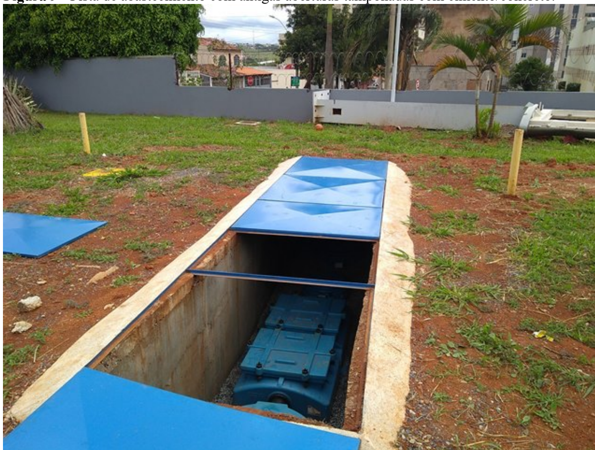
Figura 10 - Sistema separador água e óleo, do tipo pré-moldado, composto por quatro módulos da marca Zeppini.
