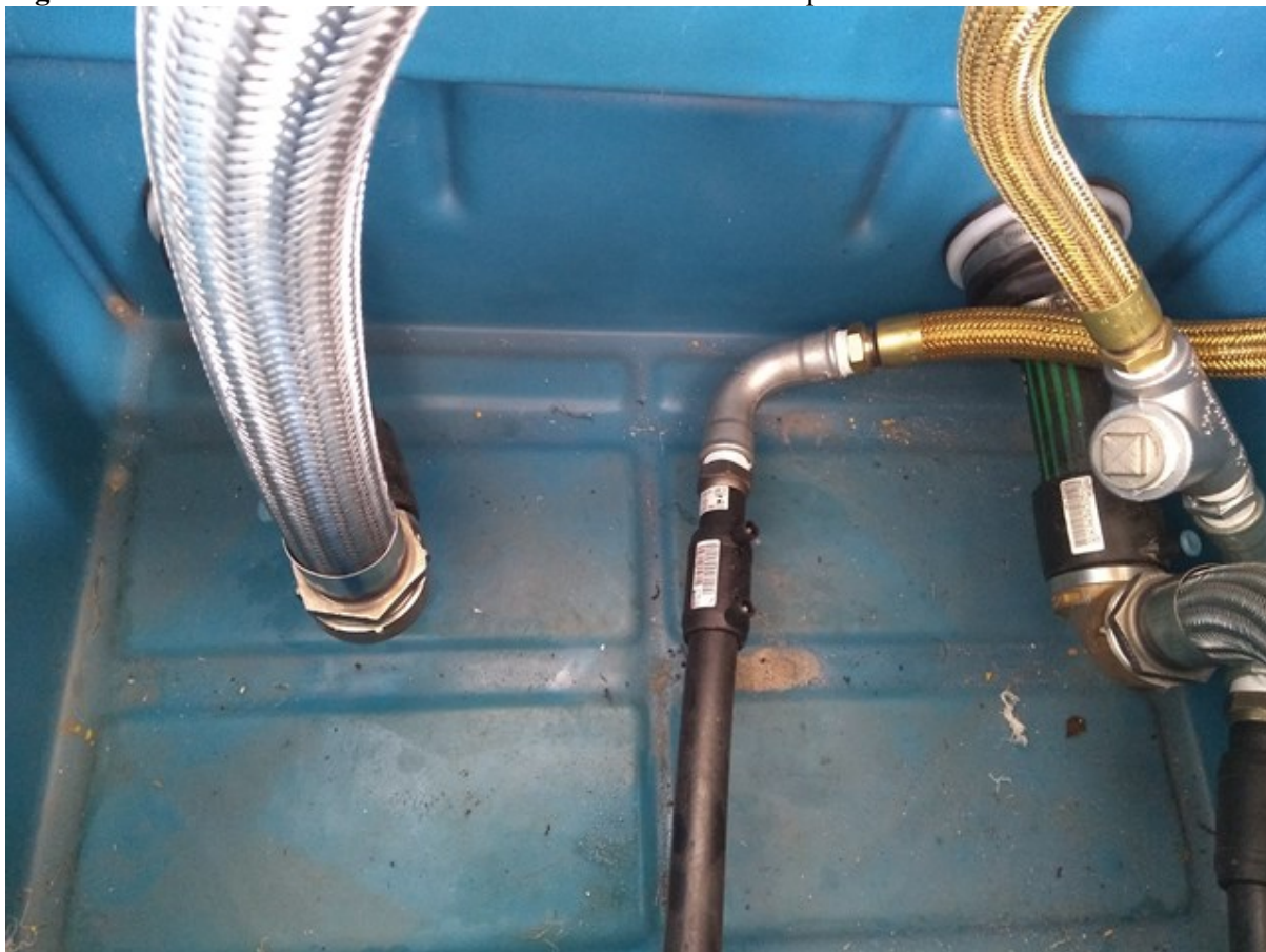
Figura 6 - Câmaras de contenção junto a unidade abastecedora.
