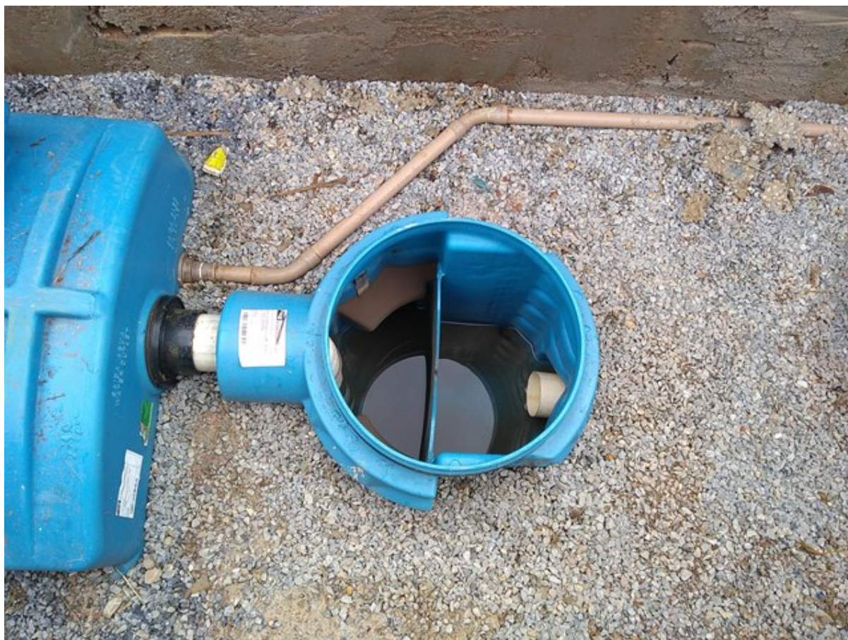
Figura 13 - Módulo medidor de vazão com coleta de amostras.
