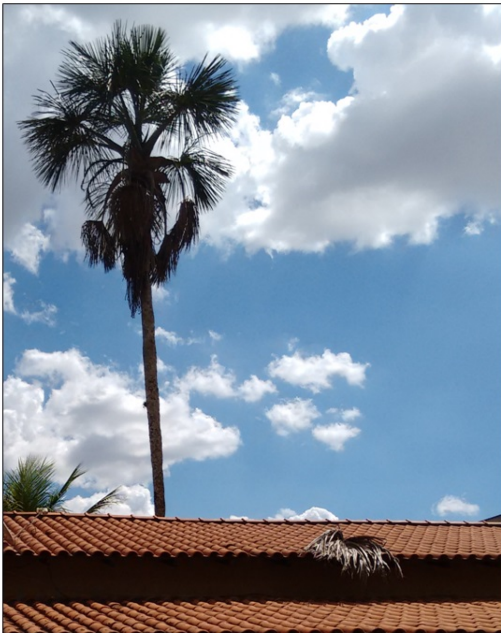
Figura-02: Detalhe para uma folho que Buriti caída sobre o telhado da residência.
