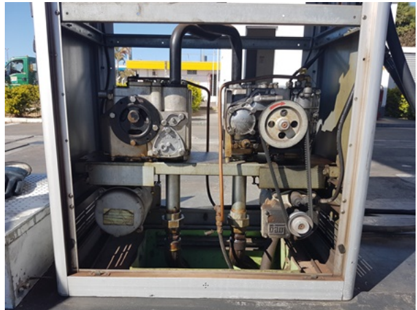
Figura 02 - Bomba de abastecimento com a câmara de contenção
