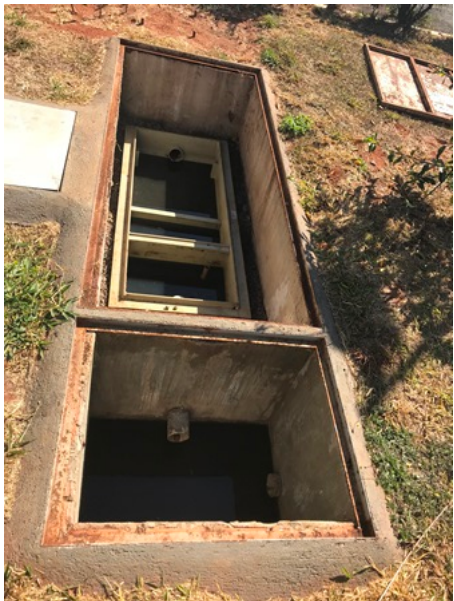
Figura 10 - Sistema Separador de Água e Óleo.
