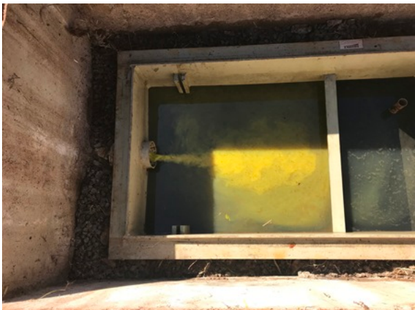
Figura 11 - Líquido amarelo no SAO, atestando que os canais da pista de abastecimento estão ligados ao SAO.
