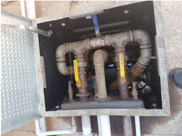
Figura 9 - Filtro de diesel sem a devida manutenção.
