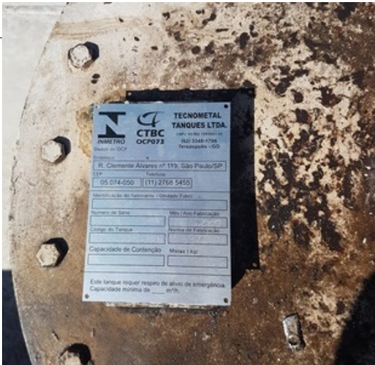
Figura 8 - Placa de identificação do tanque
