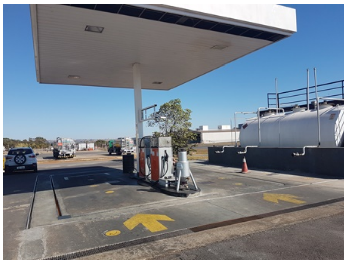
Foto 01 - Vista parcial do posto de combustíveis.
