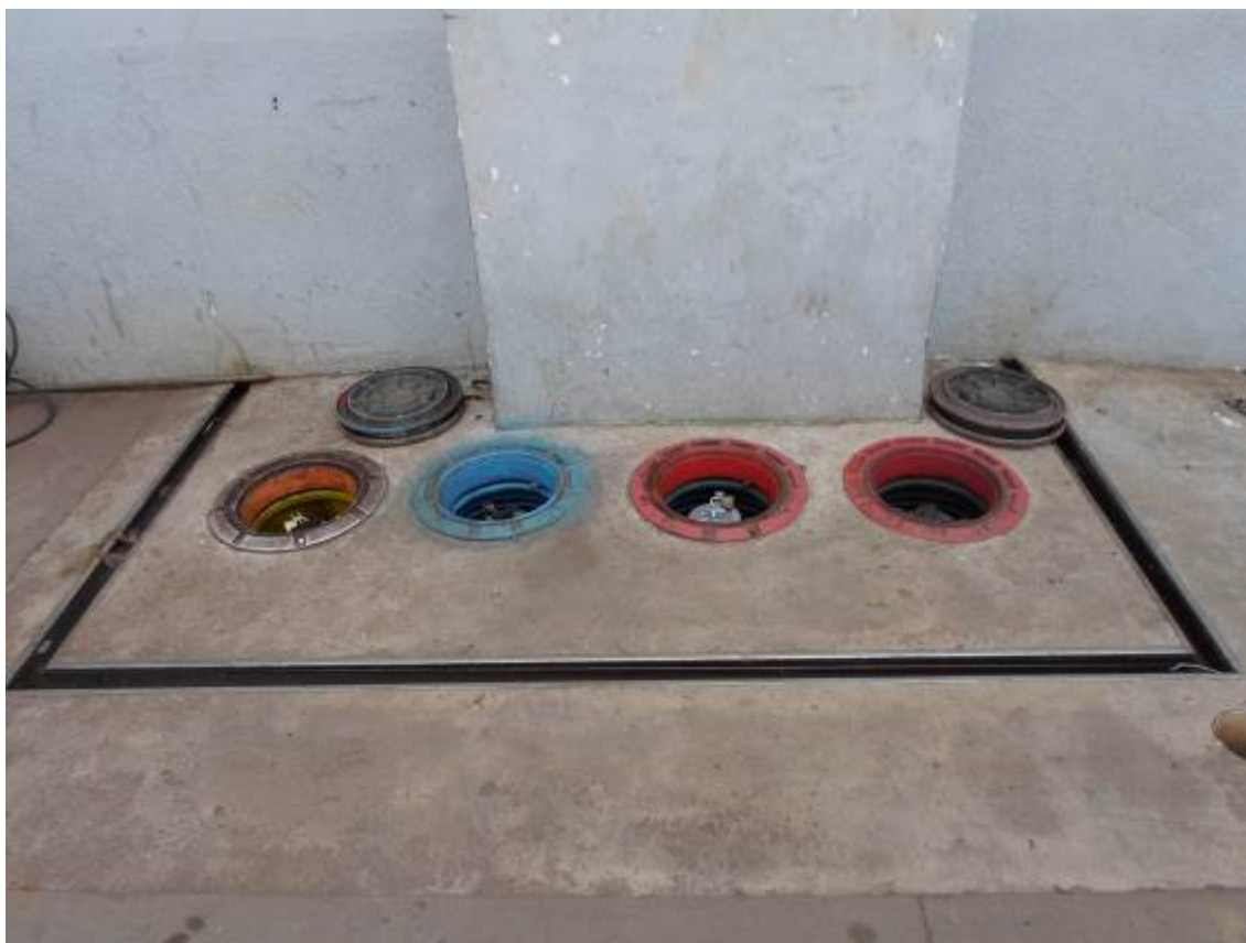
Figura 5. Descarga selada à distância circundada por canaletas. Observa-se a necessidade de manutenção no interior do sump .
