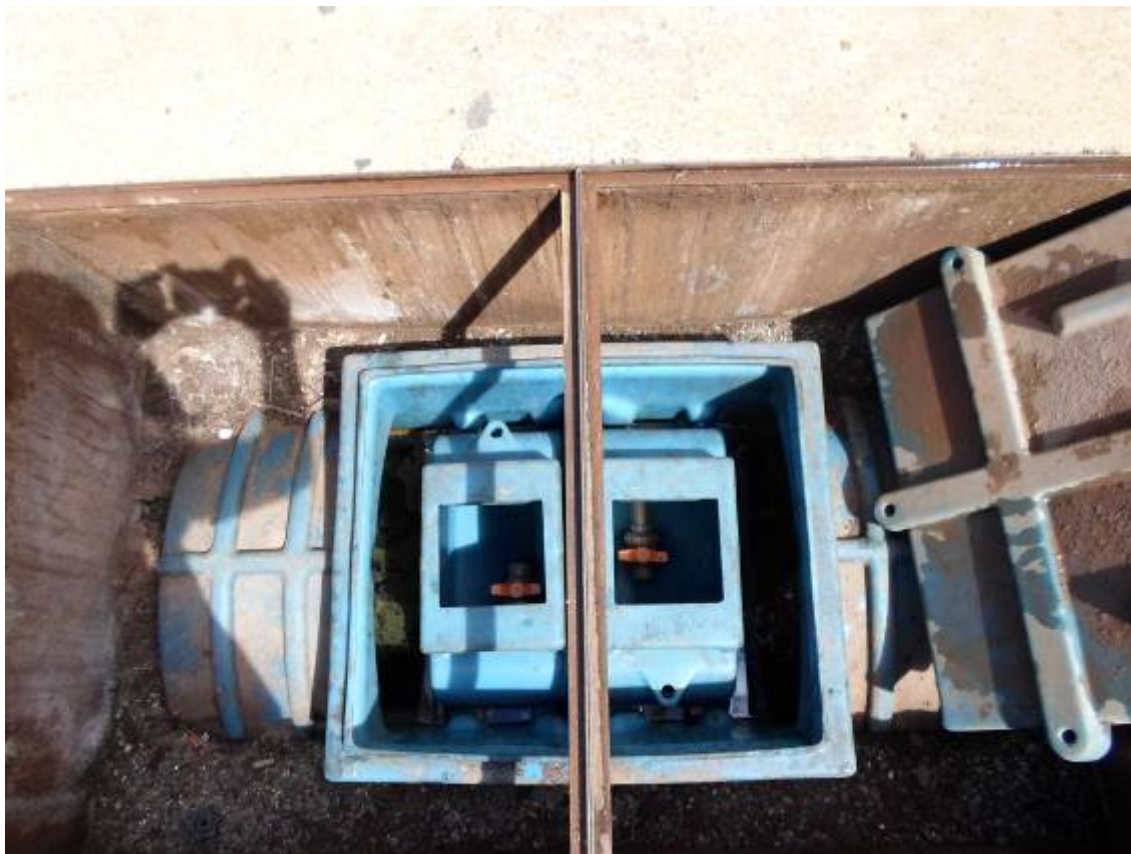
Foto 9. Caixa Separadora e Coletora de óleo do SAO da pista de abastecimento. Observa-se que os compartimento necessitam de manutenção operacional semanal conforme exige a tabela 1 da ABNT NBR 15594-3:2008.
