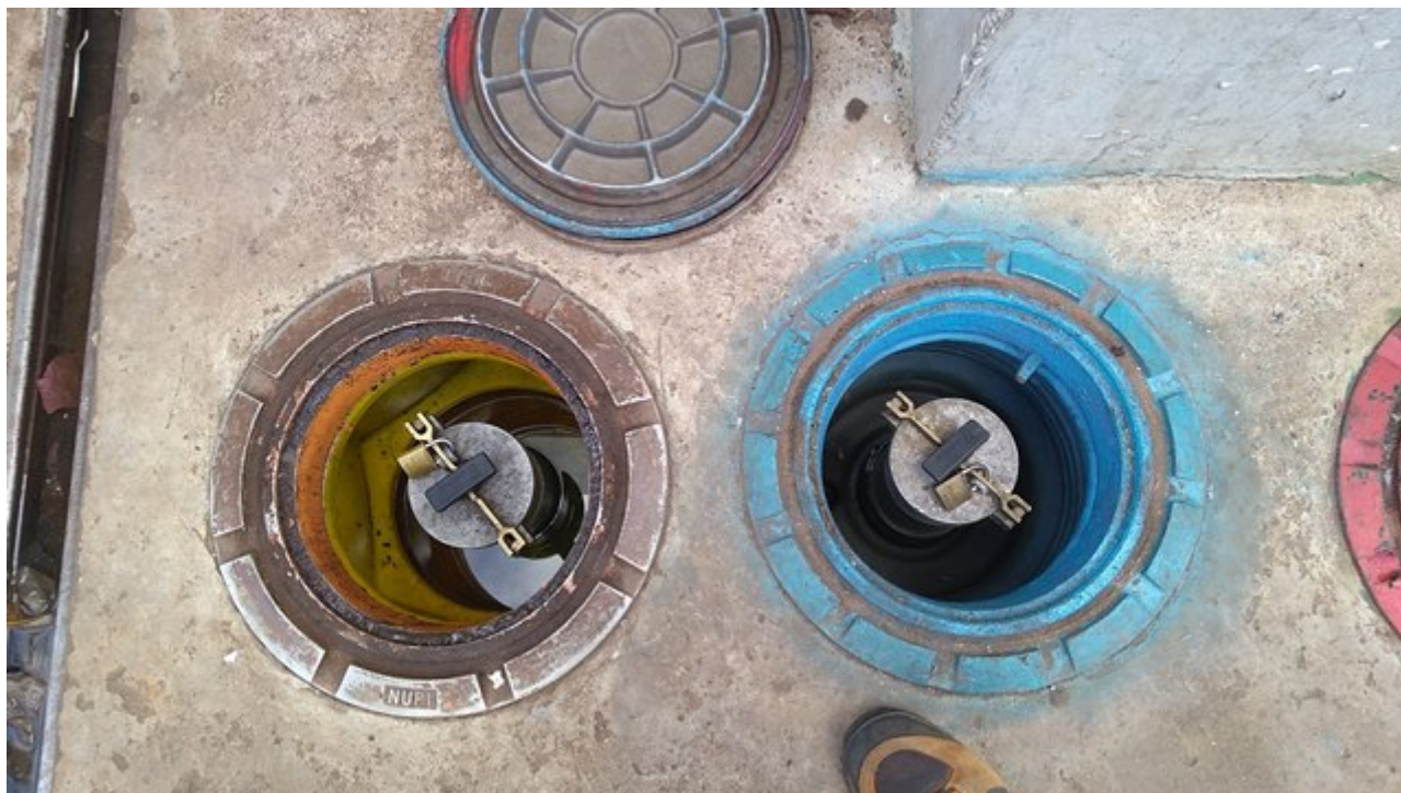
Foto 6. Detalhe das descargas seladas à distância. Observa-se a necessidade de manutenção no interior do sump .
