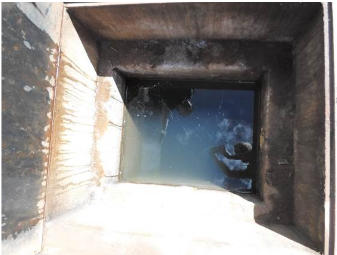
Foto 10. Caixa de Areia do SAO da pista de abastecimento. Observa-se que os compartimento necessitam de manutenção operacional
