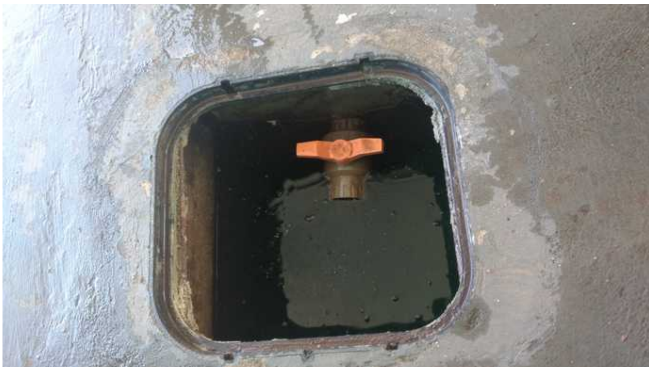
Figura 19 - Caixa Coletora - SAO Área de Lavagem de Veículos.
