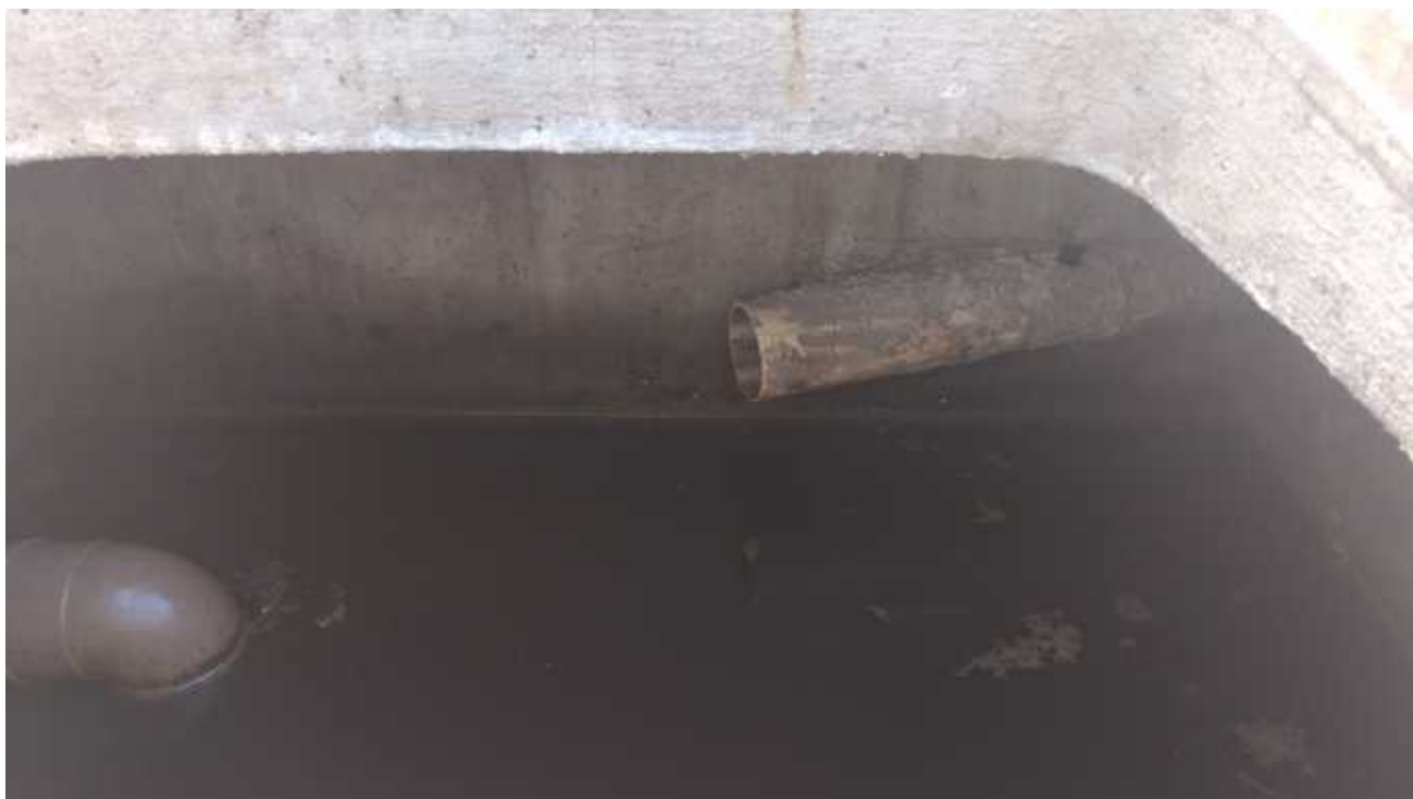
Figura 21 - Caixa Separadora - SAO - Pista de Abastecimento.
