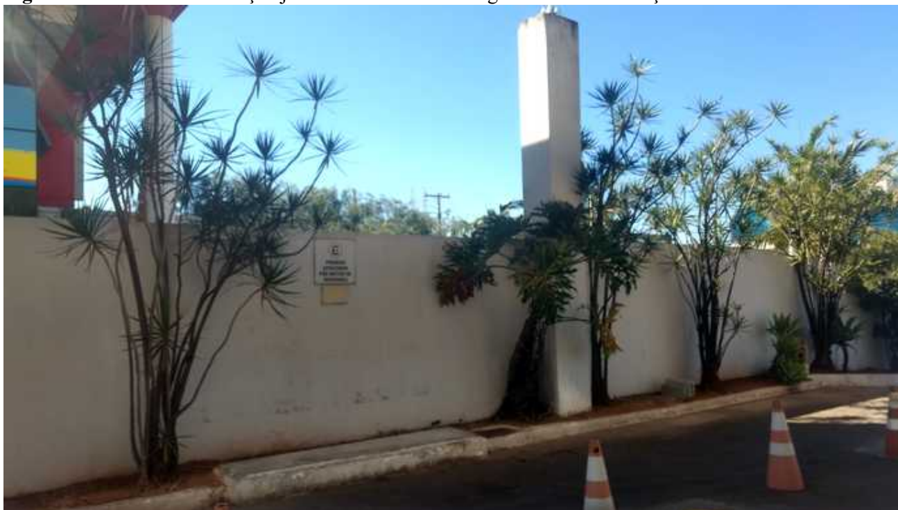
Figura 10 - Descarga selada a distância e respiro dos tanques (sem raio esférico livre).
