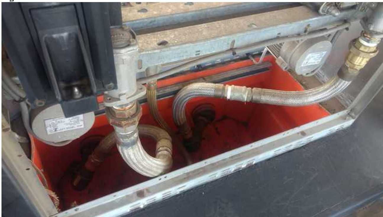
Figura 6 - Câmara de contenção junto a bomba de abastecimento.
