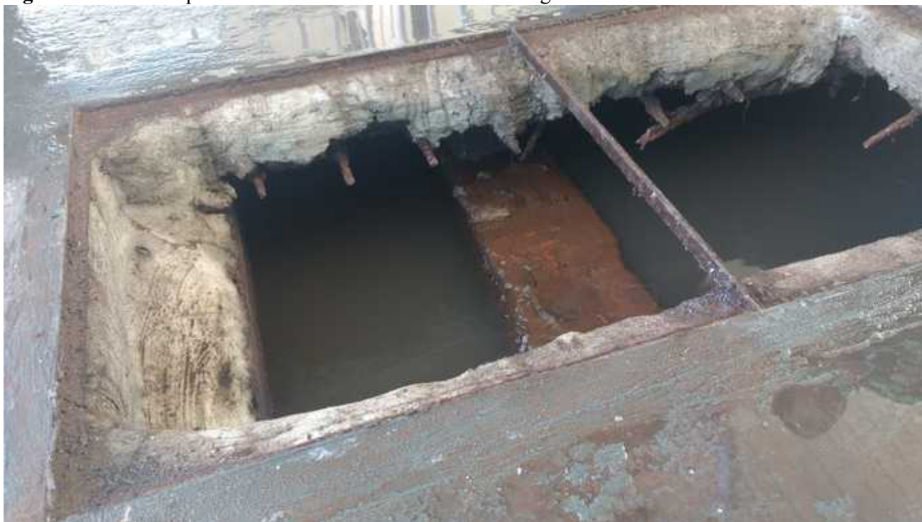
Figura 18 - Caixa Separadora - SAO Área de Lavagem de Veículos.
