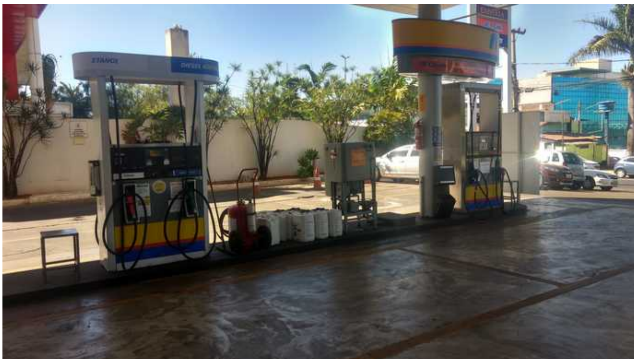
Figura 5 - Ilha de abastecimento e filtro de diesel.
