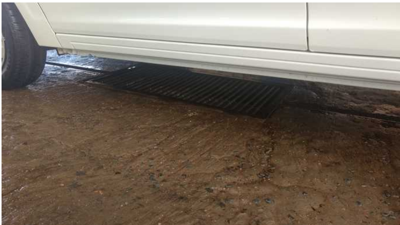
Figura 17 - Caixa Separadora de Areia Central - Área de Lavagem de Veículos.
