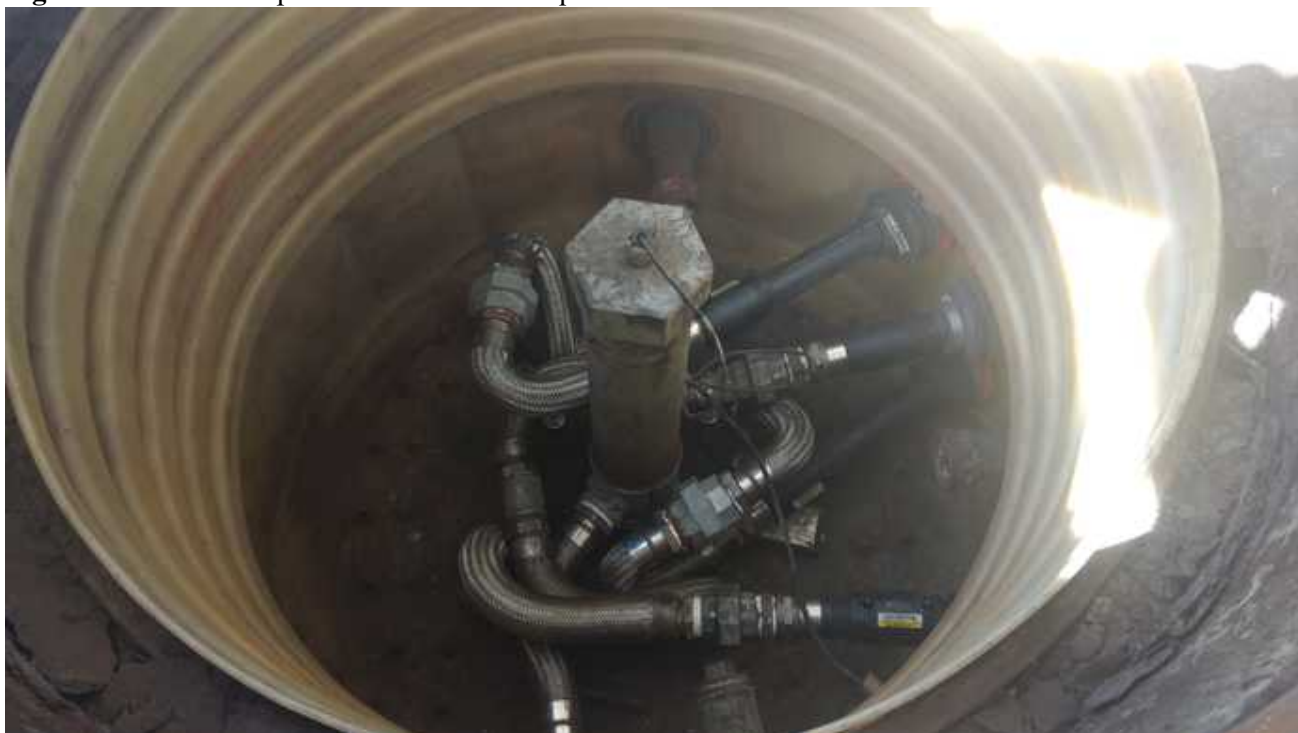
Figura 12 - Câmara de contenção da boca de visita do tanque.
