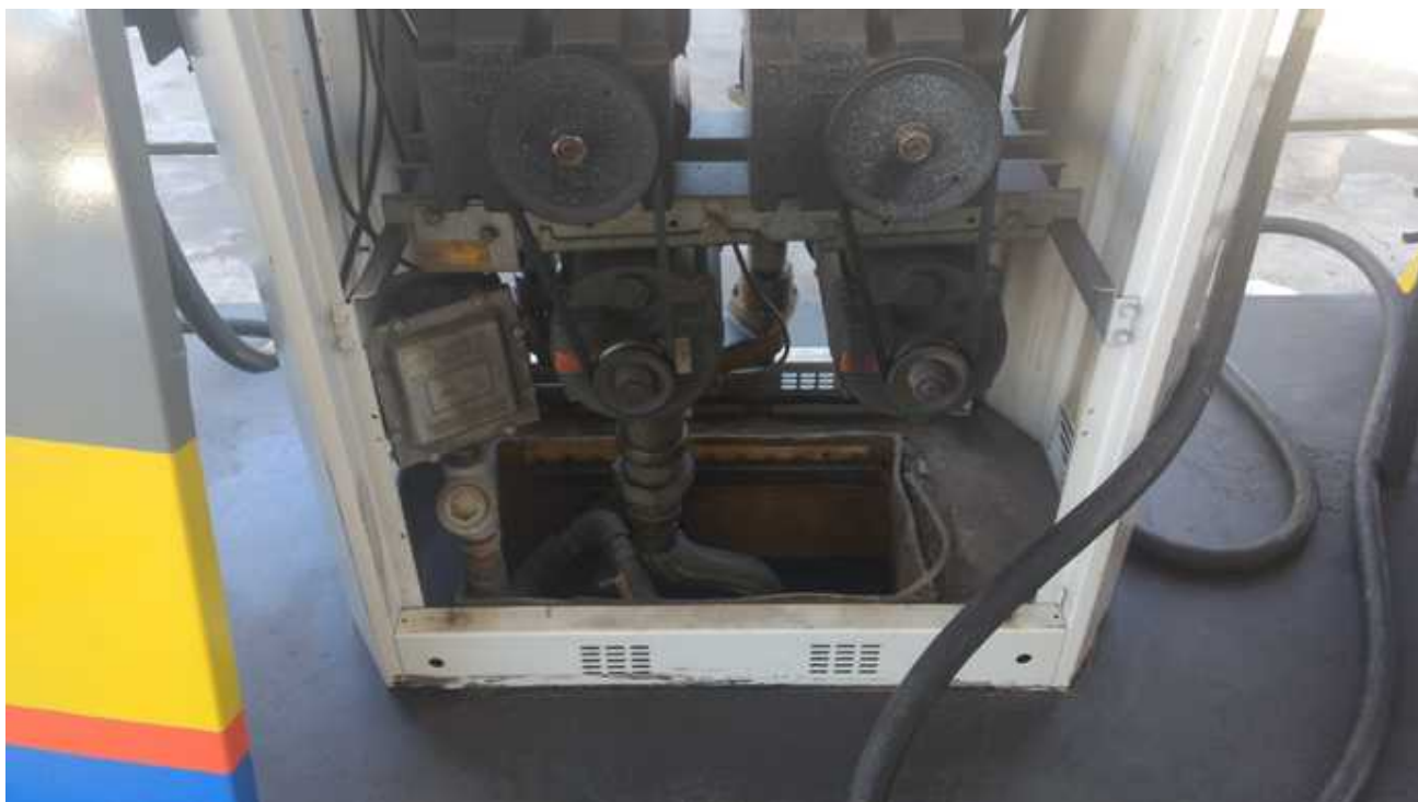
Figura 9 - Câmara de contenção junto a bomba não abrangendo toda a tubulação.
