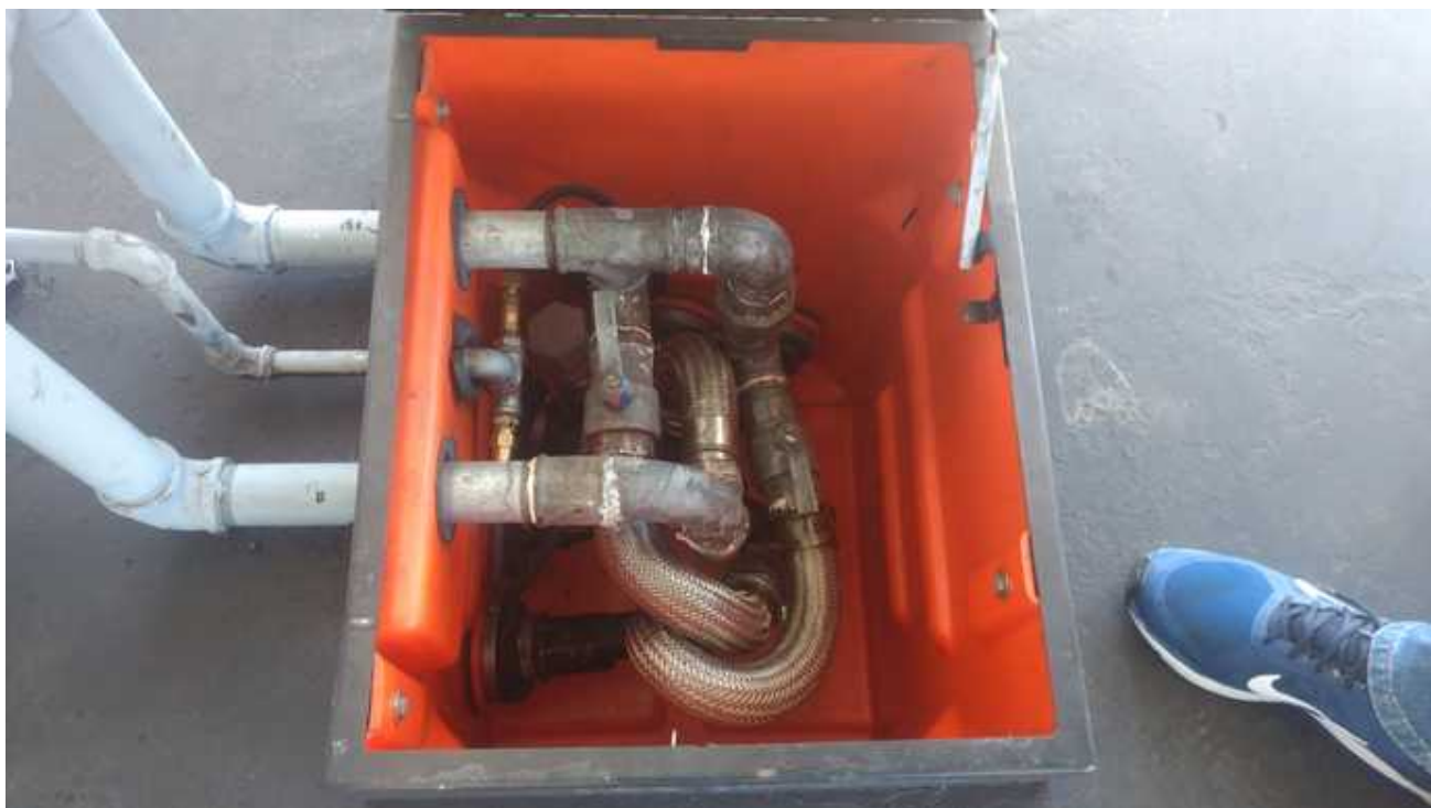
Figura 7 - Câmara de contenção do filtro de diesel.
