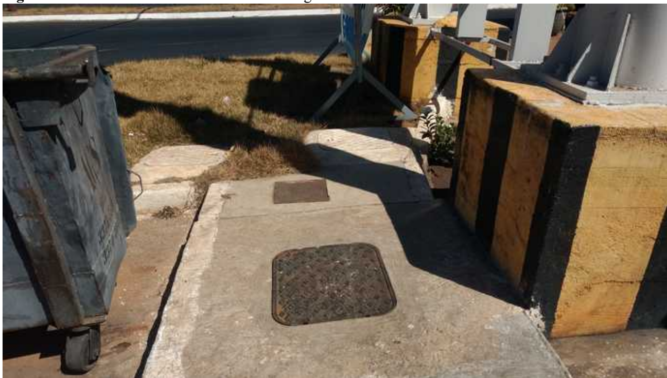
Figura 20 - Sistema Separador Água/Óleo - Pista de Abastecimento.
