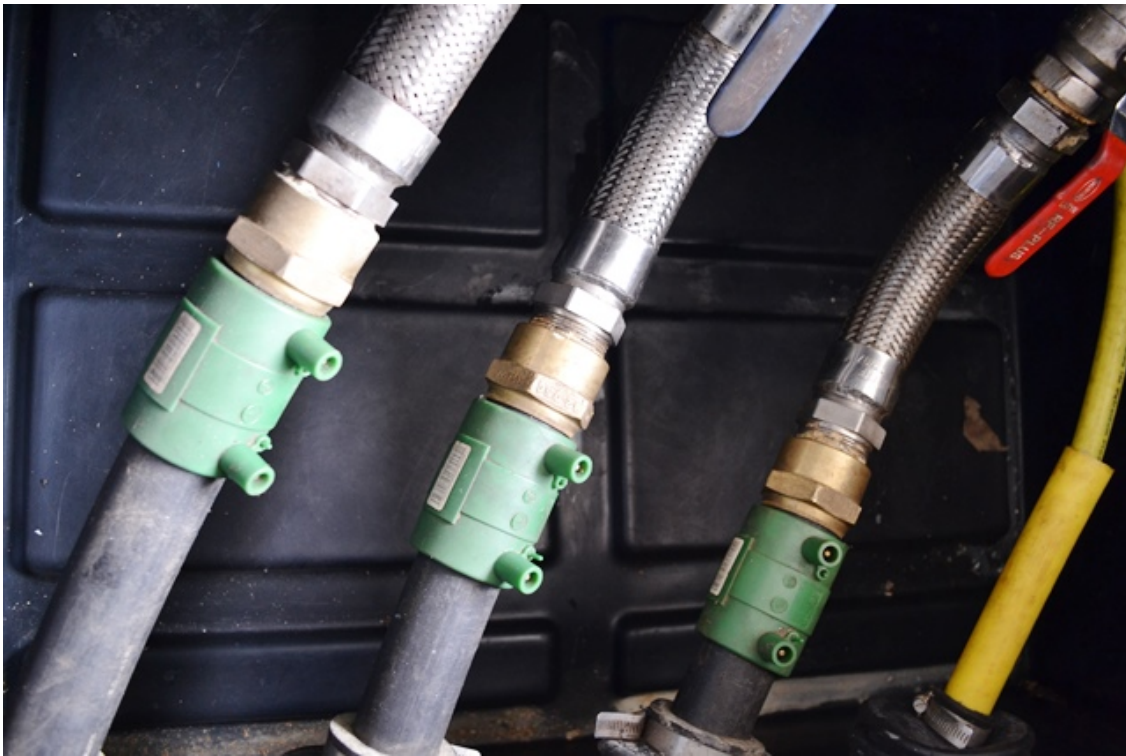
Figura 6 – Aspecto interno da câmara de contenção ( sump ) da Unidade do filtro de Diesel.
