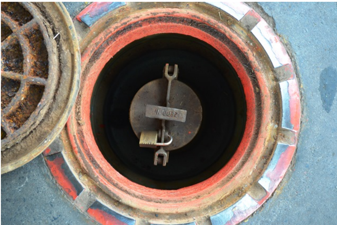
Figura 6 - Dispositivo de Descarga selada sobre o tanque com câmara de contenção ( Spill container ). O dispositivo deve ter manutenção operacional constante conforme exige a tabela 1 da
