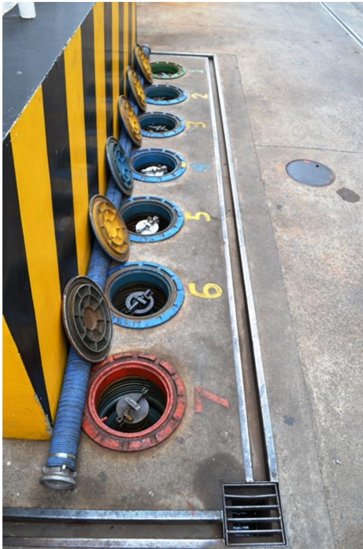
Figura 5 - Descarga selada à distância. Observa-se que o dispositivo é circundado por canaletas direcionadas ao SAO exclusivo da pista de abastecimento.
