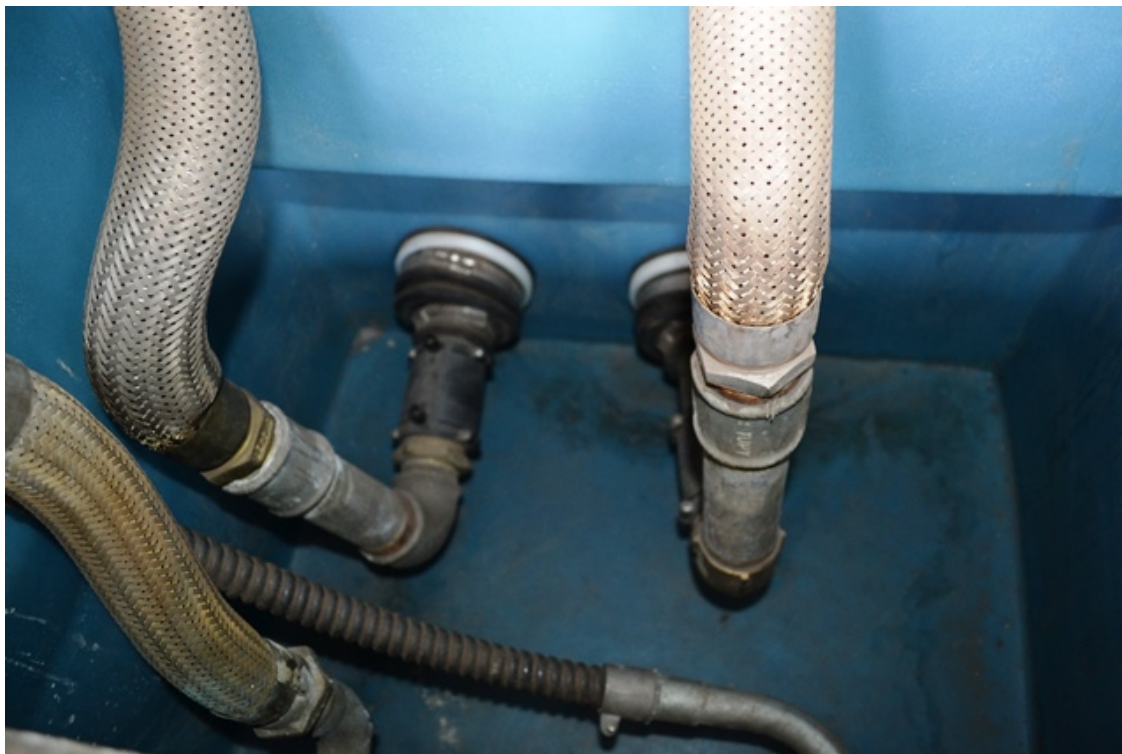
Figura 4 - Detalhe do interior da unidade abastecedora com a câmara de contenção de uma das Unidades Abastecedoras do SASC. Observa-se que a tubulação está totalmente contida no dispositivo de segurança.
