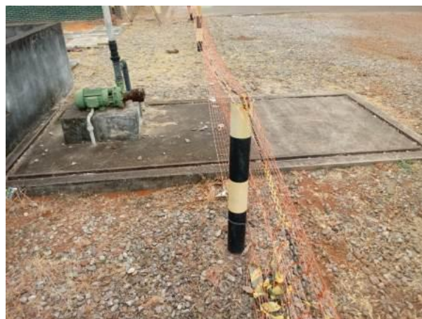
Figura 9: Equipamento de bombeamento de combustível com tubulação "aérea" e provável continuação subterrânea, sobre placa de concreto que provavelmente veda equipamento subterrâneo do SASC
