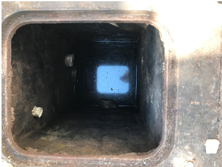
Foto 15. Caixa final dos efluentes do SAO.
