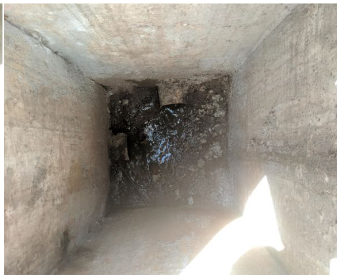
Foto 14. Caixa de amostragem do SAO da área de lavagem e da pista.
