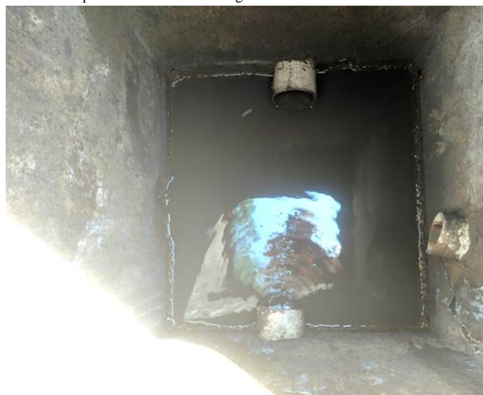
Foto 12. Caixa de areia SAO da área de lavagem e pista de abastecimento.
