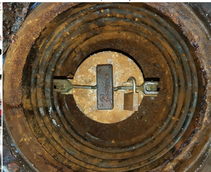
Foto 6. Detalhe da câmara de contenção da descarga selada sobre o tanque.
