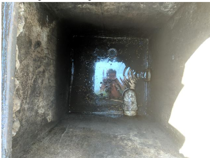
Foto 13. Caixa separadora de água e óleo do SAO da pista e lavagem.
