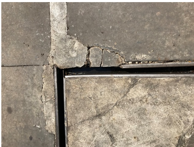
Foto 9. Detalhe do canaleta danificado.
