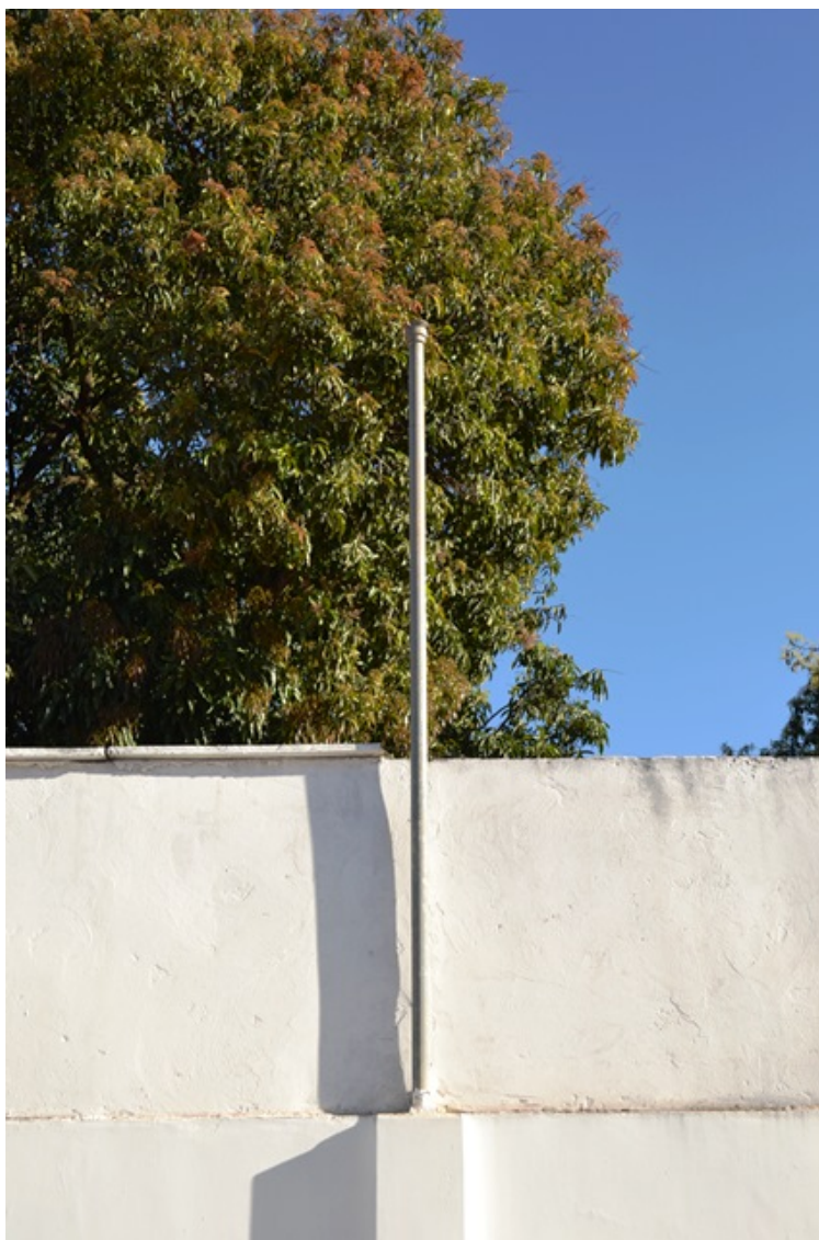
Foto 12: Respiro do tanque de OLUC, com terminal corta-chamas.
