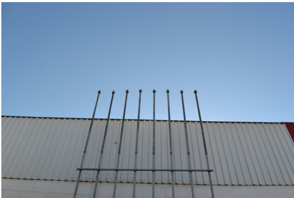
Foto 6: Respiros com terminal corta-chamas para tanques próximo as descargas seladas à distância.
