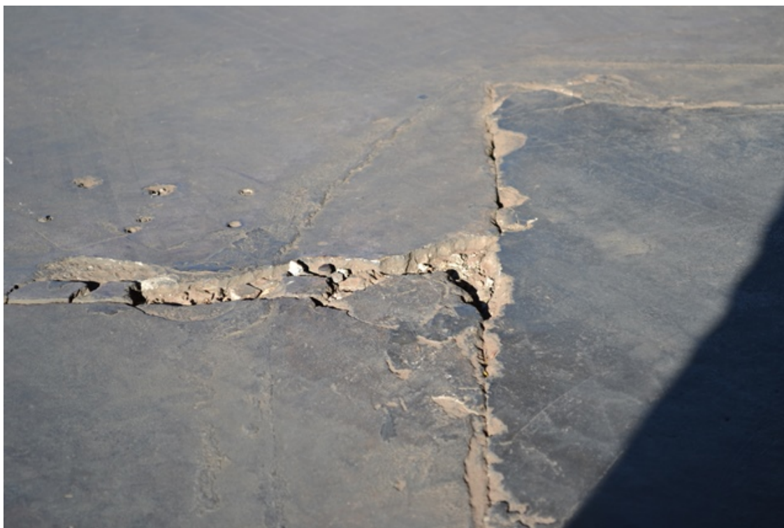
Fotos 7: Piso da área de abastecimento. Nota-se a presença de rachaduras.
