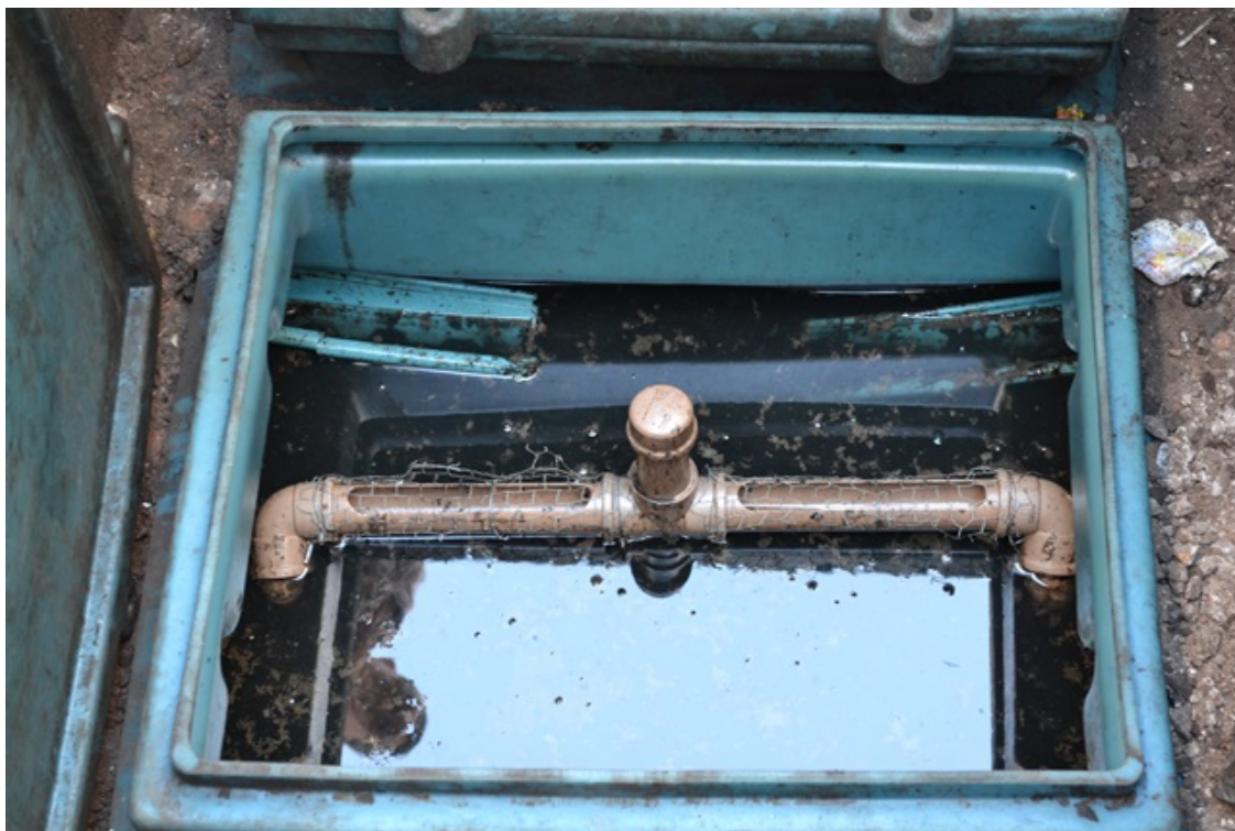
Foto 11: Caixa separadora do SAO da pista de abastecimento. Nota-se que as placas coalescentes estão danificadas.
