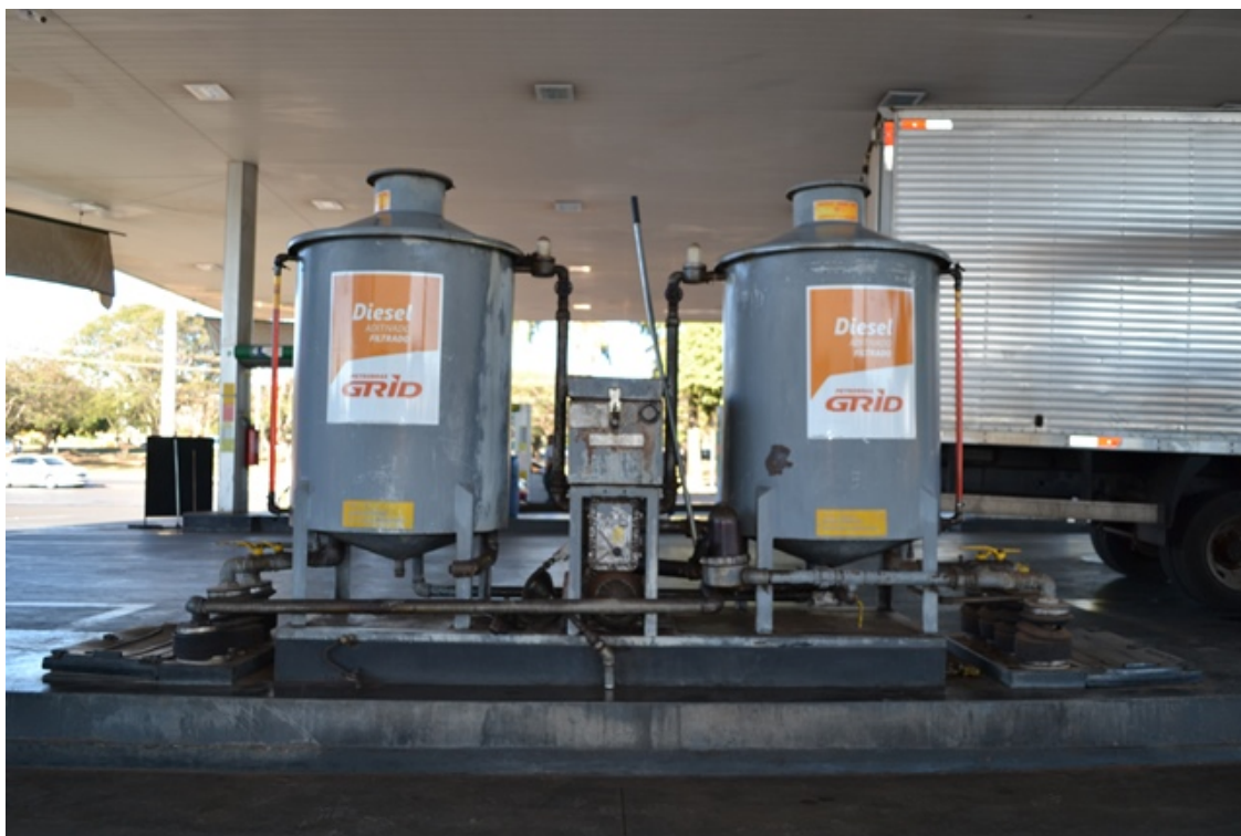
Foto 10: Filtros de Diesel.
