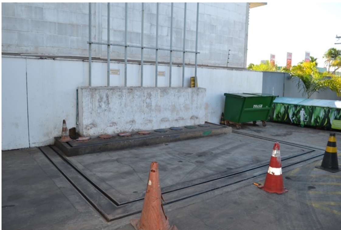
Foto 5: Descargas seladas à distância dotadas de câmara de contenção e válvulas anti-transbordamento, contidas em canaletas ligadas ao SAO da pista de abastecimento.
