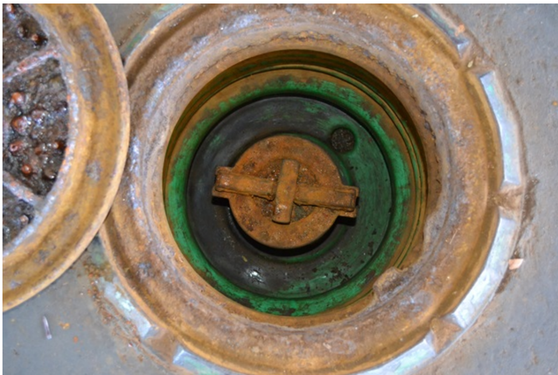
Foto 4: Descarga selada sobre o tanque dotada de câmara de contenção e válvulas anti-transbordamento.
