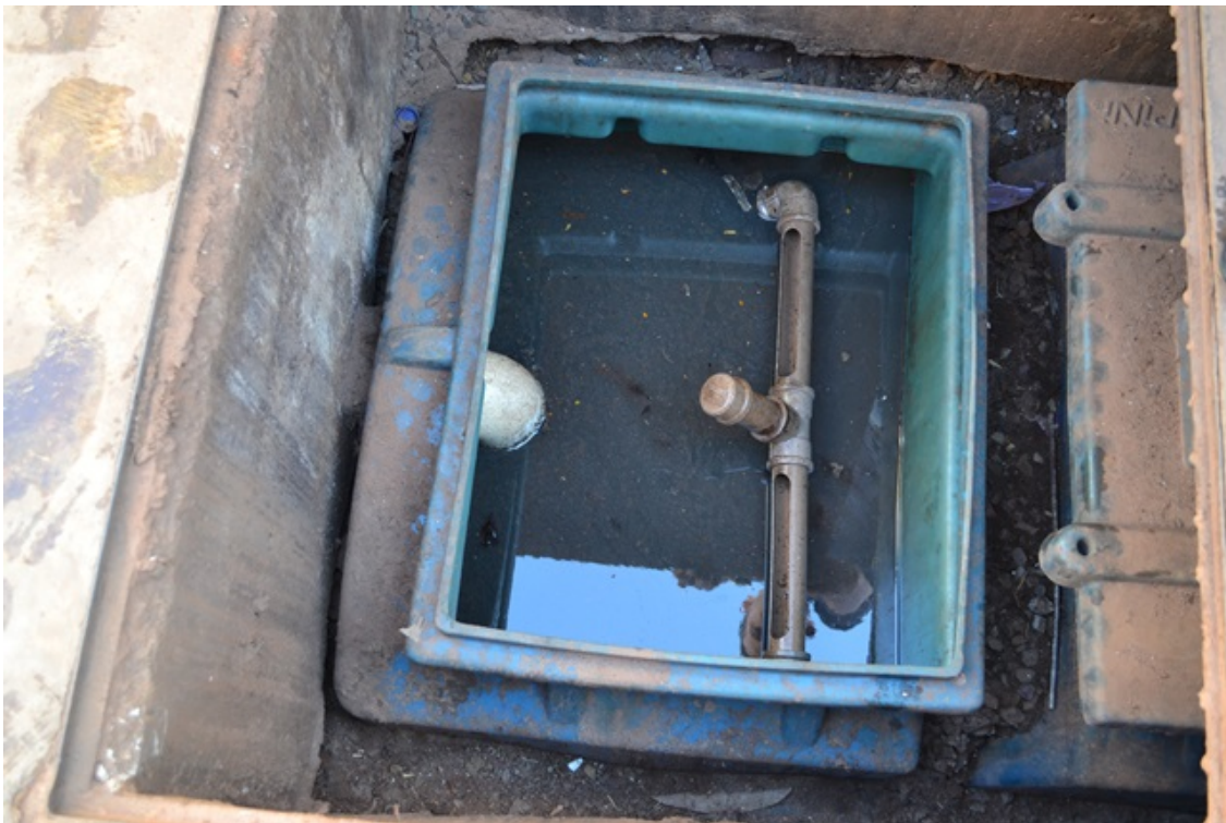
Foto 16: Caixa Separadora do SAO da área de lavagem de veículos. Nota-se a presença de resíduos sólidos denotando o mau desempenho do sistema.
