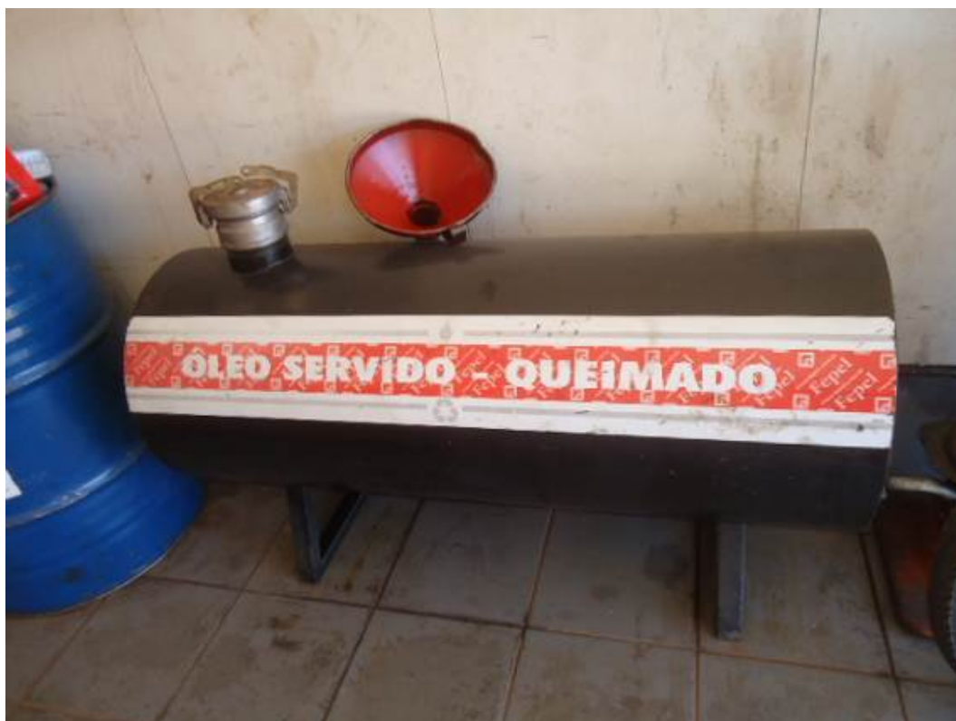
Figura 14 - Tanque aéreo de armazenamento de óleo usado e contaminado.
