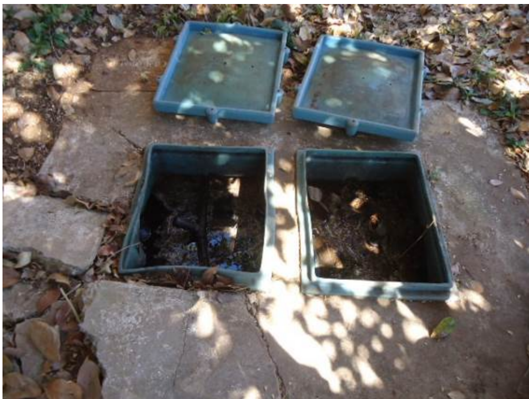
Figura 16 - SAO da pista de abastecimento e da área de lubrificação, a foto evidencia o não funcionamento do sistema e a falta de manutenção periódica.
