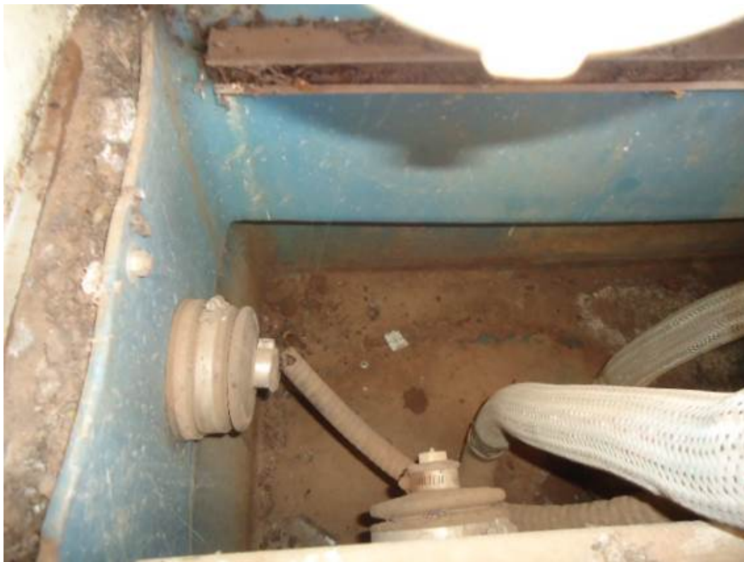
Figura 21 - Sump da bomba de abastecimento, a foto evidencia a ausência de manutenção periódica e tubulações rompidas e abertas.
