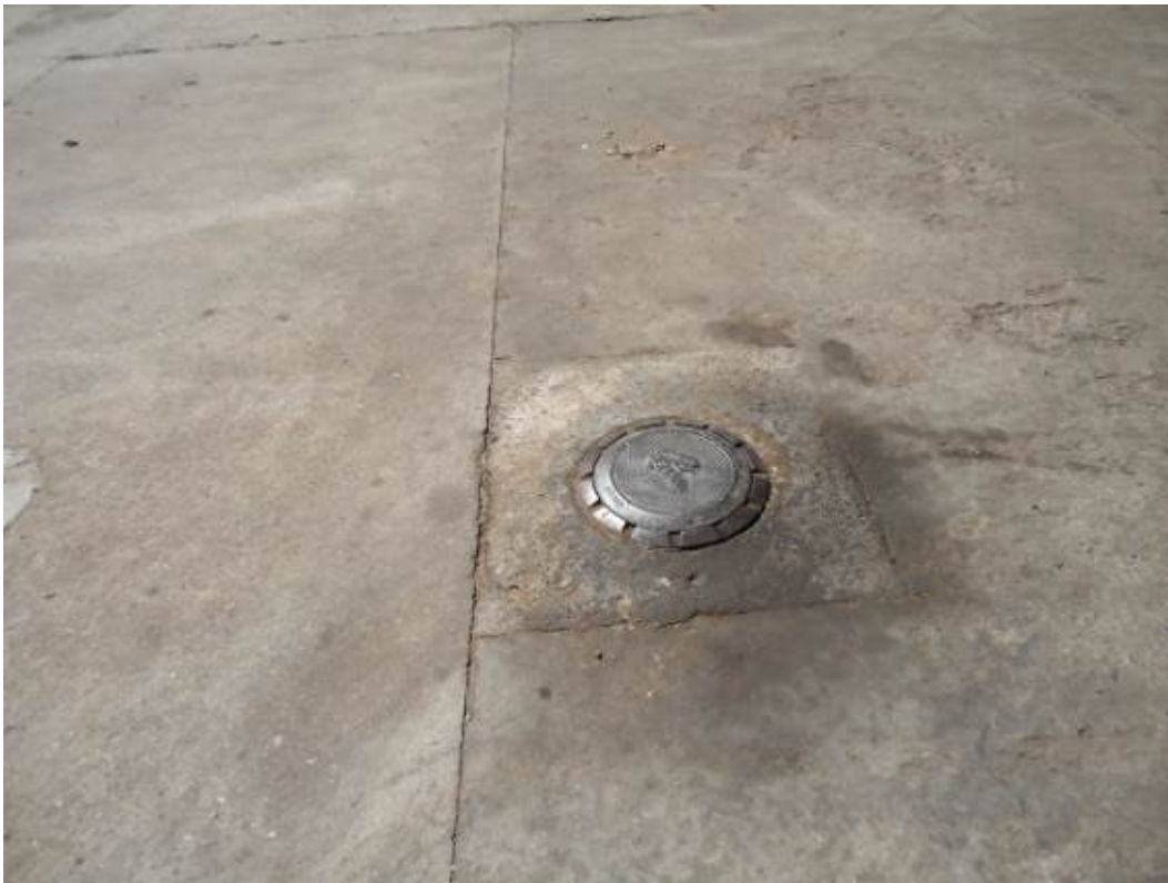
Figura 7 - Descarga selada sob o tanque, utilizada para abastecimento.
