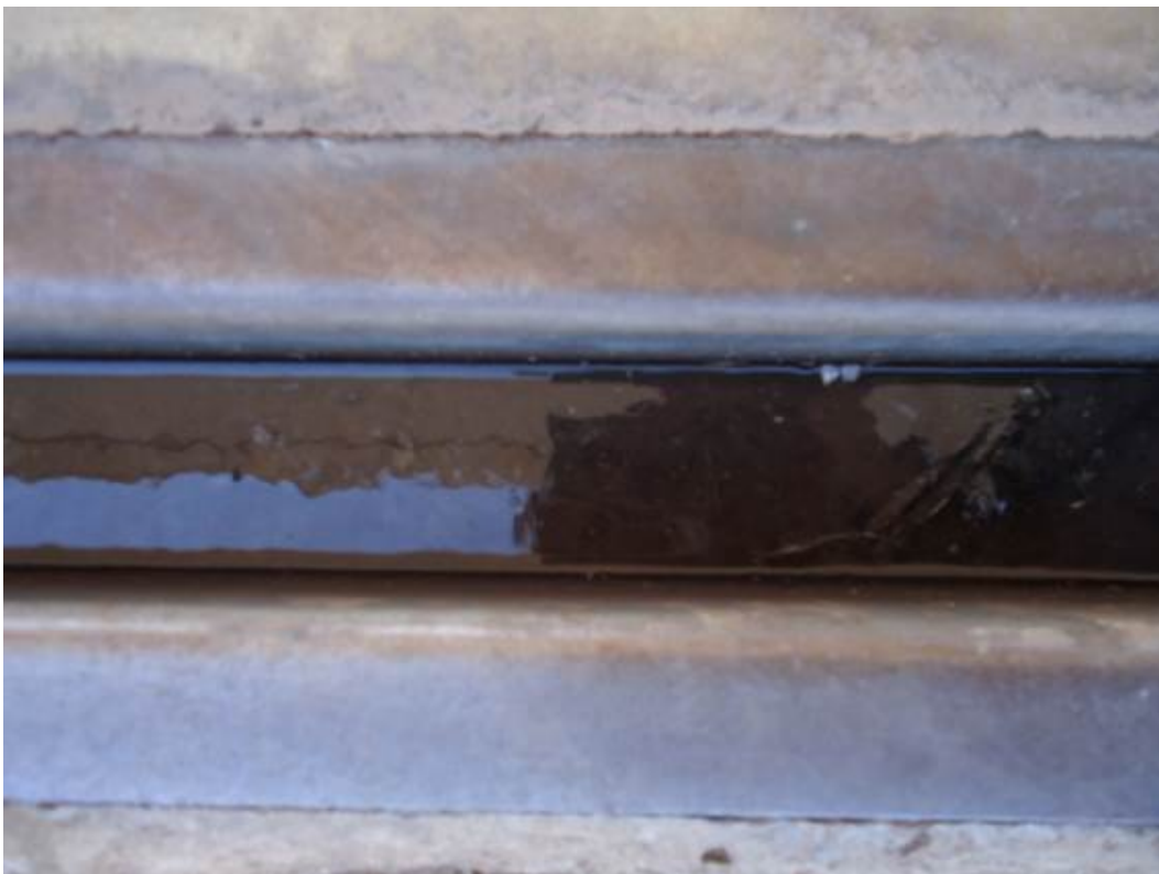
Figura 4 - Canaletes com acúmulo de água.
