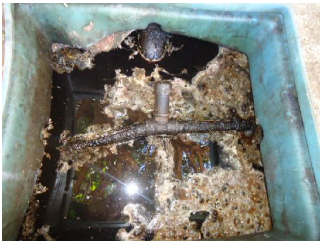
Figura 17 - Caixa separadora de água e óleo, a foto evidencia o não funcionamento do sistema e a falta de manutenção periódica.
