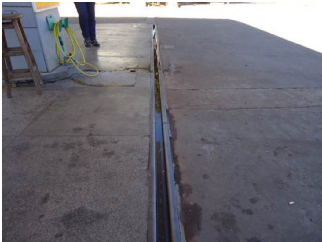
Figura 5 - Canaletes da área de abastecimento
