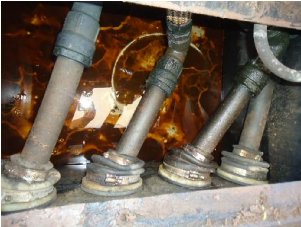
Figura 11 - Câmara de contenção da unidade de filtragem de diesel, com acúmulo de líquido no interior, evidenciando o vazamento de diesel.
