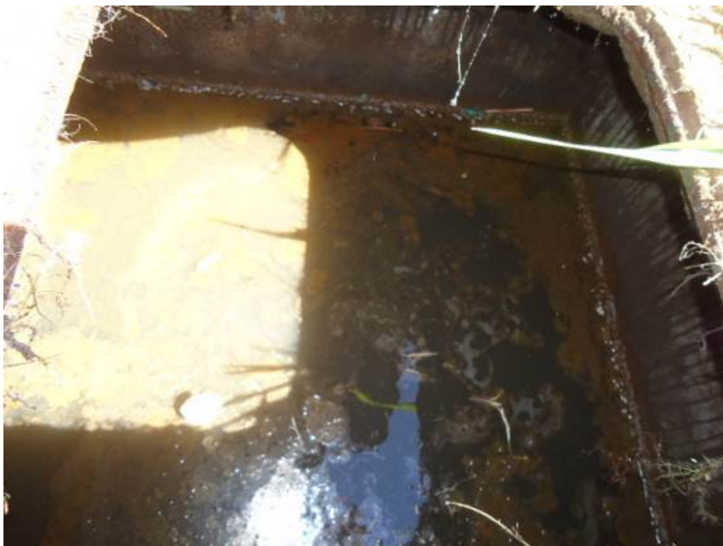
Figura 20 - Caixa coletora de óleo, a foto evidencia o não funcionamento do sistema e a falta de manutenção periódica.
