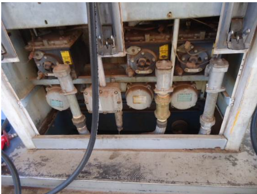
Figura 21 - Parte interna da bomba de abastecimento, a foto evidencia a ausência de manutenção.
