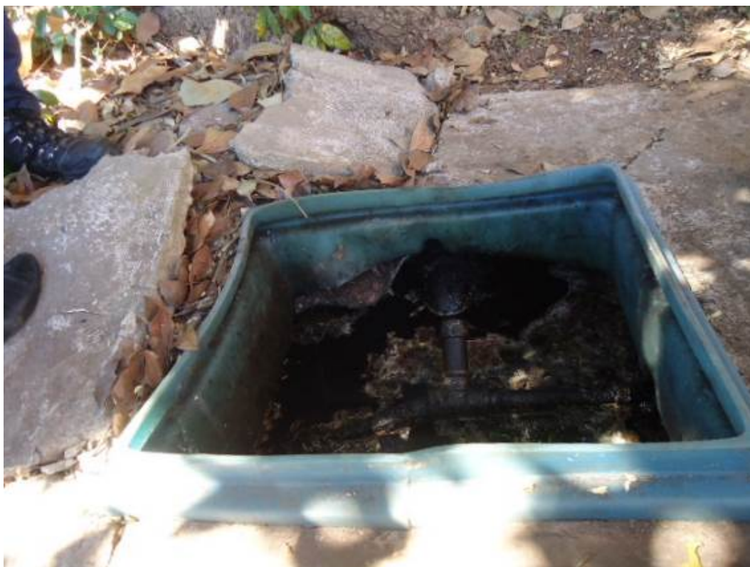
Figura 18 - Caixa separadora de água e óleo, a foto evidencia o não funcionamento do sistema e a falta de manutenção periódica.
