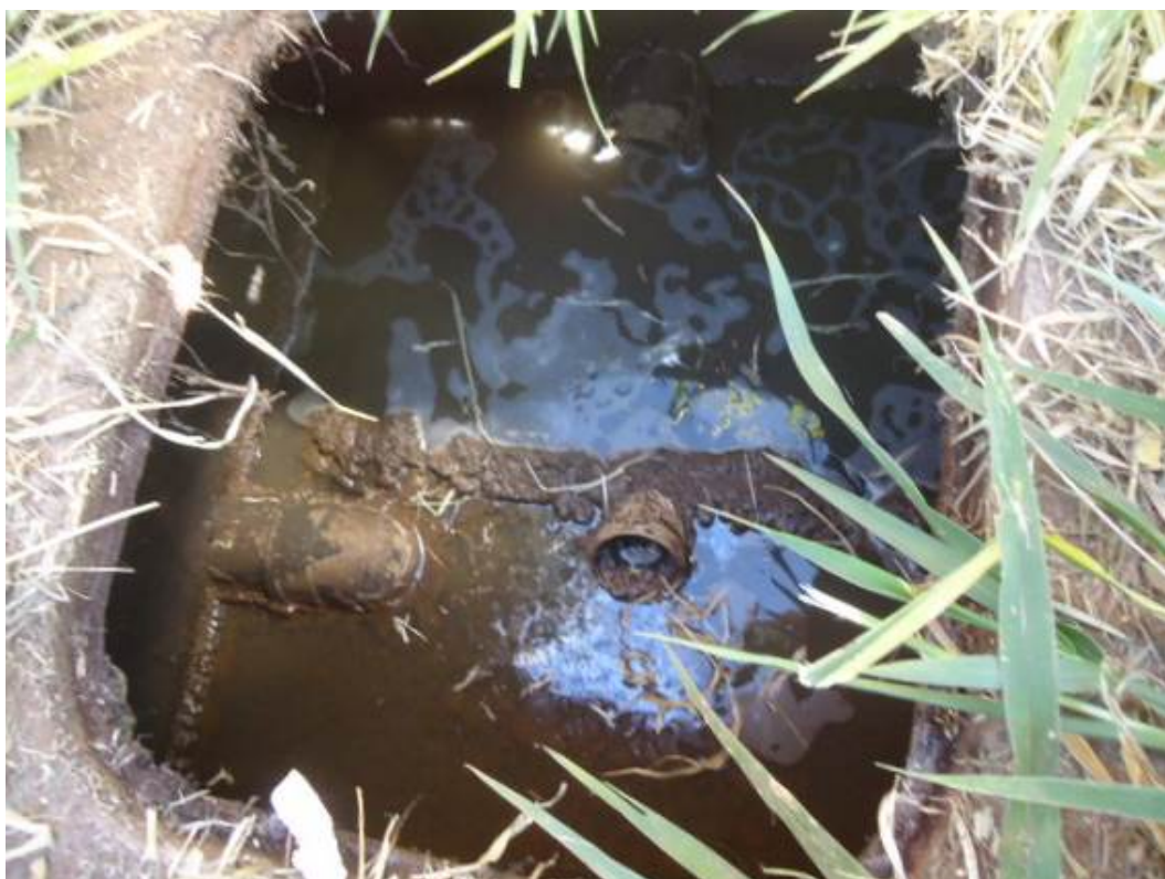
Figura 19 - Caixa separadora de água e óleo do SAO da área de lavagem, a foto evidencia o não funcionamento do sistema e a falta de manutenção periódica.
