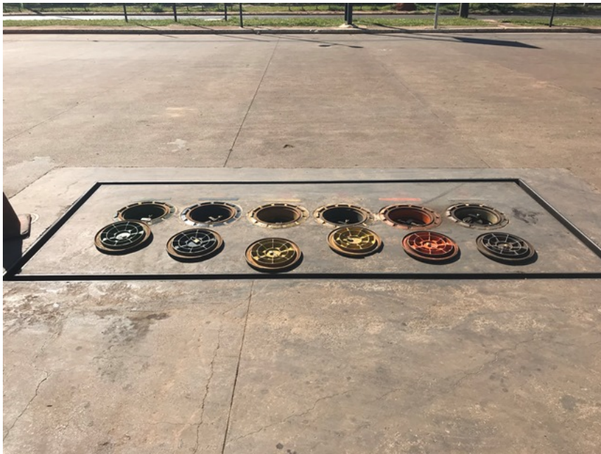
Foto 6. Visão geral das descargas seladas à distância.
