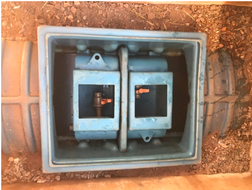
Foto 20. Caixa separadora e coletora de água e óleo do SAO da pista de abastecimento.
