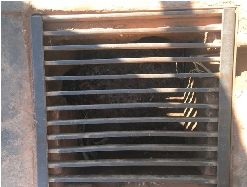
Foto 18. Detalhe do canaleta sem manutenção.
