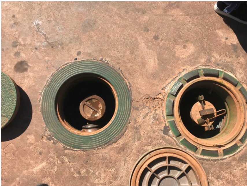
Foto 4. Câmara de contenção sobre o tanque e câmara do monitoramento intersticial.
