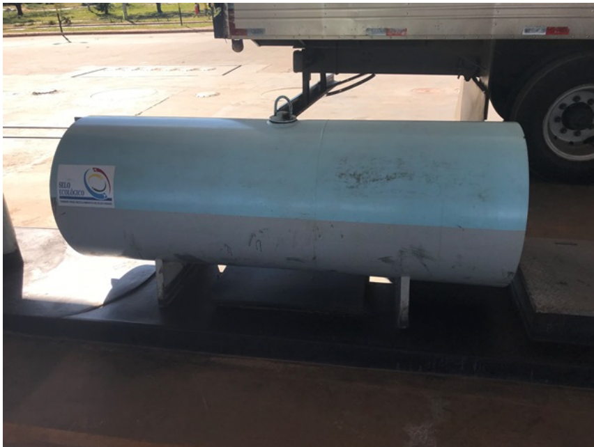
Foto 14. tanque de OLUK na pista de abastecimento.
