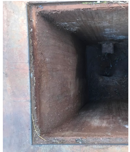
Foto 21. Caixa de amostragem do SAO da pista
