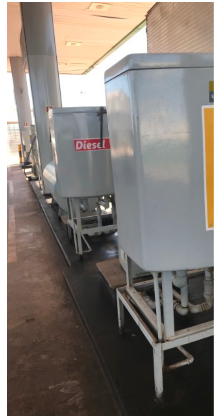
Foto 11. Filtros de Diesel na área de abastecimento
