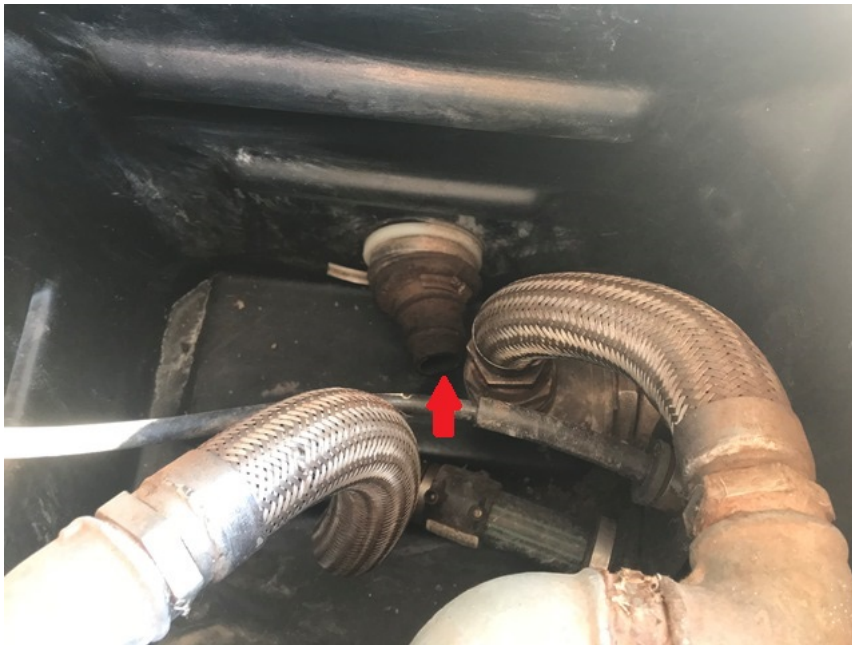
Foto 12. Detalhe da câmara de contenção do filtro de diesel, com tubulação aberta.
