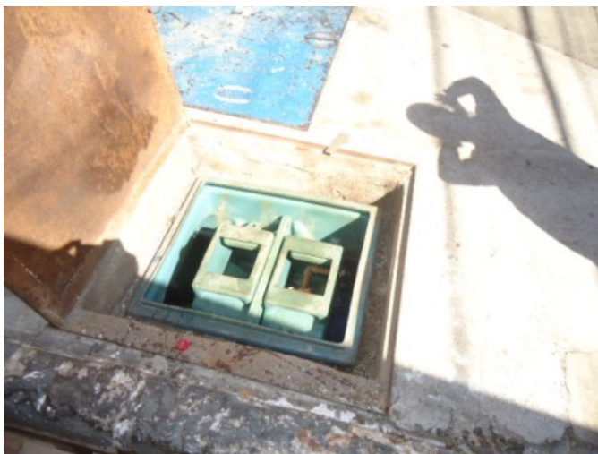
Foto 12: Caixa separadora de água e óleo - Pista de Abastecimento.
