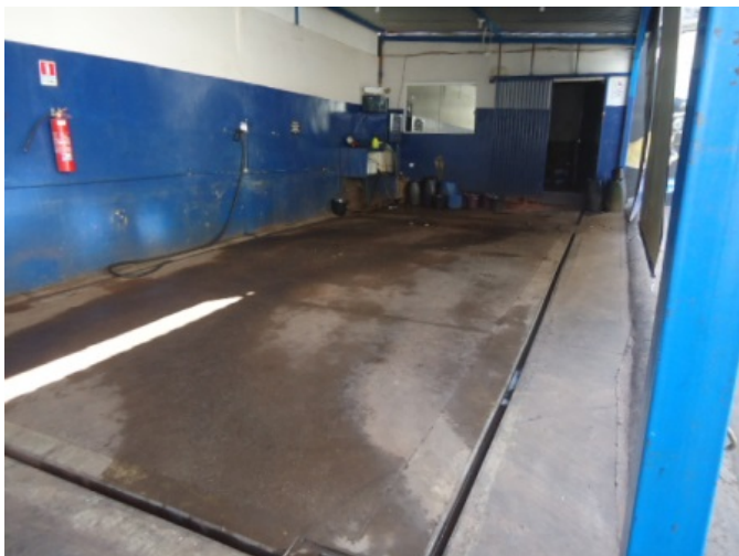
Foto 14: Área de lavagem de veículos com canaletas circundando a área, mas sem caixa de areia central.
