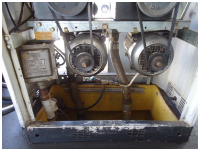
Foto 11: Câmara de contenção da unidade de abastecimento, observa-se que toda a tubulação que transporta combustível está contida dentro dos limites da câmara, check valve e boa manutenção do equipamento.
