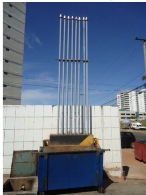
Foto 25: Respiros dos tanques, dotados de terminais corta-chamas.
