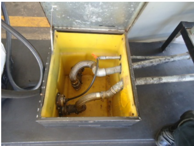
Foto 10: Câmara de contenção do filtro de diesel, observa-se boa manutenção.
