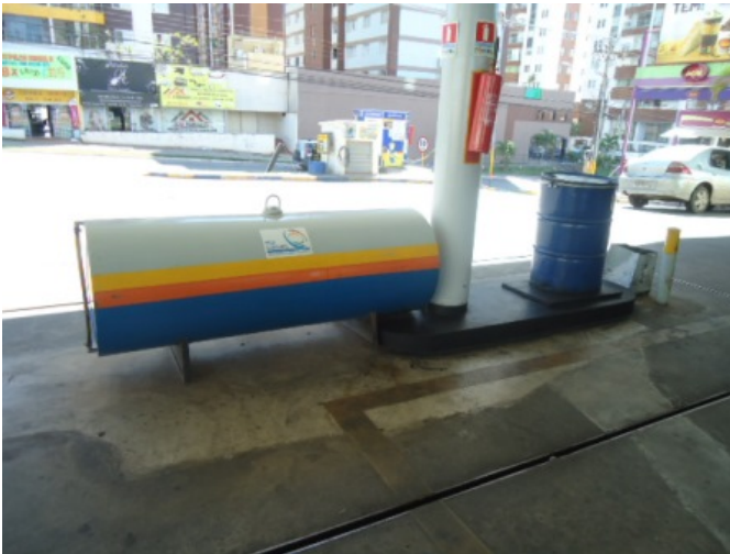
Foto 18: Tanque de OLUC aéreo localizado na pista de abastecimento .
