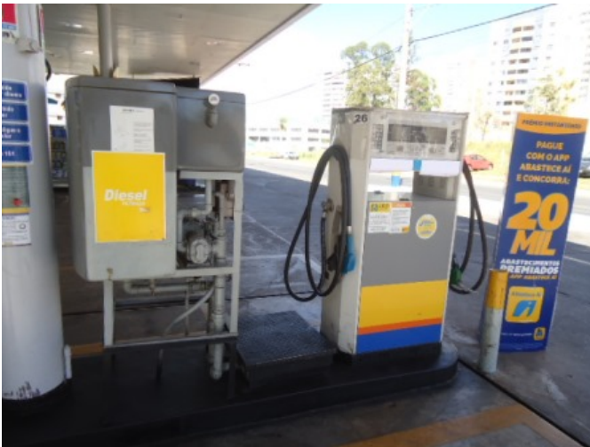
Foto 20: Unidade do Filtro do diesel filtrado e da bomba de abastecimento.
