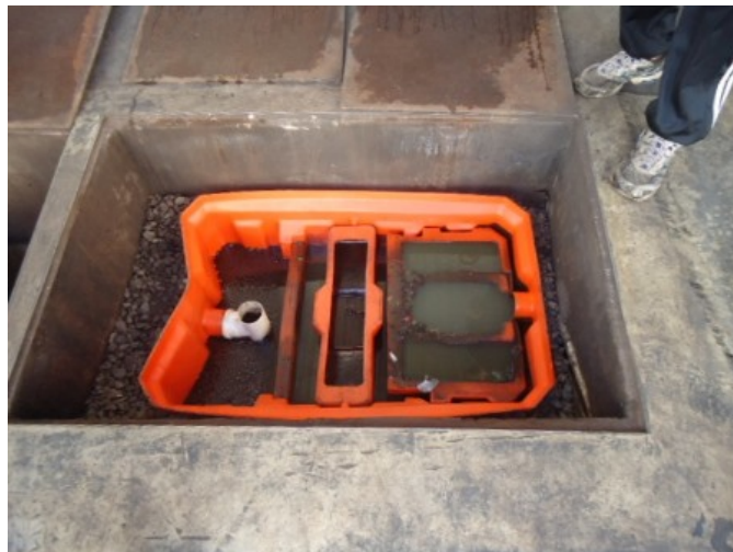
Foto 15: Caixa separadora de água e óleo - Área de Lavagem de Veículos. Modelo compacto onde a caixa de areia, separadora e caixa coletora se encontram dentro de um mesmo módulo.
