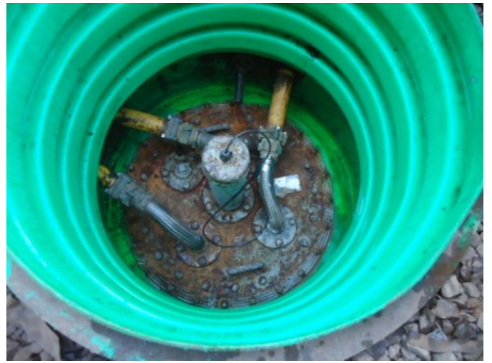
Foto 5: Acesso a boca de visita do tanque, com câmara de contenção.
