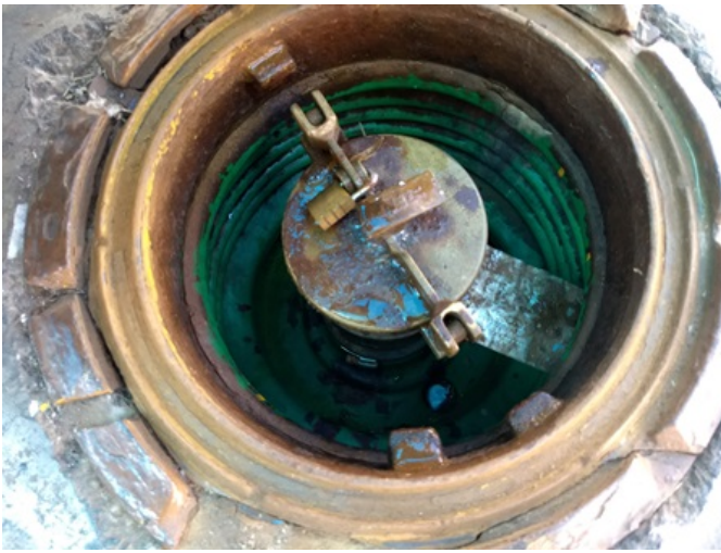
Foto 4: Descarga selada sobre o tanque com placa de válvula anti-transbordamento.
