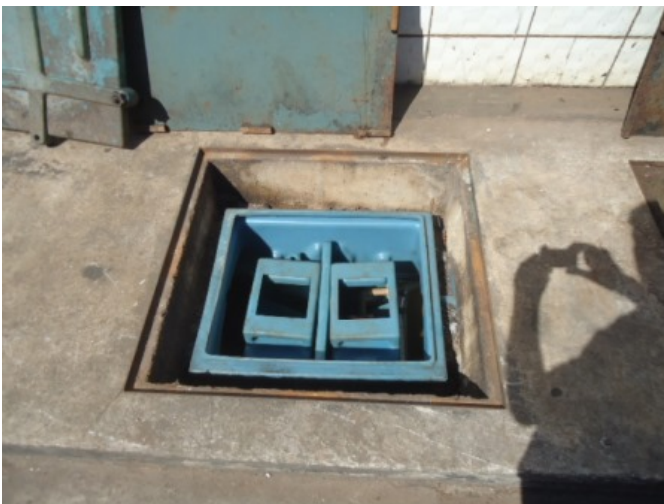
Foto 8: Sistema Separador de Água e Óleo da área das descargas seladas.
