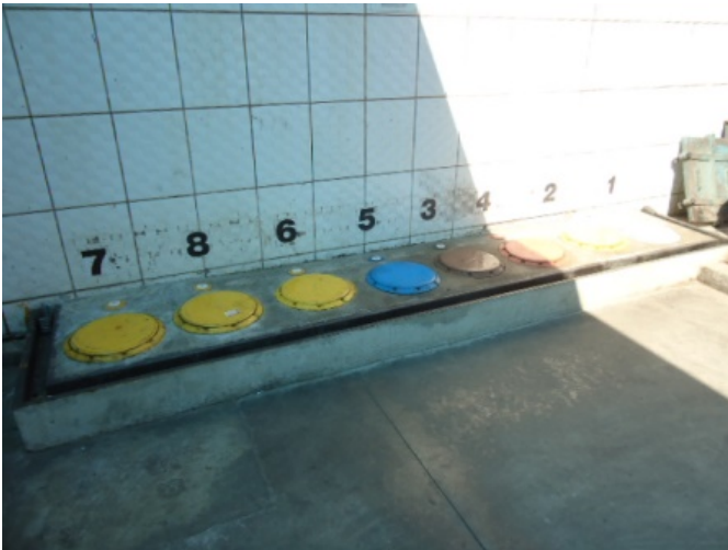
Foto 6: Descargas seladas à distância, circundadas por canaletas destinado ao SAO.
