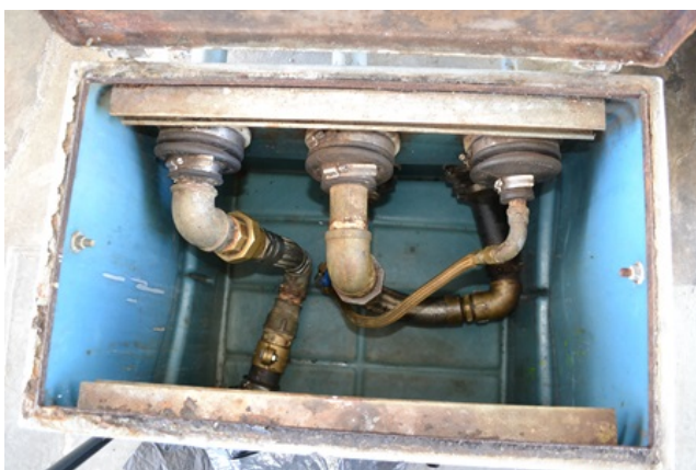
Foto 10: Câmara de contenção do filtro de diesel, observa-se boa manutenção.
