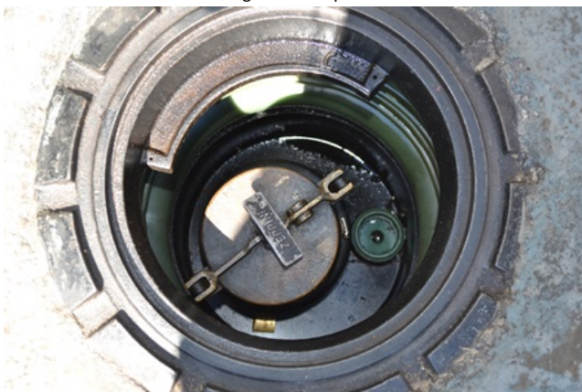
Foto 4: Descarga selada sobre o tanque, sem canaletes circundando a área.
