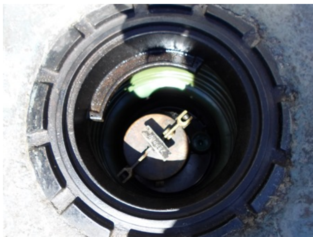
Foto 7: Detalhe da descarga selada à distância com boa manutenção.
