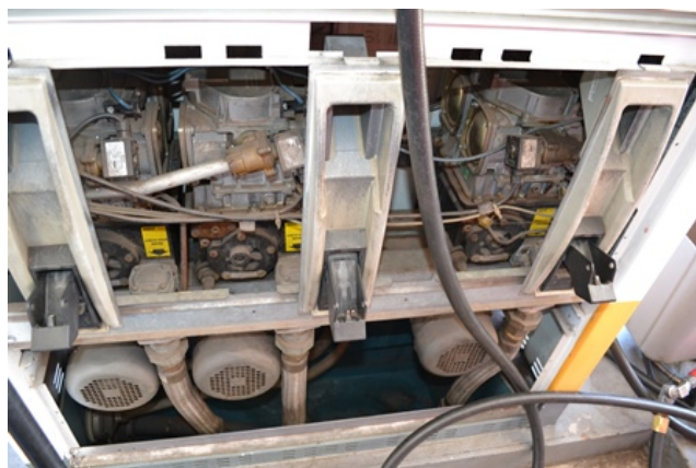
Foto 9: Câmara de contenção da unidade de abastecimento, observa-se que toda a tubulação que transporta combustível está contida dentro dos limites da câmara, check valve e boa manutenção do equipamento.
