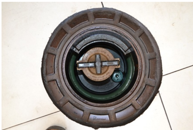
Foto 15: Boca de acesso sobre o tanque de OLUC subterrâneo localizado na área de lubrificação.
