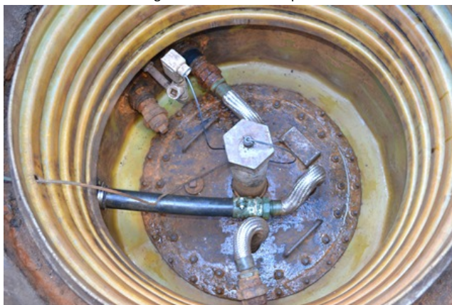
Foto 5: Acesso a boca de visita do tanque, com câmara de contenção.
