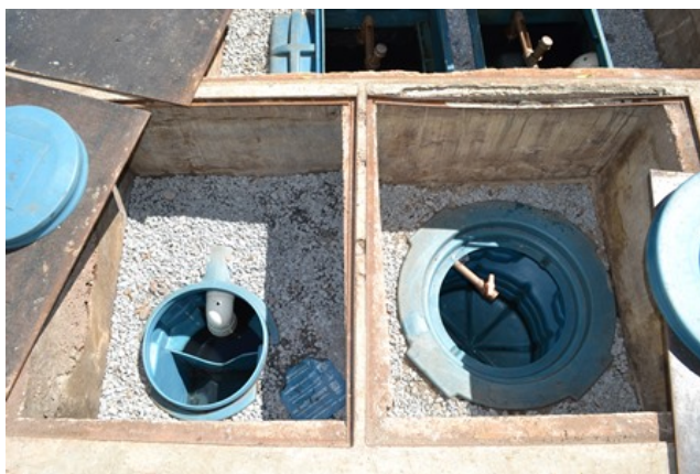
Foto 13: Módulo medidor de vazão com coleta de amostras e Módulo para coleta de óleo.
