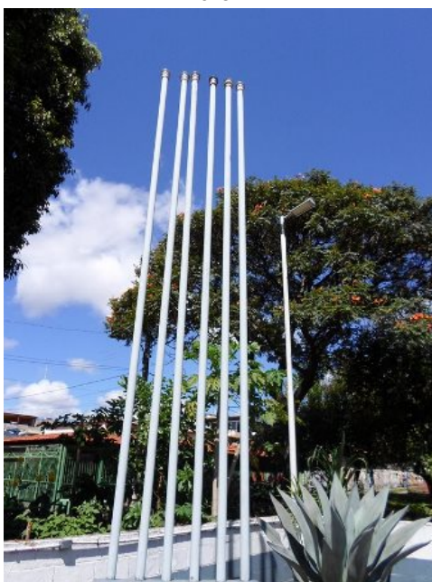
Foto 8: Respiros dos tanques, dotados de terminais corta-chamas.
