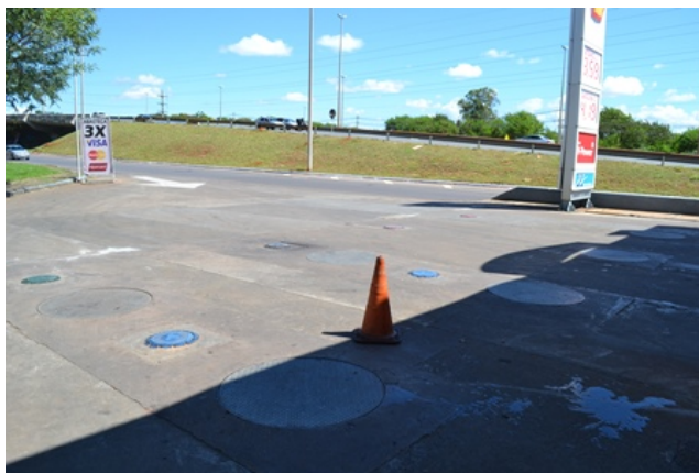
Foto 3: Área de tancagem localizada fora da pista de abastecimento.
