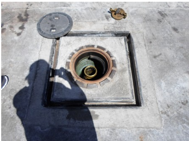
Foto 16: Boca de acesso externo para coleta do tanque de OLUC, circundado por canaletas direcionadas ao SAO.
