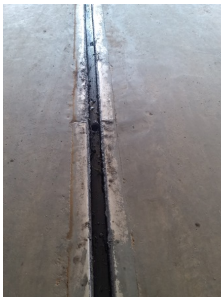
Figura 9 - Canaletos da pista de abastecimento desprovidos de manutenção (acúmulo de óleo).
