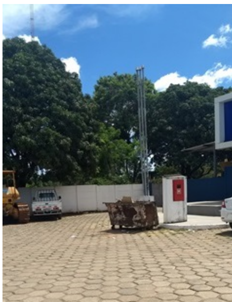
Figura 7 - Três respiros com terminais corta-chamas na outra extremidade do posto, totalizando 7 respiros.
