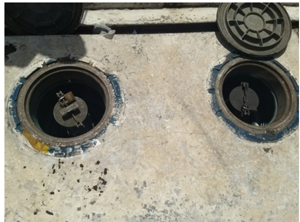
Figura 23 - Descarga selada à distância com câmara de contenção.
