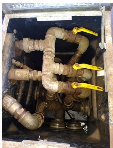
Figura 11 - Vista da bomba do diesel filtrado com check-valve e câmara de contenção.
