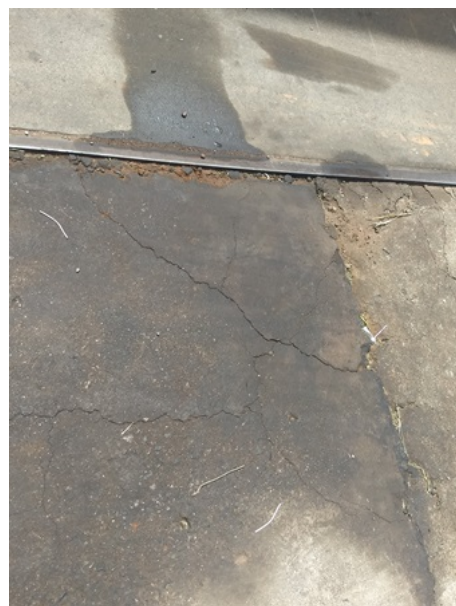
Figura 25 - Detalhe de manchas de diesel na área de abastecimento do posto.
