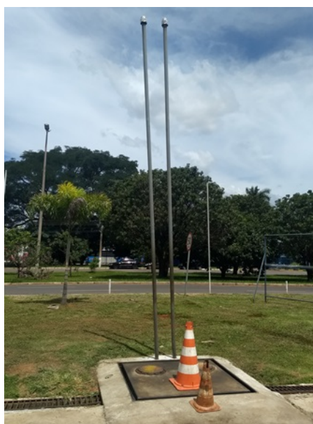
Figura 5 - Dois respiros com terminais corta-chamas. Descargas seladas à distância com os canaletos circundando a área.
