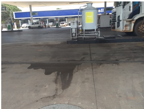
Figura 24 - Indícios de vazamento de diesel na área de abastecimento.
