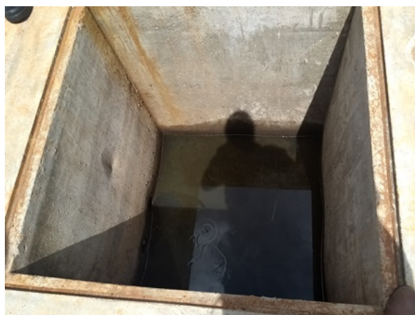
Figura 19 - Interior da caixa de areia do SAO da área de abastecimento.
