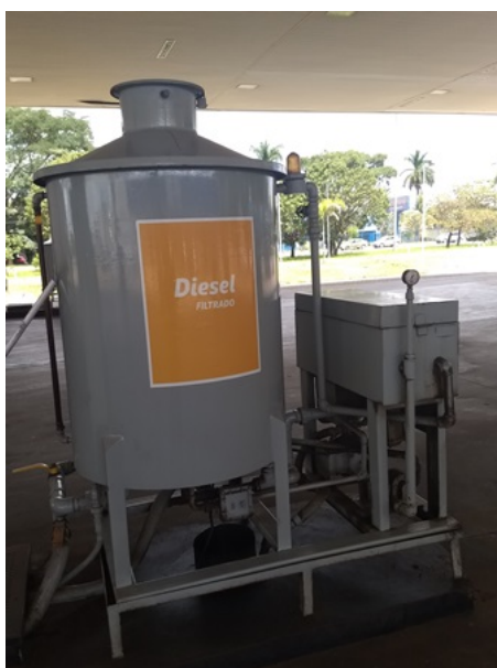
Figura 10 - Unidade de filtração de diesel em área dentro da pista de abastecimento, em ambiente coberto e circundado por canaletos.
