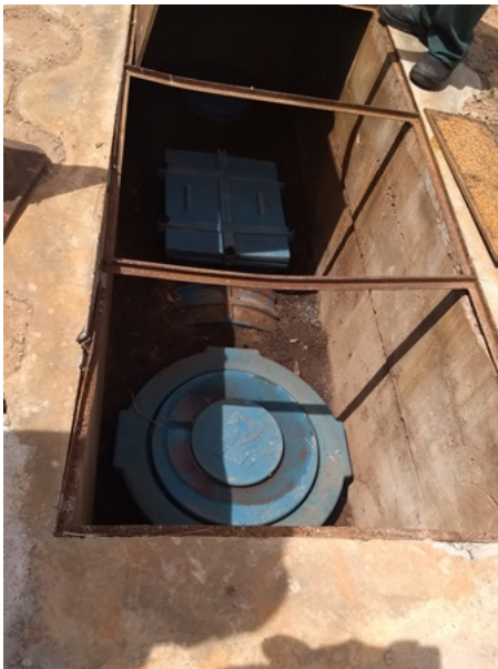
Figura 20 - Sistema Separador de Água e Óleo - SAO da pista de abastecimento com as tampas de acesso amassadas.
