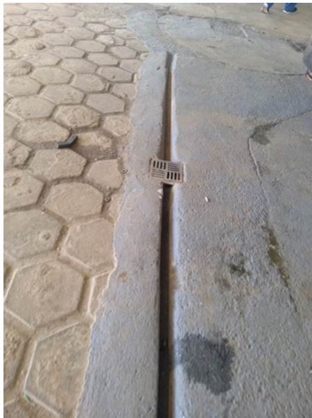
Figura 38 - Área interna do pátio sem canaletas abrangendo totalmente a localidade.
