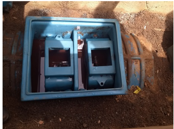
Figura 21 - Sistema Separador de Água e Óleo - SAO da área de abastecimento, fabricação de PEAD.
