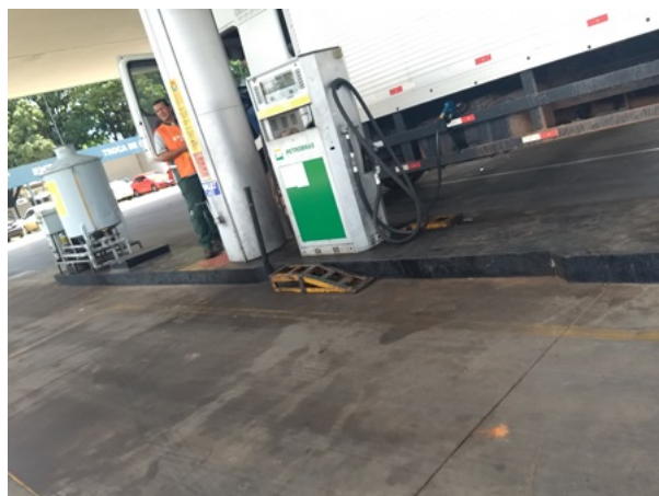
Figura 12 - Vista da bomba abastecedora com dois bicos injetores.
