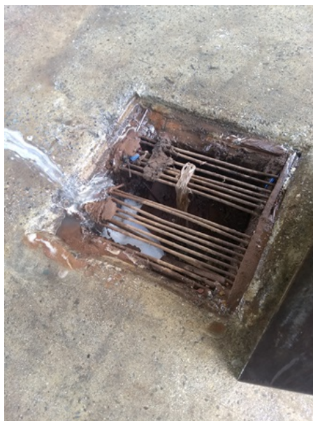
Figura 37 - Detalhe da caixa de areia central da área de lavagem de veículos do pátio interno do posto.
