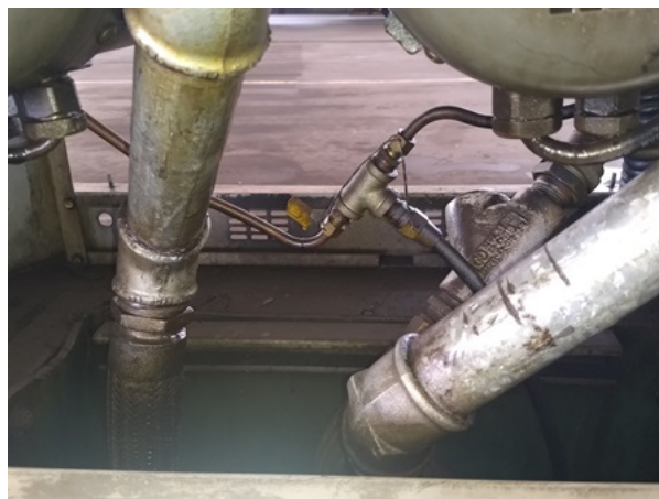
Figura 13 - Vista da bomba com câmara de contenção e check-valve instalado. Com indícios de vazamento.
