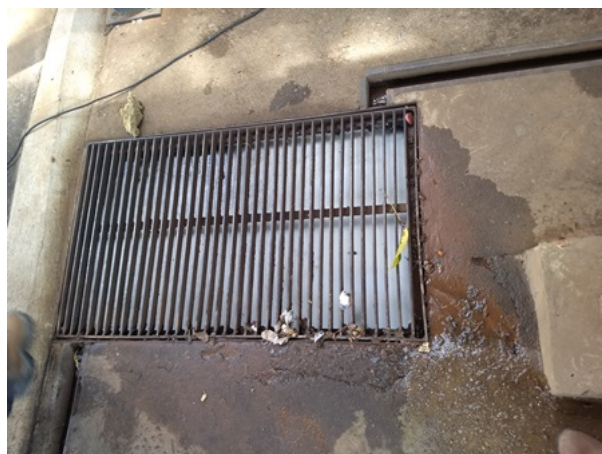
Figura 28 - Caixa de areia localizada na lateral da área de lavagem dos veículos
