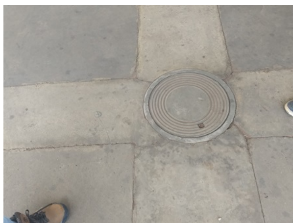
Figura 17 - Uma das caixas de passagens localizadas na pista de abastecimento.
