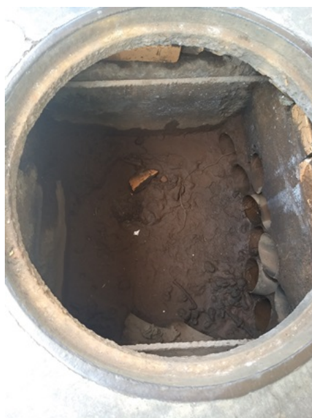
Figura 18 - Interior da caixa de passagem localizada inadequadamente na pista de abastecimento.
