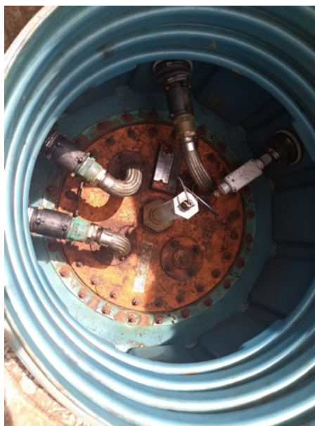
Figura 3 - Boca de visita de um dos tanques com câmara de contenção e monitoramento intersticial.
