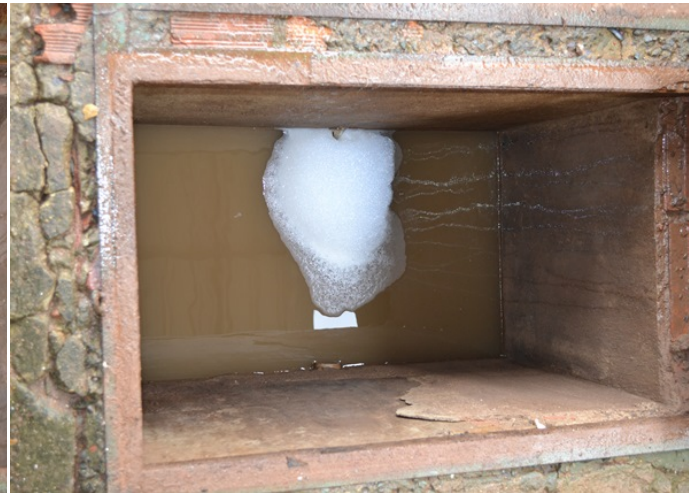
Foto 26. Caixa de amostragem do SAO da área de lavagem de veículos.
