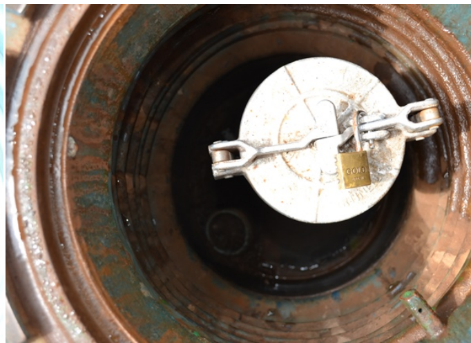
Foto 14. Detalhe da descarga selada do tanque de OLUC.
