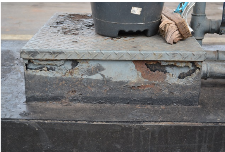
Foto 8. Câmara de contenção do filtro de diesel. Observa-se a deterioração do compartimento da Câmara de contenção do filtro de Diesel.
