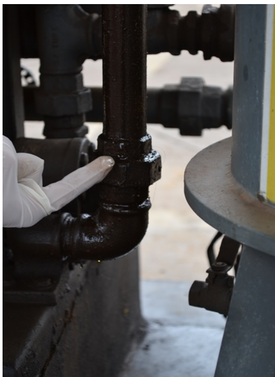
Foto 10. Detalhe do filtro de diesel com indícios de vazamento.
