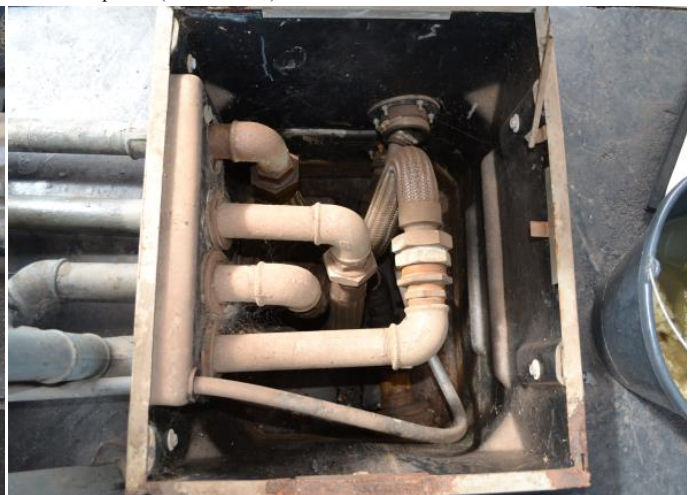
Foto 9. Sump do filtro de diesel sem manutenção periódica.
