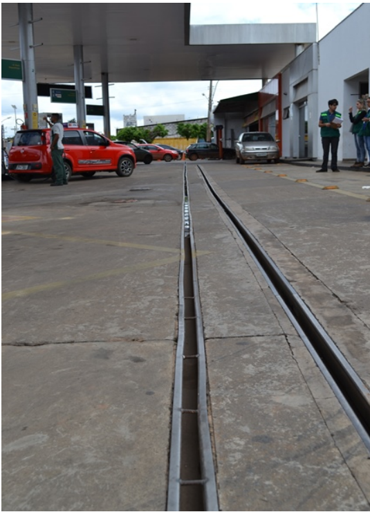
Foto 4. Canaletas amassadas da pista de abastecimento.
