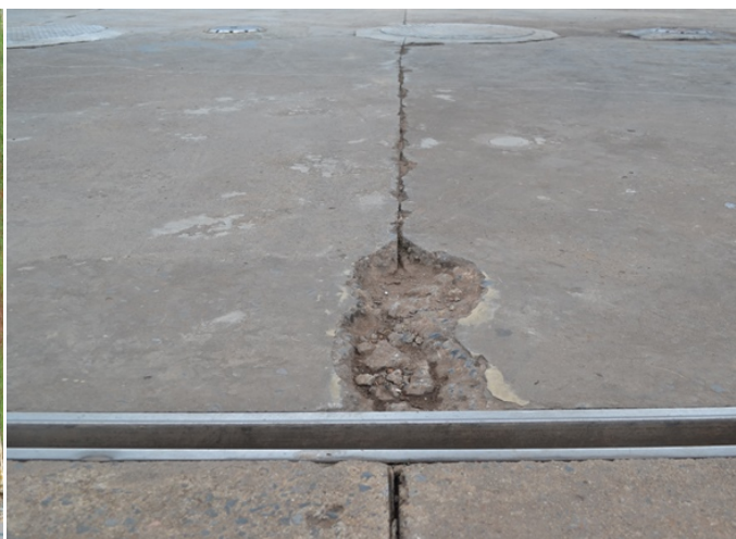
Foto 3. Detalhe das rachaduras da pista de abastecimento.
