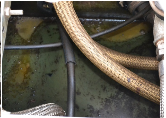
Foto 7. Câmara de contenção sem manutenção periódica. Observa-se a presença de resíduos líquidos (combustível).
