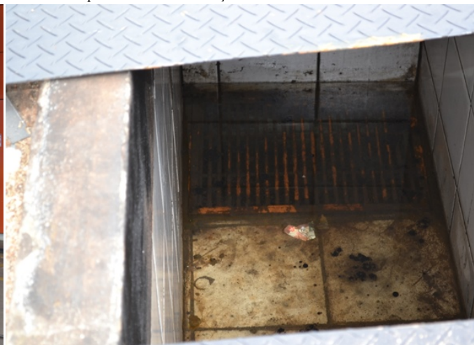
Foto 22. Vala desativada sem manutenção adequada.
