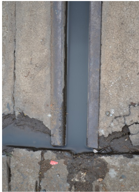
Foto 5. Detalhe do canaleta da drenagem pluvial sem saída.
