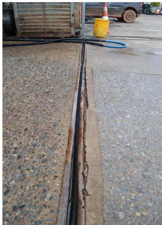
Foto 18. Detalhe dos canaletos deformados e com rachaduras ao redor na parte esquerda
