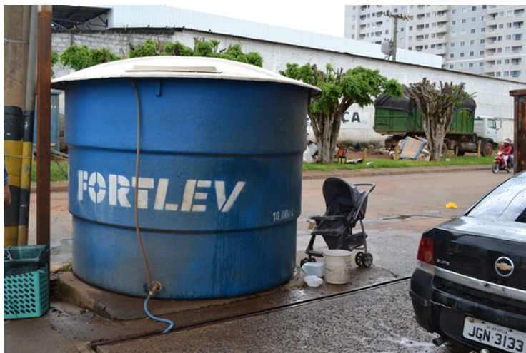
Foto 19. Detalhe dos resíduos escoando para a área externa do posto.
