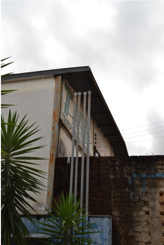
Foto 15. Respiros em local inadequado.
