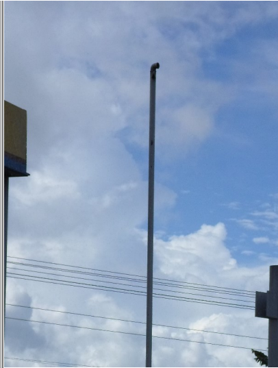
Figura 7 - Apenas um respiro com curvatura na ponta sem o terminal c
