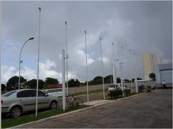
Figura 6 - Respiros dos tanques com os oito terminais corta chamas livre de obstrução.
