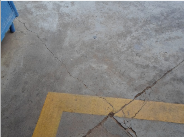
Figura 8 - Detalhe do piso da pista de abastecimento com rachaduras.
