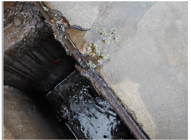
Figura 19 - Rachadura na abertura do SAO propicia entrada da drenagem
