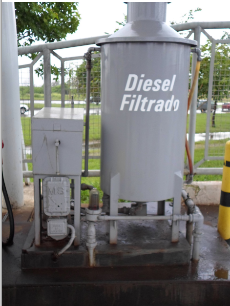
Figura 10 - Unidade de filtração de diesel em área fora da pista de abastecimento, mas em ambiente coberto e circundado por canaletas.
