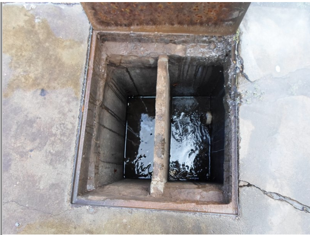
Figura 18 - Sistema Separador de Água e Óleo - SAO está em inconformidade com os padrões da CAESB.
