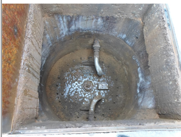
Figura 4 - Boca de visita de um dos tanques sem câmara de contenção.
