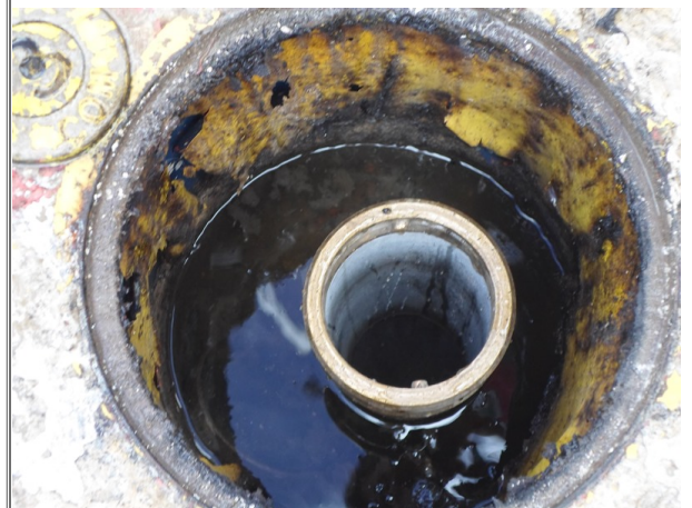
Figura 21 - Descarga selada com câmara de contenção danificada e cor no seu interior.
