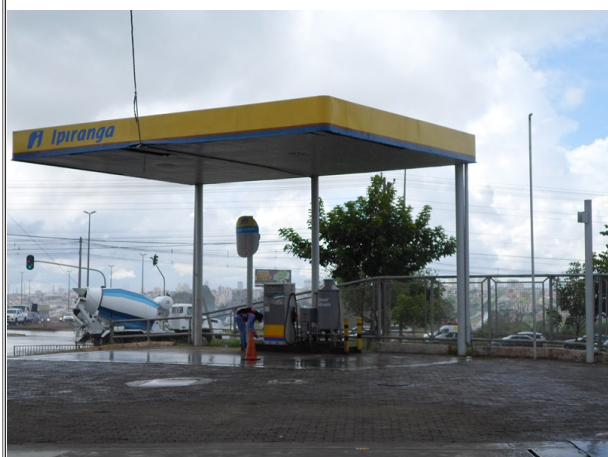
Figura 14 - Unidade de Diesel Filtrado com suspiro, canaletas circundando a área e piso impermeabilizado.
