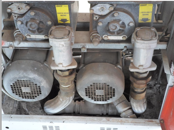
Figura 11 - Vista de bomba de abastecimento com check-valve sem cân
