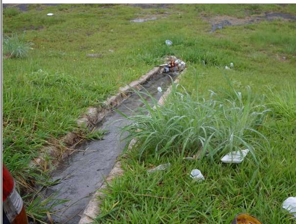
Figura 22 - Drenagem pluvial direcionada para a área verde adjacente ao Posto.
