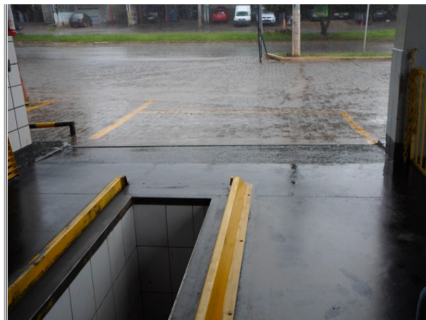
Figura 13 - Área de lubrificação com canaletas na entrada.
