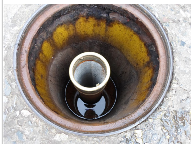
Figura 5 - Descarga selada sem câmara de contenção.
