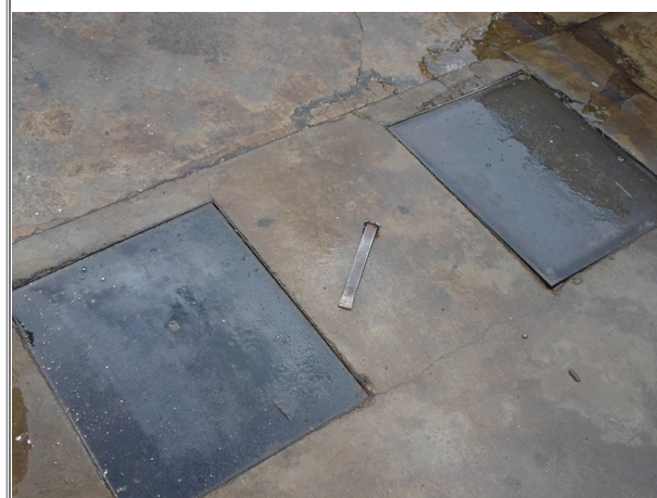
Figura 17 - Sistema Separador de Água e Óleo - SAO da pista de abastecimento e descarga a distância.
