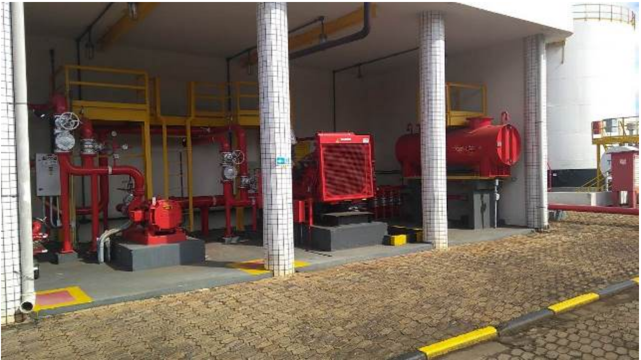
Foto 6 – Unidade de bombas da central de combate a incêndios
