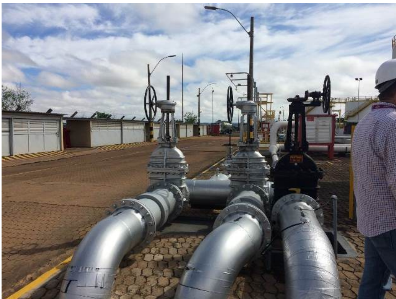
Foto 5 – Ponto de ligação entre o Pool e a rede de hidrantes de querosene do aeroporto de Brasília
