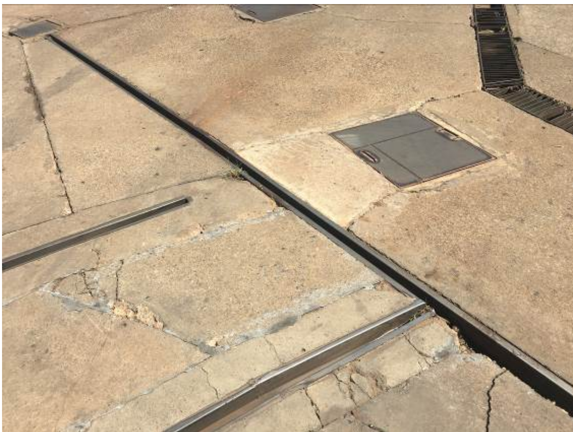
Figura 12 - Canaletes fora do padrão exigido pela norma vigente.
