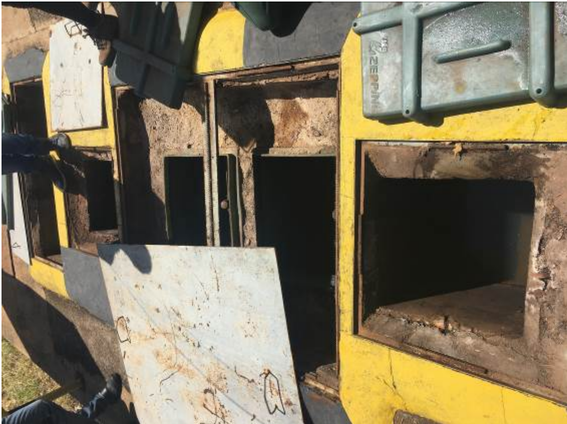
Figura 11 - Sistema separador de água e óleo (SAO) da pista de abastecimento e da área de lubrificação.
