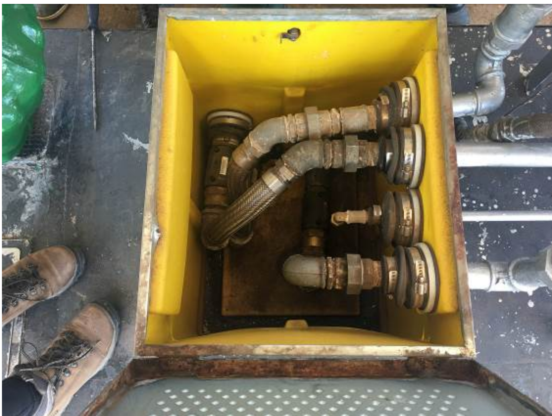
Figura 7 - Câmara de contenção da unidade de filtragem de diesel.
