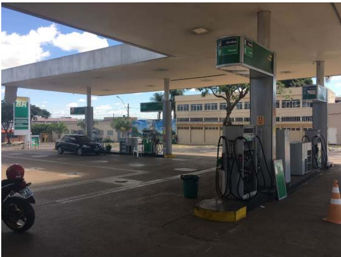
Figura 3 - Área de abastecimento com piso impermeável e com rachaduras.
