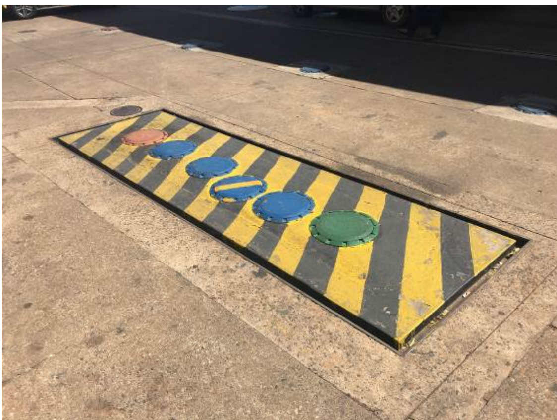
Figura 5 - Descargas seladas à distância, circundadas por canaletes.
