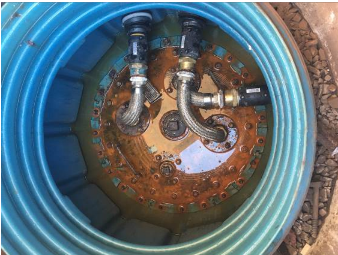
Figura 2 - Bacia de contenção do Tanque evidenciando a ausência de manutenção periódica
