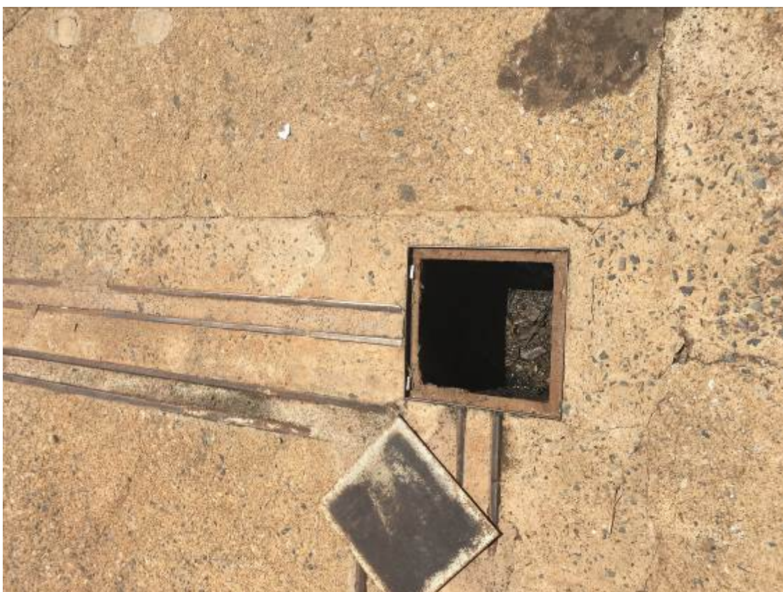
Figura 13 - Caixa de passagem de óleo intupida, impedindo a passagem e evidenciando a falta de manutenção.
