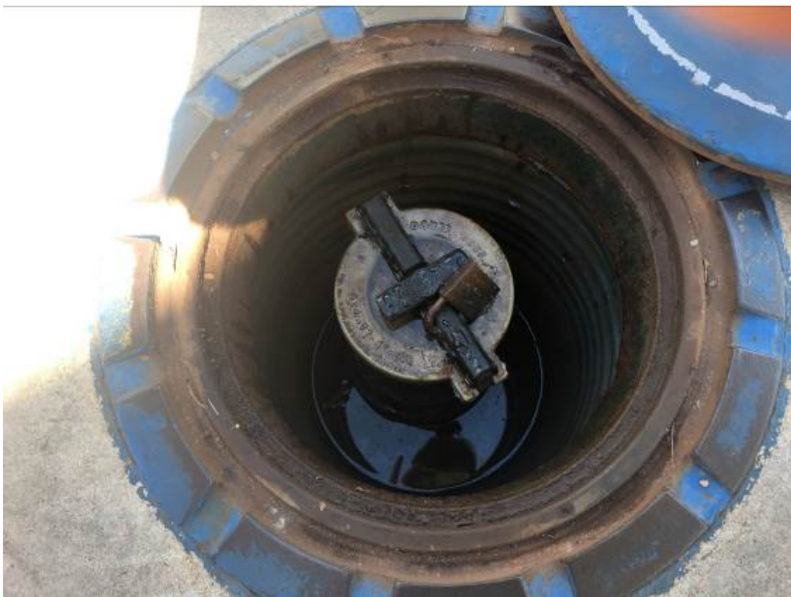
Figura 4 - Descarga selada à distância com acúmulo de água e substância oleosa, evidenciando a ausência de manutenção.
