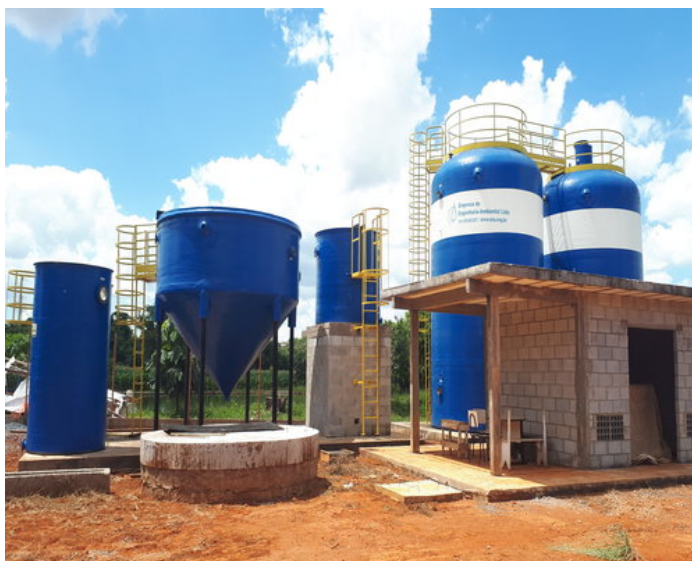
Figura 1 - Vista geral das unidades de tratamento da ETE.
